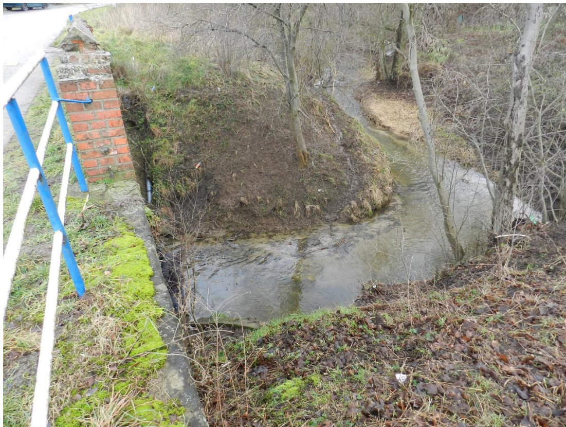
Fot. 24. Erozja skarp.
