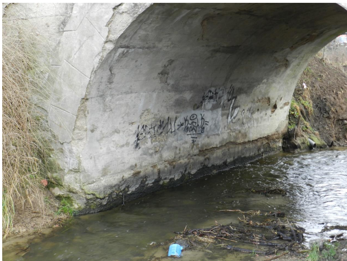
Fot. 11. Erozja podpory północnej.
