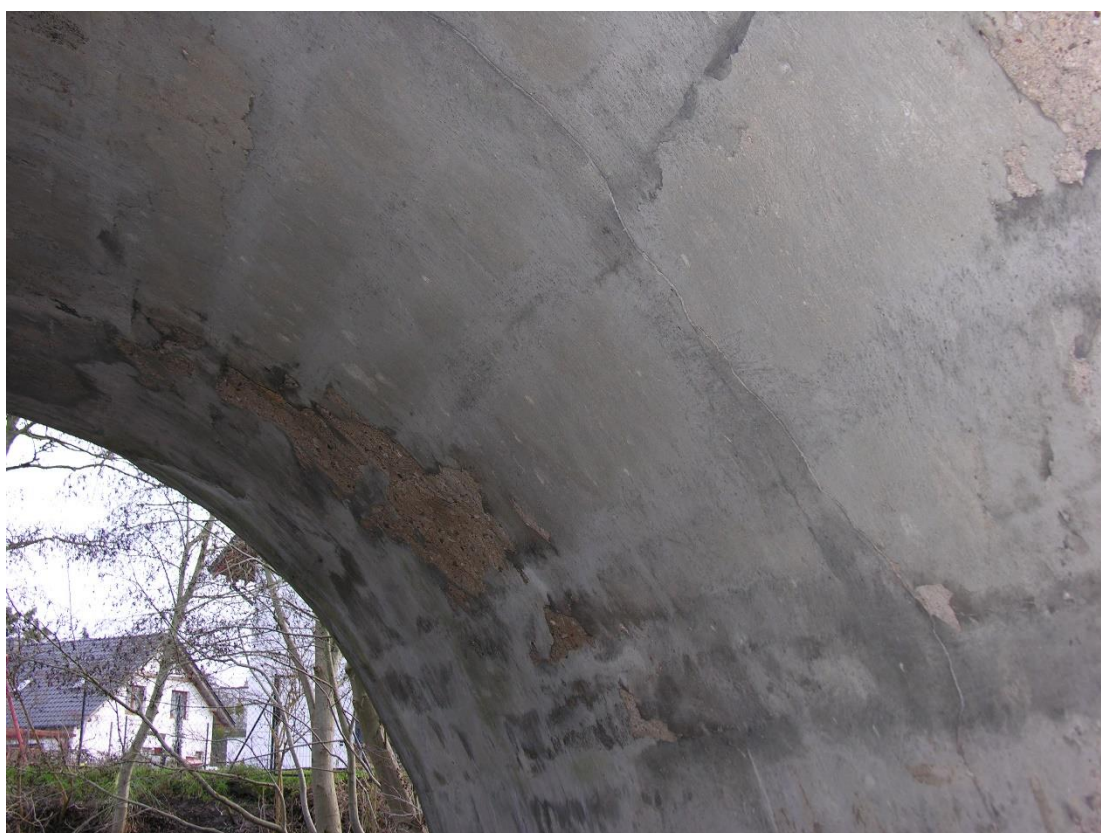
Fot. 15. Uszkodzenia sklepienia. Pęknięcie w osi obiektu. Złuszczenie mleczka cementowego.
