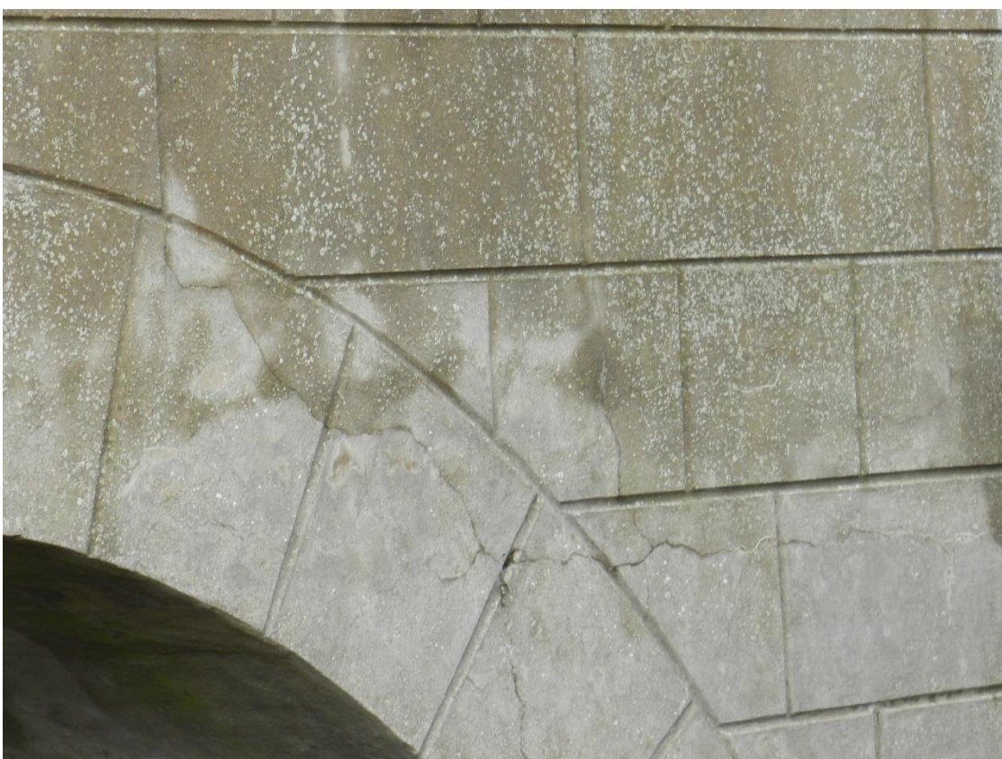
Fot. 9. Pęknięcia powłoki elewacyjnej. Wegetacja porostów.
