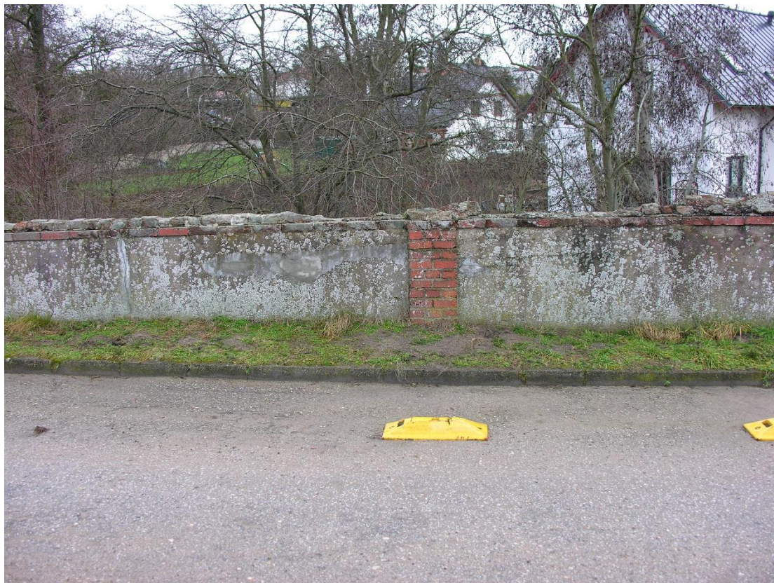
Fot. 20. Ubytki betonu w rejonie zwieńczenia balustrady. Wegetacja roślinna.
