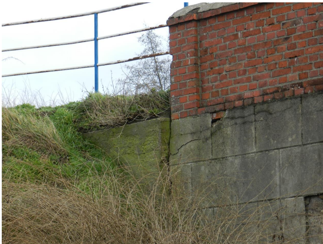
Fot. 18. Przesunięcie poziome murka betonowego.
