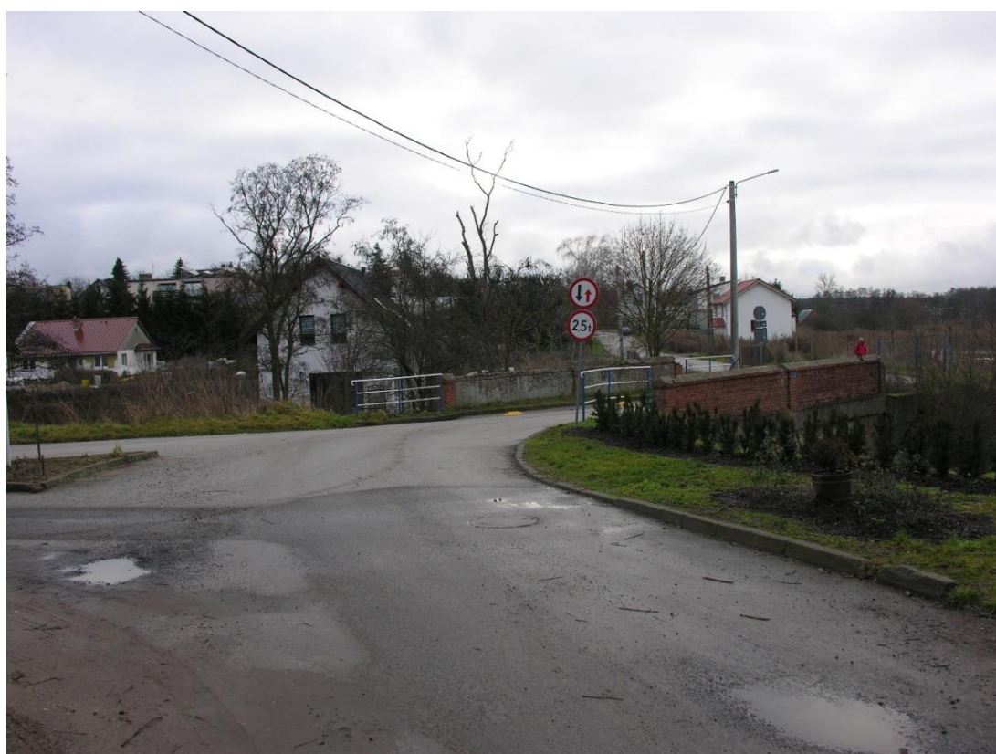
Fot. 3. Zachodni wlot z ulicy Łąkowej. Ubytki i zanieczyszczenie nawierzchni.
