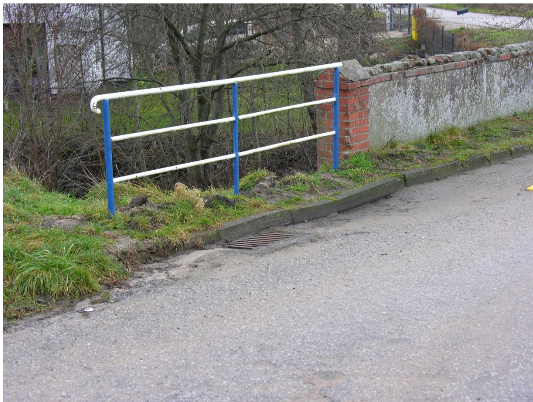
Fot. 1. Zapadnięta nawierzchnia w rejonie wpustu.
