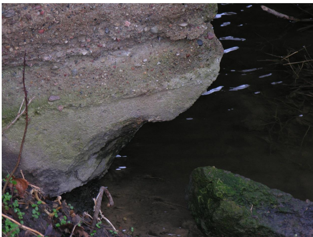
Fot. 13. Erozja naroża podpory południowej.
