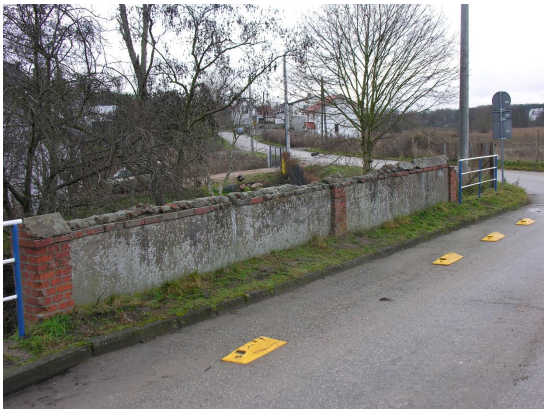
Fot. 2. Erozja nawierzchni w rejonie wschodniego krawężnika.
