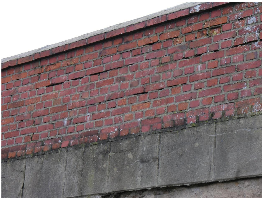
Fot. 21. Pęknięcia muru. Ubytki spoin.
