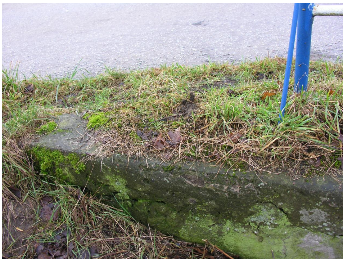
Fot. 17. Uszkodzenia murków betonowych.
