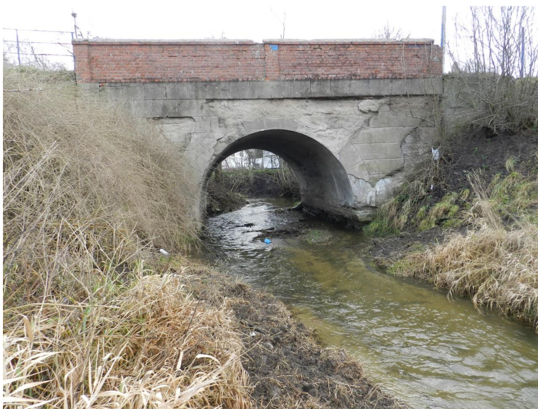
Fot. 5. Ubytki betonu i powłoki elewacyjnej na ścianie od strony dolnej wody.
