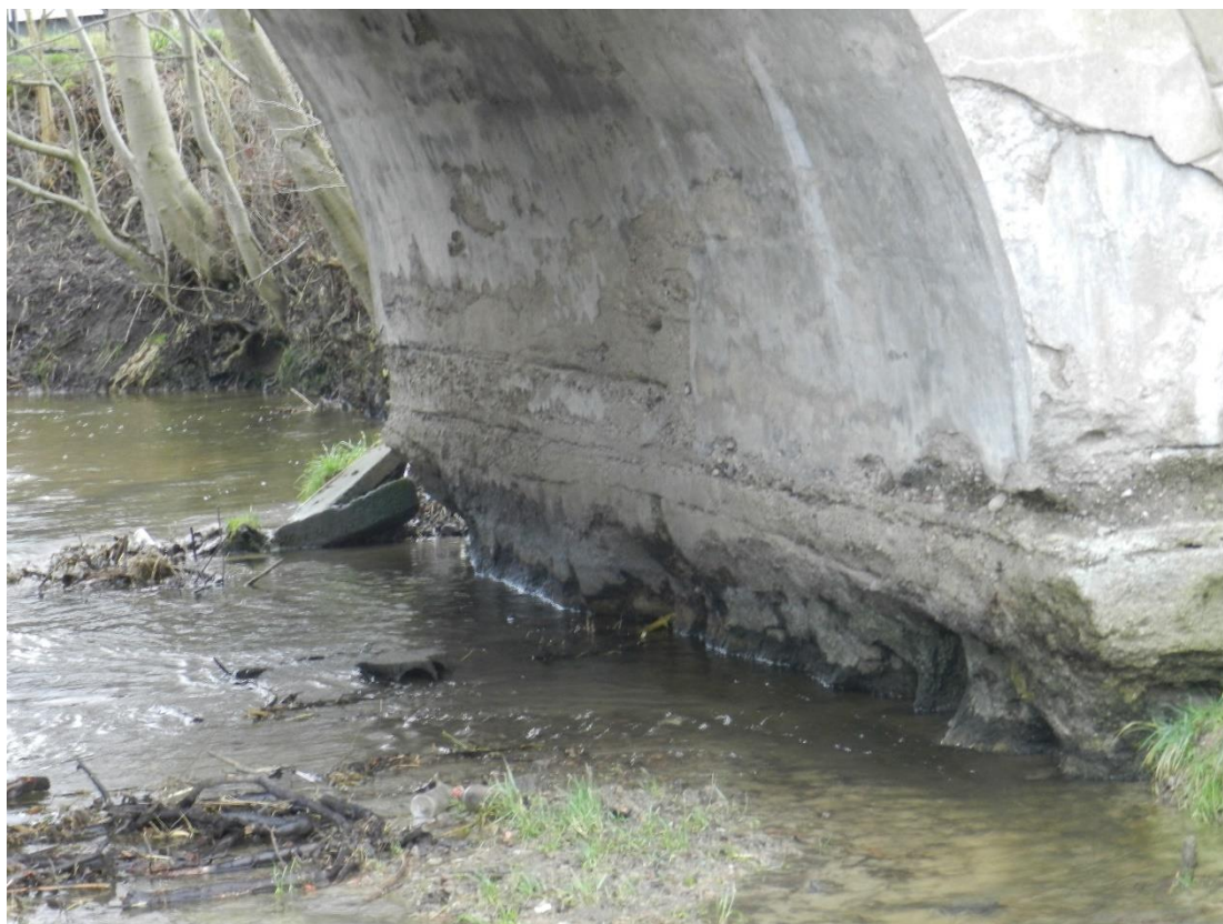
Fot. 12. Erozja podpory południowej.
