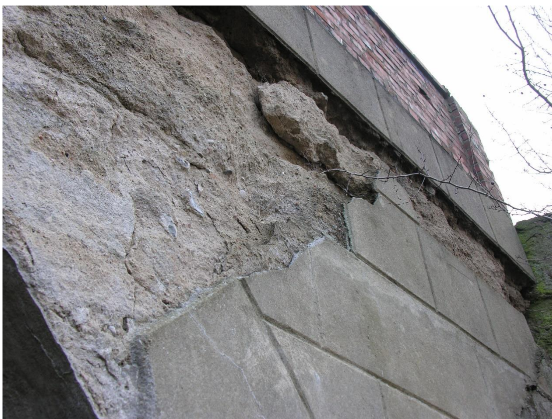
Fot. 7. Ubytki betonu na ścianie bocznej.
