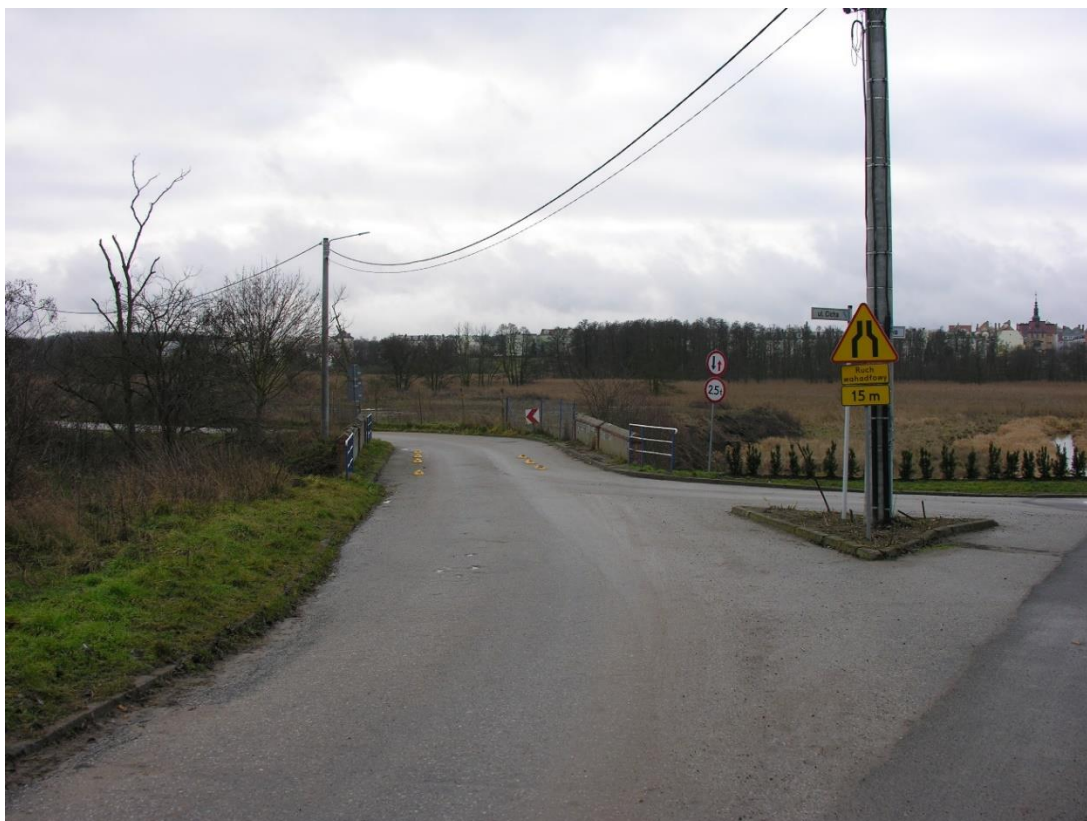
Fot. 4. Północny wlot z ulicy Cichej. Ubytki i zapadnięcie nawierzchni.
