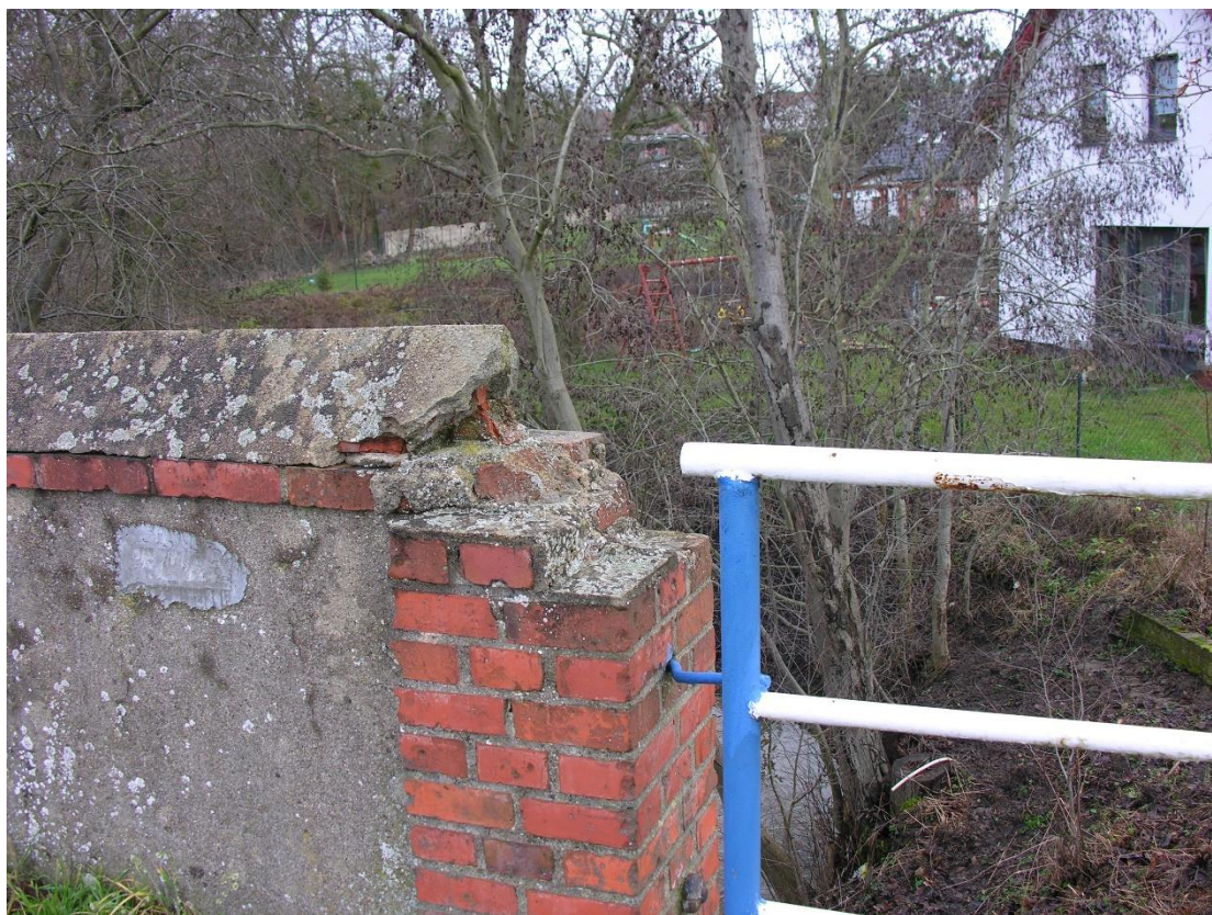
Fot. 22. Ubytek cegieł na słupku balustrady.
