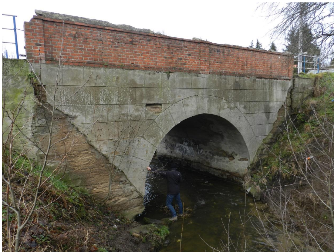
Fot. 6. Ubytki betonu i powłoki elewacyjnej na ścianie od strony górnej wody.
