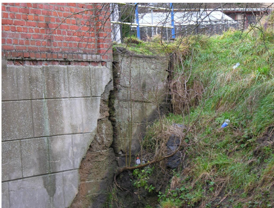
Fot. 25. Erozja skarpy w okolicy wpustu.
