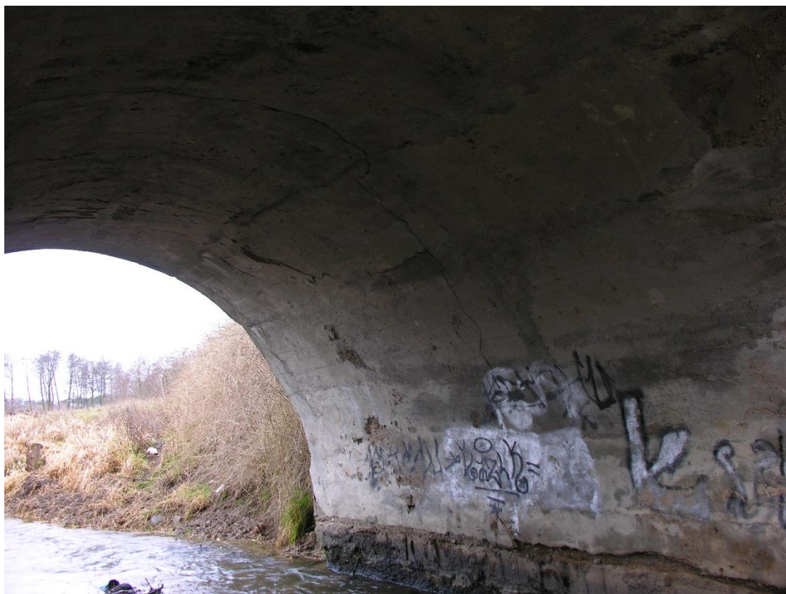
Fot. 14. Uszkodzenia sklepienia. Pęknięcie w osi obiektu.
