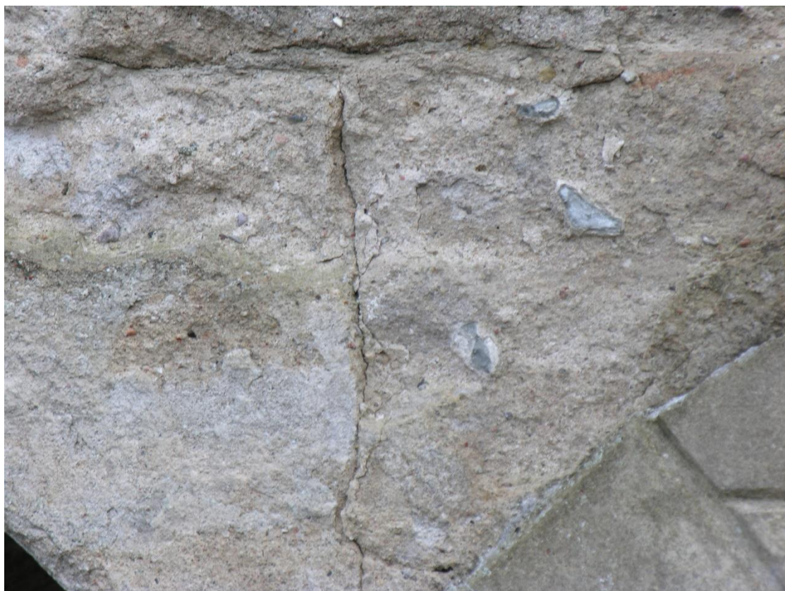
Fot. 8. Pęknięcia betonu na ścianie bocznej.
