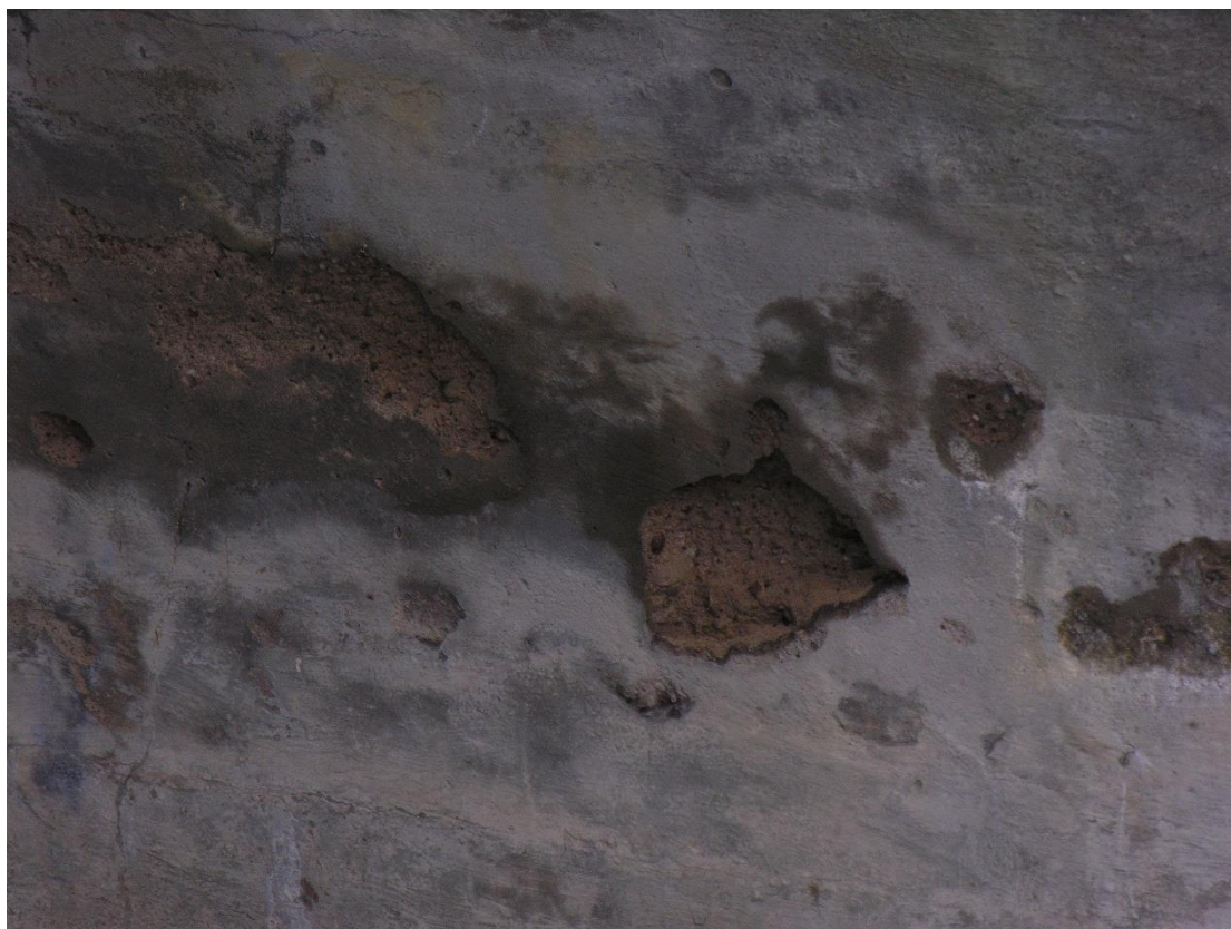
Fot. 16. Uszkodzenia sklepienia. Ubytki betonu w rejonie północno-wschodniej części sklepienia.
