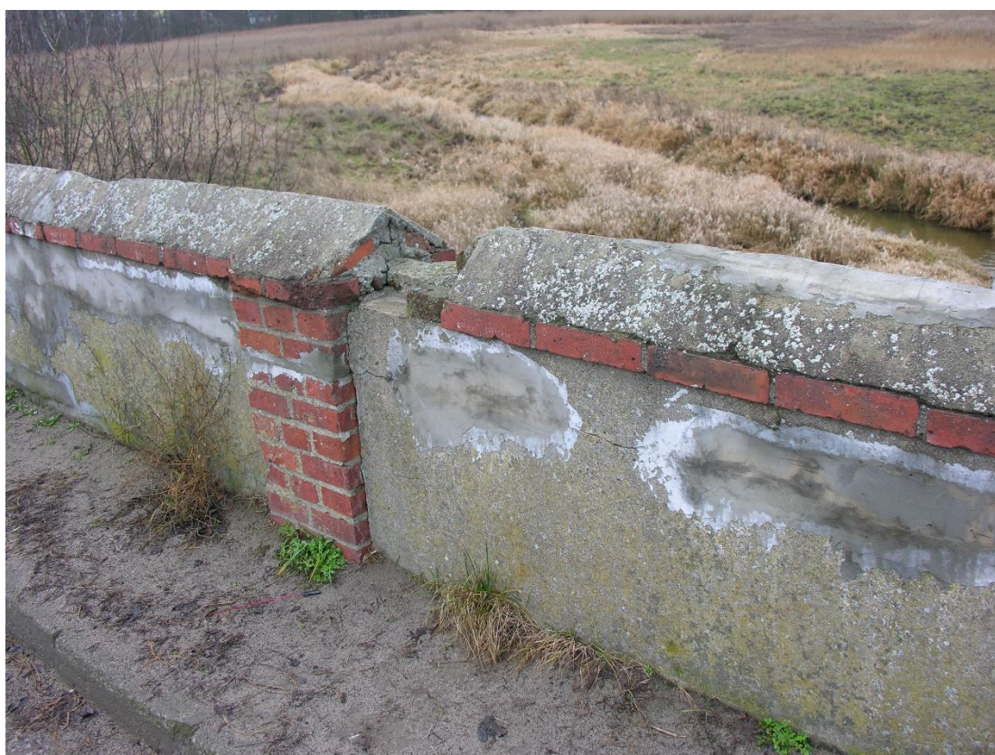
Fot. 19. Pęknięcia balustrady. Naprawa pęknięć zaprawą cementową.
