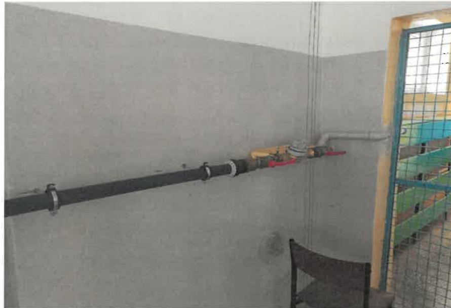
Rysunek 1 WIDOK NA KONSOLĘ WODOMIERZOWĄ W POMIESZCZENIU PIWNICZNYM BUDYNKU SZKOŁY
