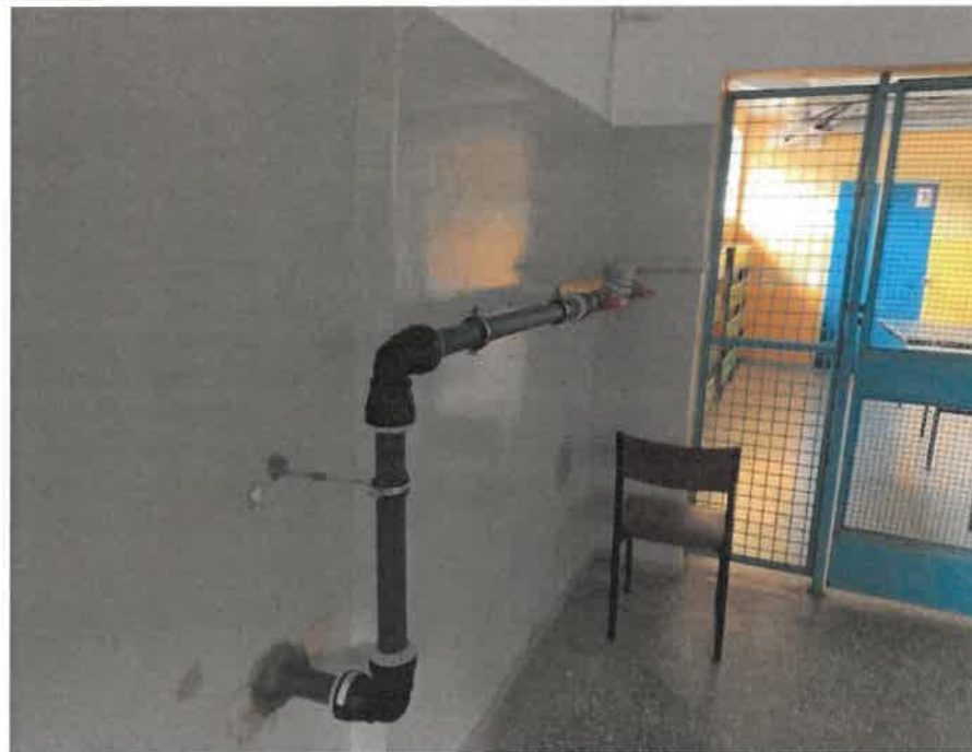
Rysunek 1 WIDOK NA KONSOLĘ WODOMIERZOWĄ I PRZEJŚCIE PRZEZ ŚCIANĘ FUNDAMNETOWĄ W POMIESZCZENIU PIWNICZNYM BUDYNKU SZKOŁY
