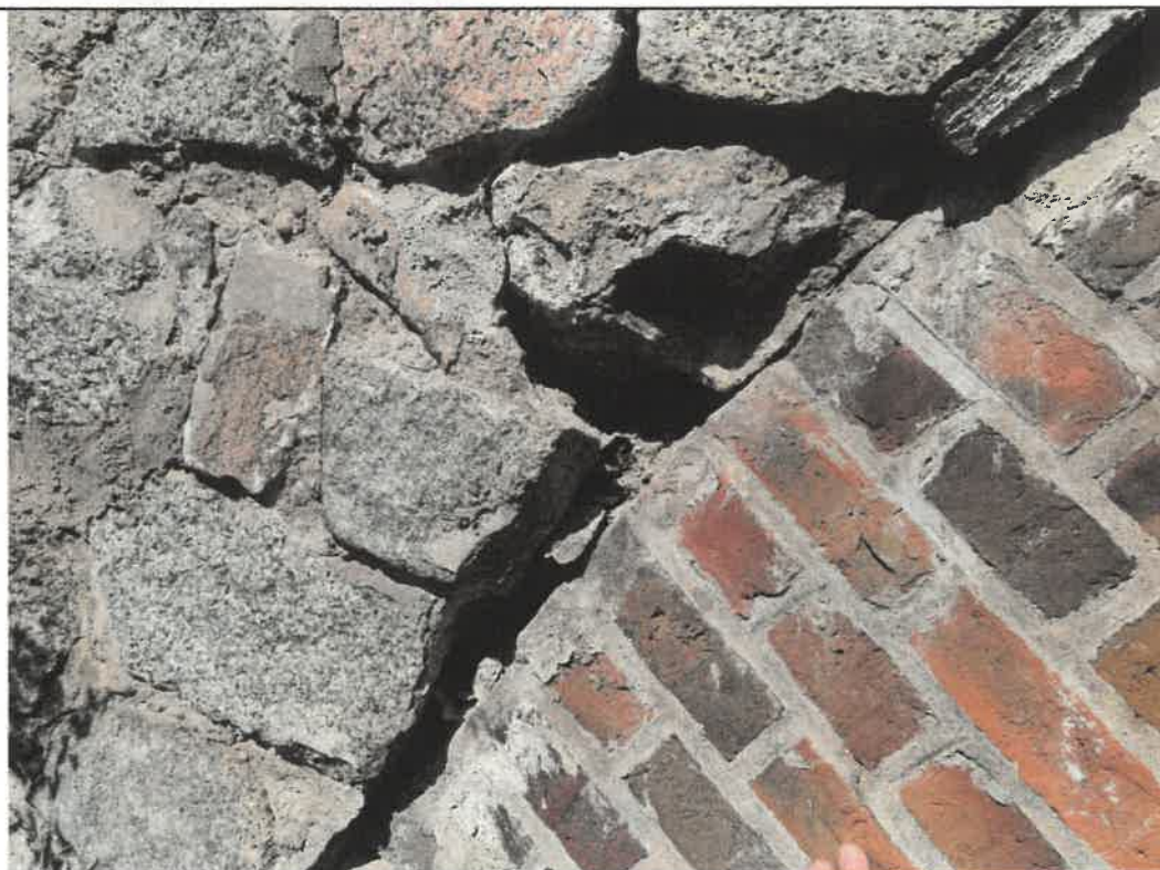
Fot. 4 Ubytki spoinowania ściany pomostowej
