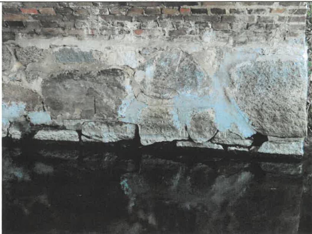
Fot. 3 Ubytki spoinowania ściany przyczółka
