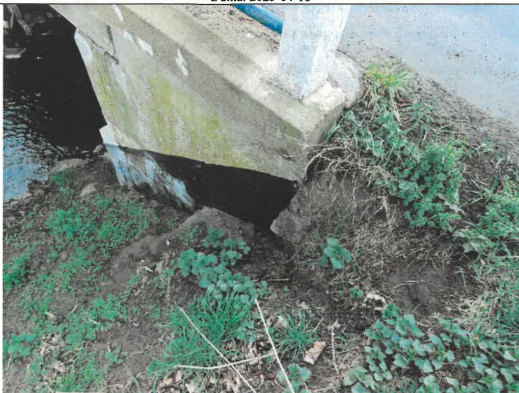
Fot. 3 uszkodzenia skarpy nasypu
