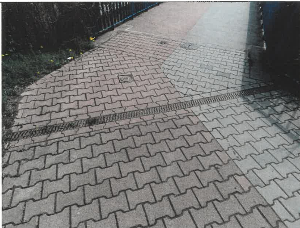
Fot. 4 Zanieczyszczenia odpływu liniowego na dojeździe do obiektu
