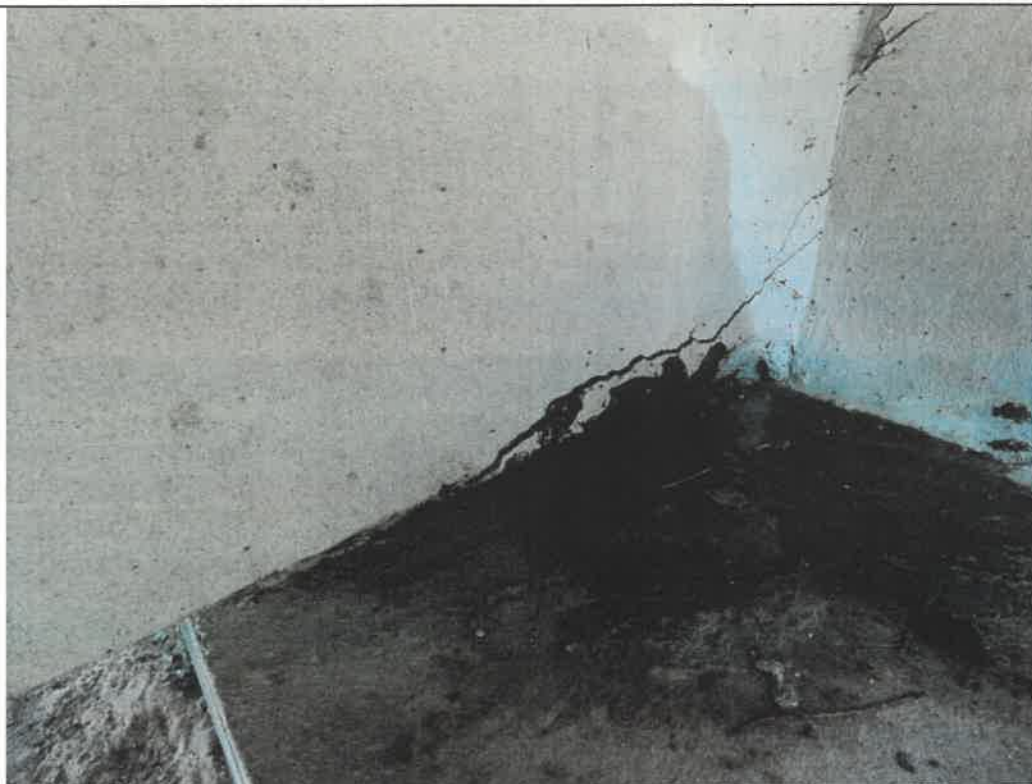
Fot. 3 Lokalne zarysowanie na dźwigarze
