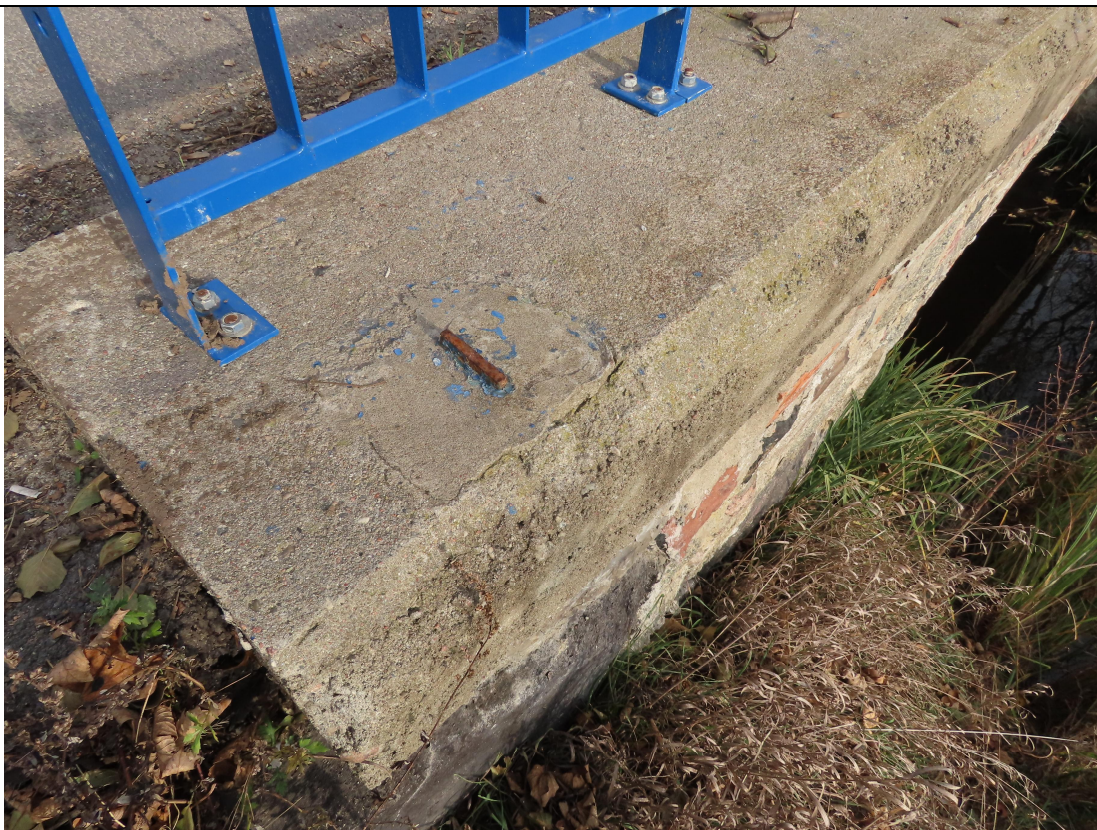
Fot. 2 Brak zabezpieczenia antykorozyjnego pozostałości po „starych” słupkach balustrady
