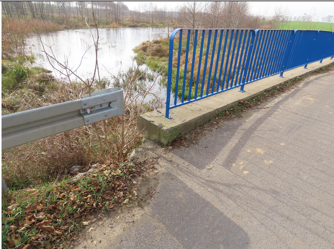
Fot. 1 Brak ciągłości pomiędzy balustradą a barierą drogową
