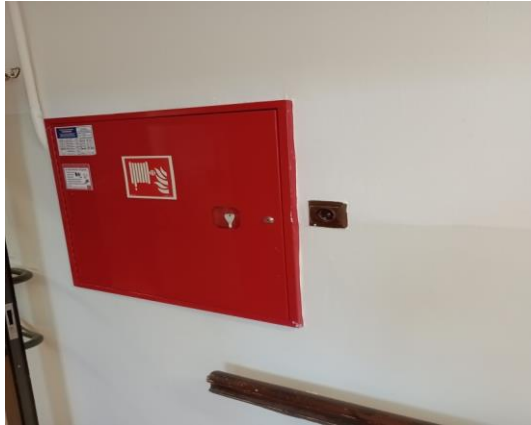
ZDJĘCIE 14 ZAKUP I WYMIANA HYDRANTÓW WEWNĘTRZNYCH. ŹRÓDŁO: DPS KRASNYSTAW
