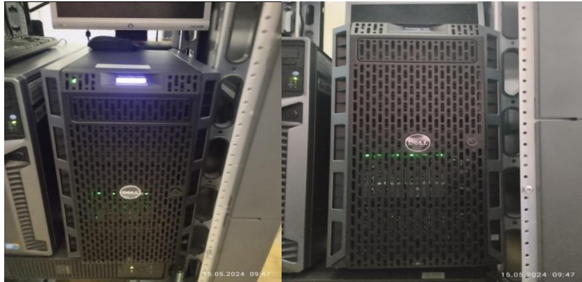
ZDJĘCIE 15 SERWEROWNIA W DPS W SURHOWIE. ŹRÓDŁO: DPS W SURHOWIE.
