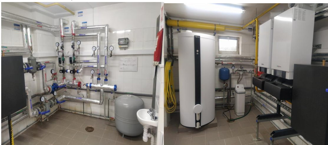
ZDJĘCIE 25 KOTŁOWNIA DPS KRASNYSTAW FILIA OSTRÓW KRUPSKI. ŹRÓDŁO: DPS W KRASNYMSTAWIE.
