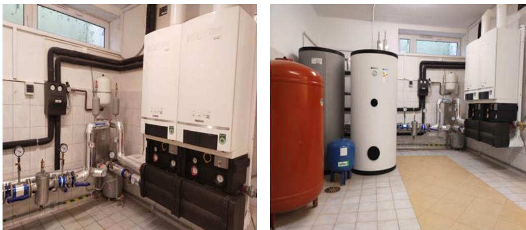
Zdjęcie 31Kotłownia w CAPO-W w Krasnymstawie. Źródło: CAPO-W w Krasnymstawie.
