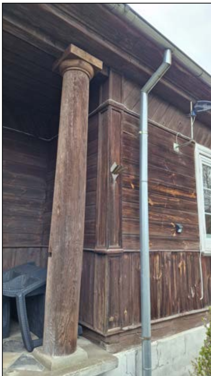
Fot 11: Plebania, Parafia Rzymskokatolicka pw. Św. Jana Apostoła w Nurze; stan obiektu przed konserwacją.
