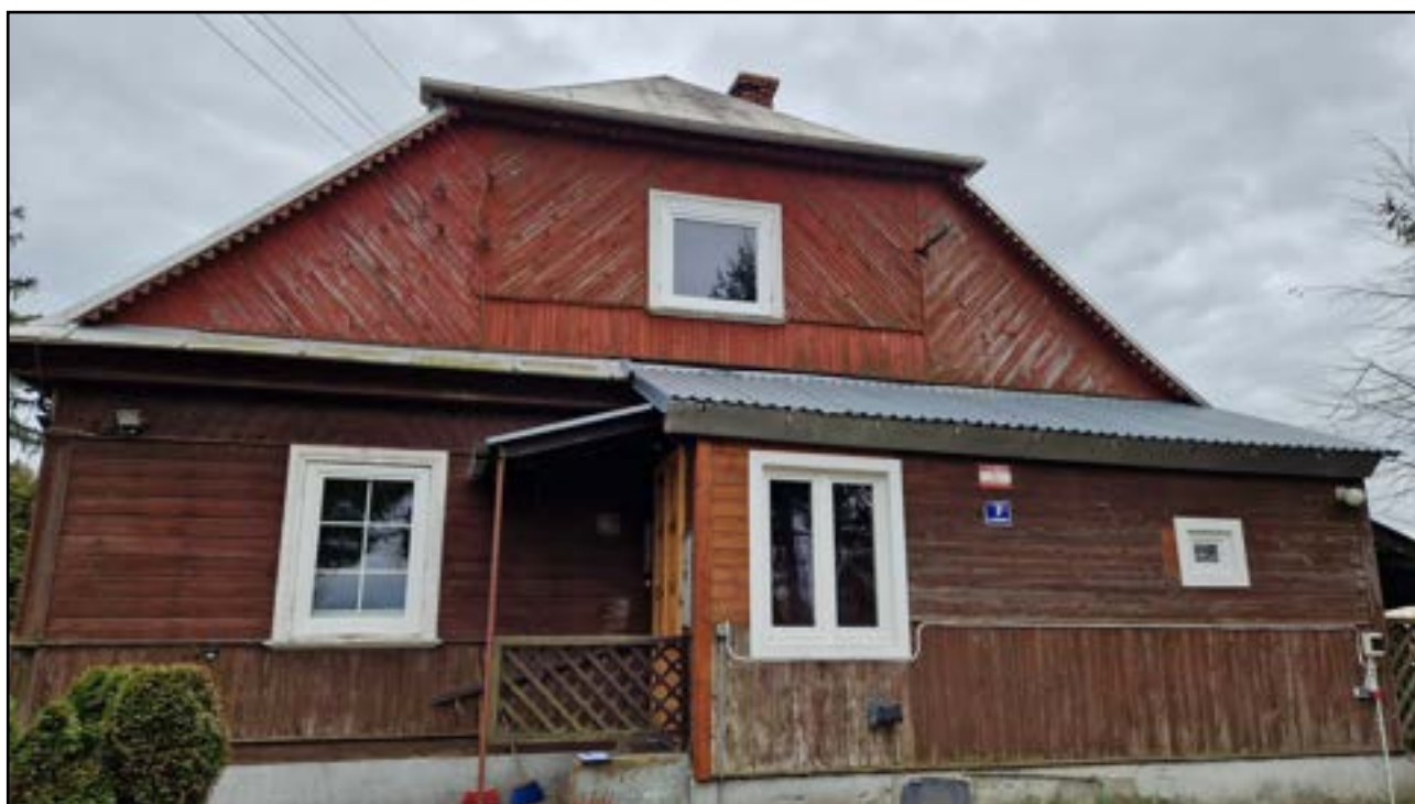
Fot 4: Plebania, Parafia Rzymskokatolicka pw. Św. Jana Apostoła w Nurze; stan obiektu przed konserwacją.
