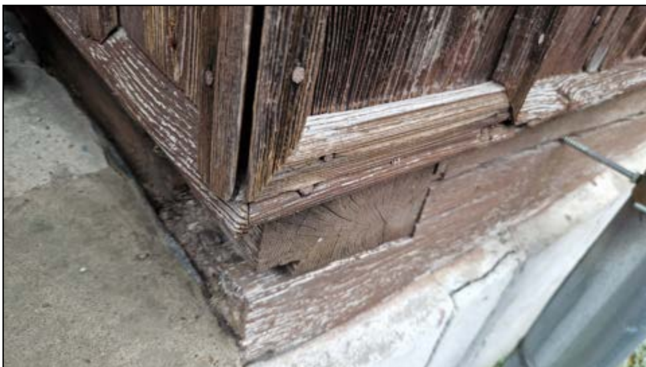
Fot 9: Plebania, Parafia Rzymskokatolicka pw. Św. Jana Apostoła w Nurze; stan obiektu przed konserwacją.
