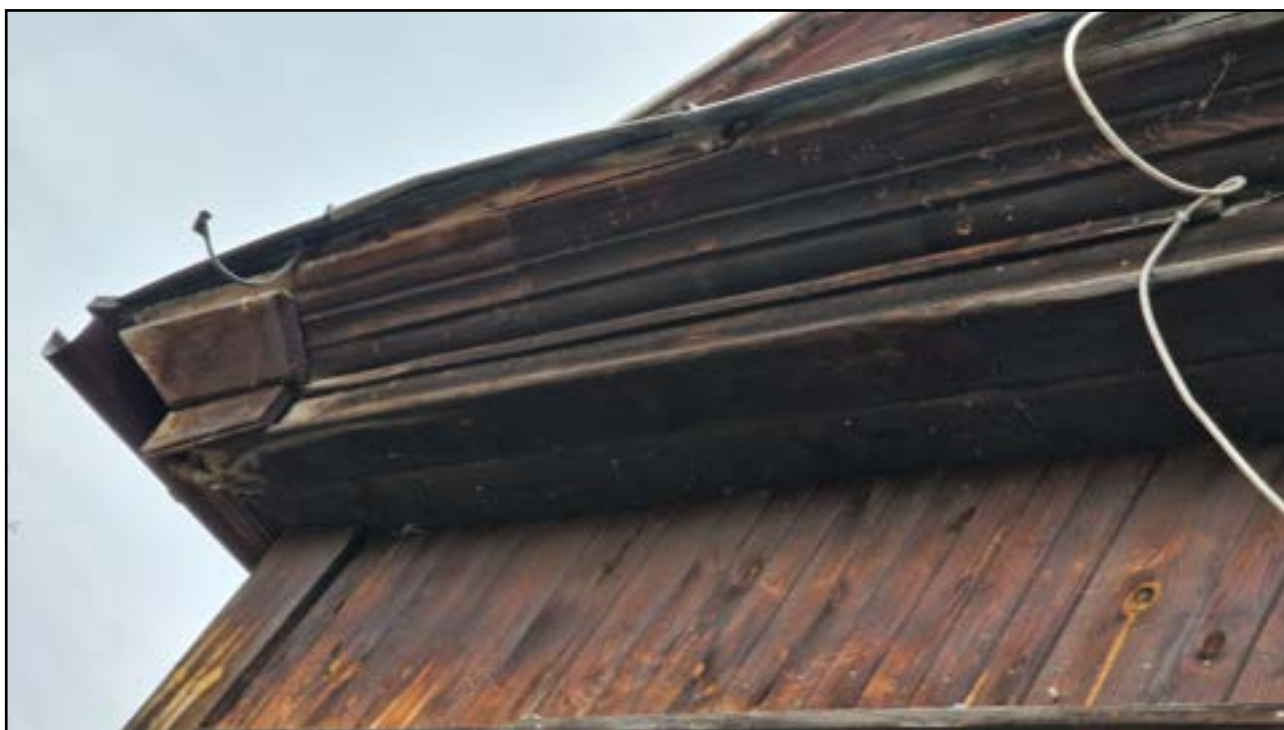
Fot 15: Plebania, Parafia Rzymskokatolicka pw. Św. Jana Apostoła w Nurze; stan obiektu przed konserwacją.
