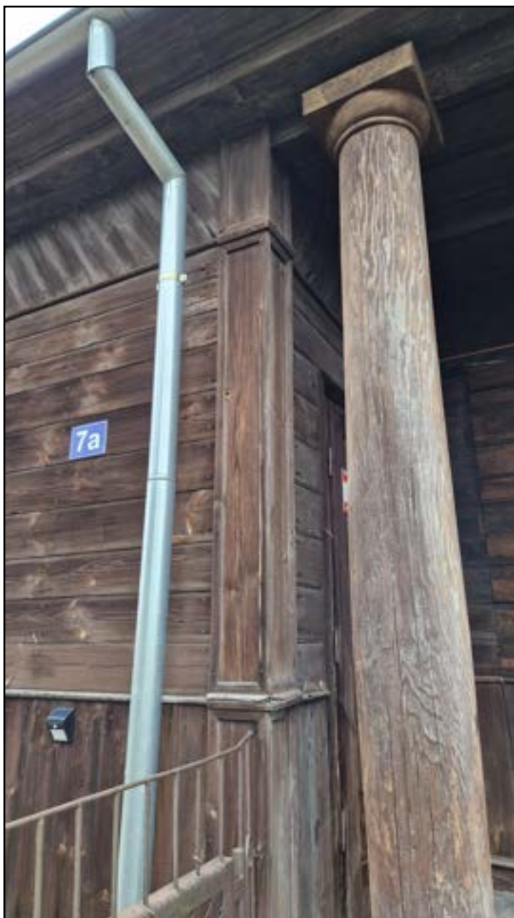
Fot 10: Plebania, Parafia Rzymskokatolicka pw. Św. Jana Apostoła w Nurze; stan obiektu przed konserwacją.
