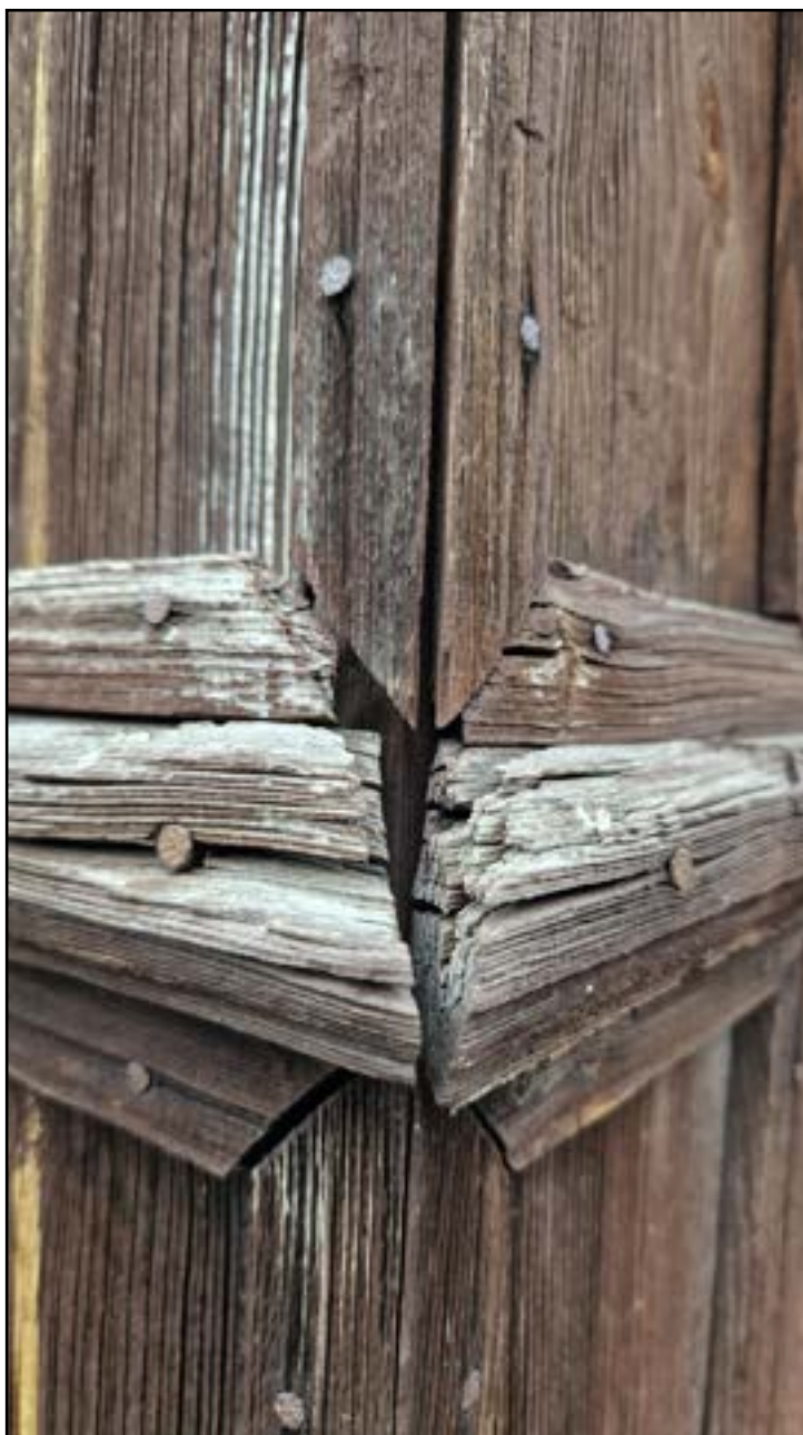
Fot 13: Plebania, Parafia Rzymskokatolicka pw. Św. Jana Apostoła w Nurze; stan obiektu przed konserwacją.
