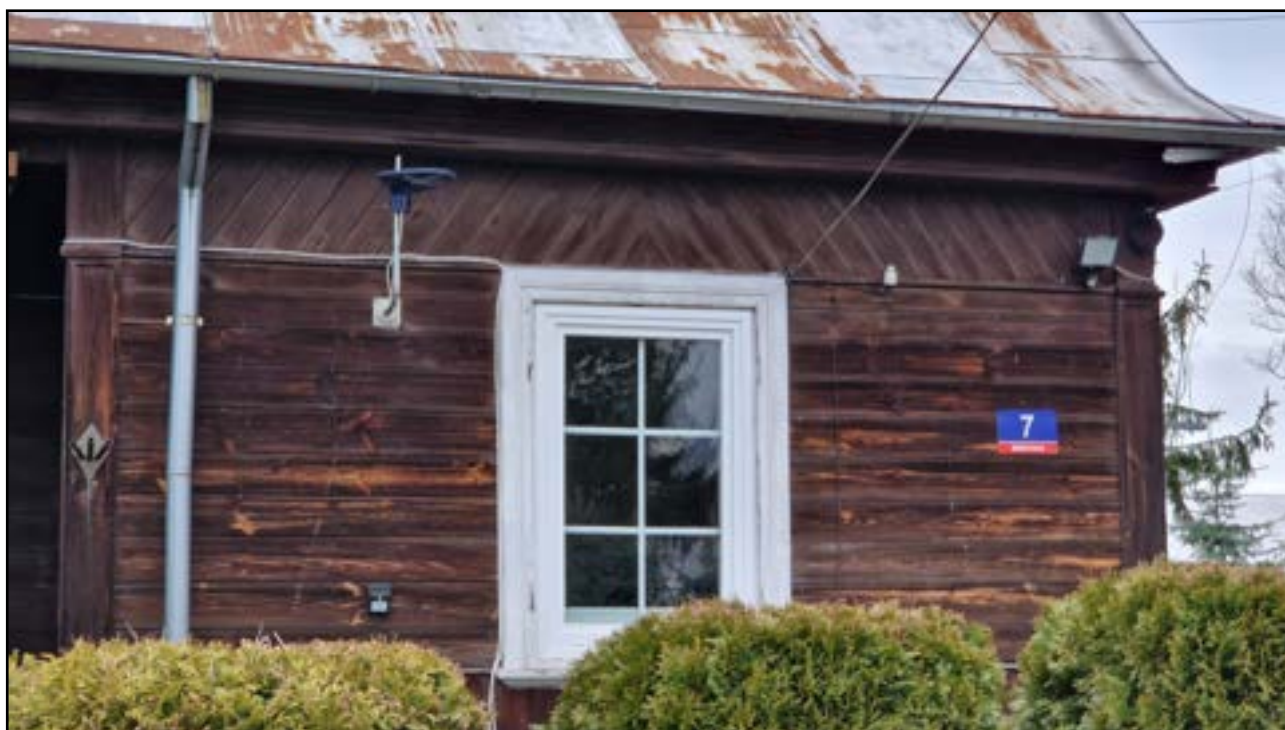
Fot 6: Plebania, Parafia Rzymskokatolicka pw. Św. Jana Apostoła w Nurze; stan obiektu przed konserwacją.
