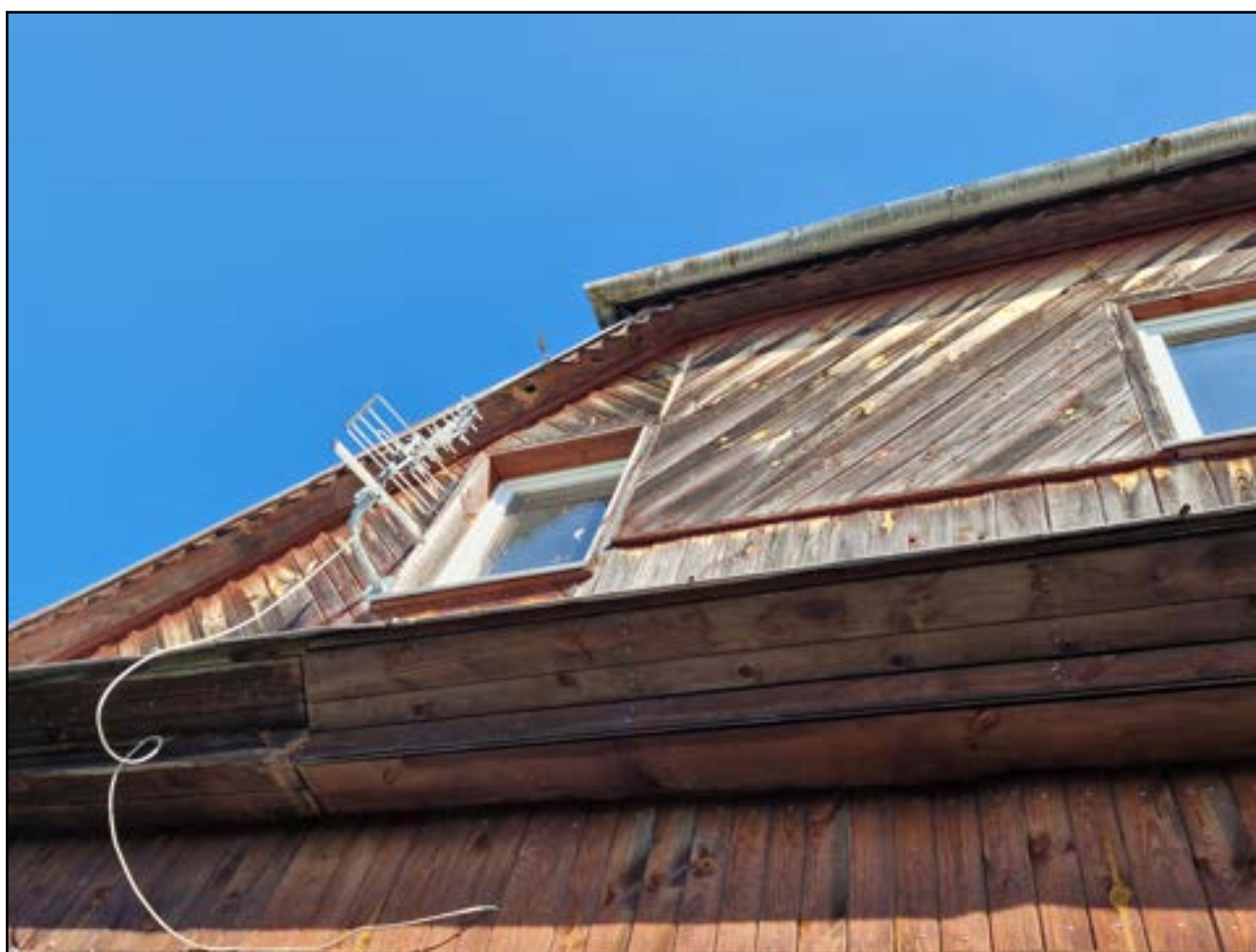
Fot 8: Plebania, Parafia Rzymskokatolicka pw. Św. Jana Apostoła w Nurze; stan obiektu przed konserwacją.
