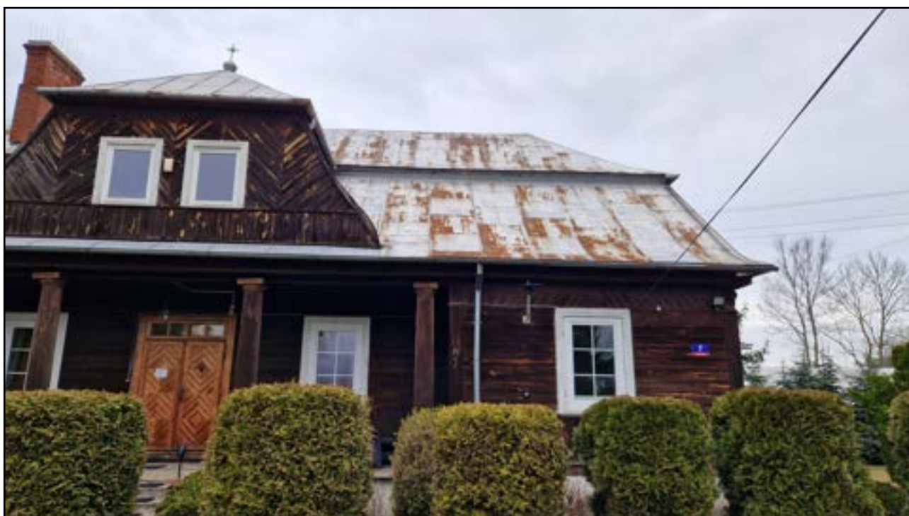
Fot 3: Plebania, Parafia Rzymskokatolicka pw. Św. Jana Apostoła w Nurze; stan obiektu przed konserwacją.
