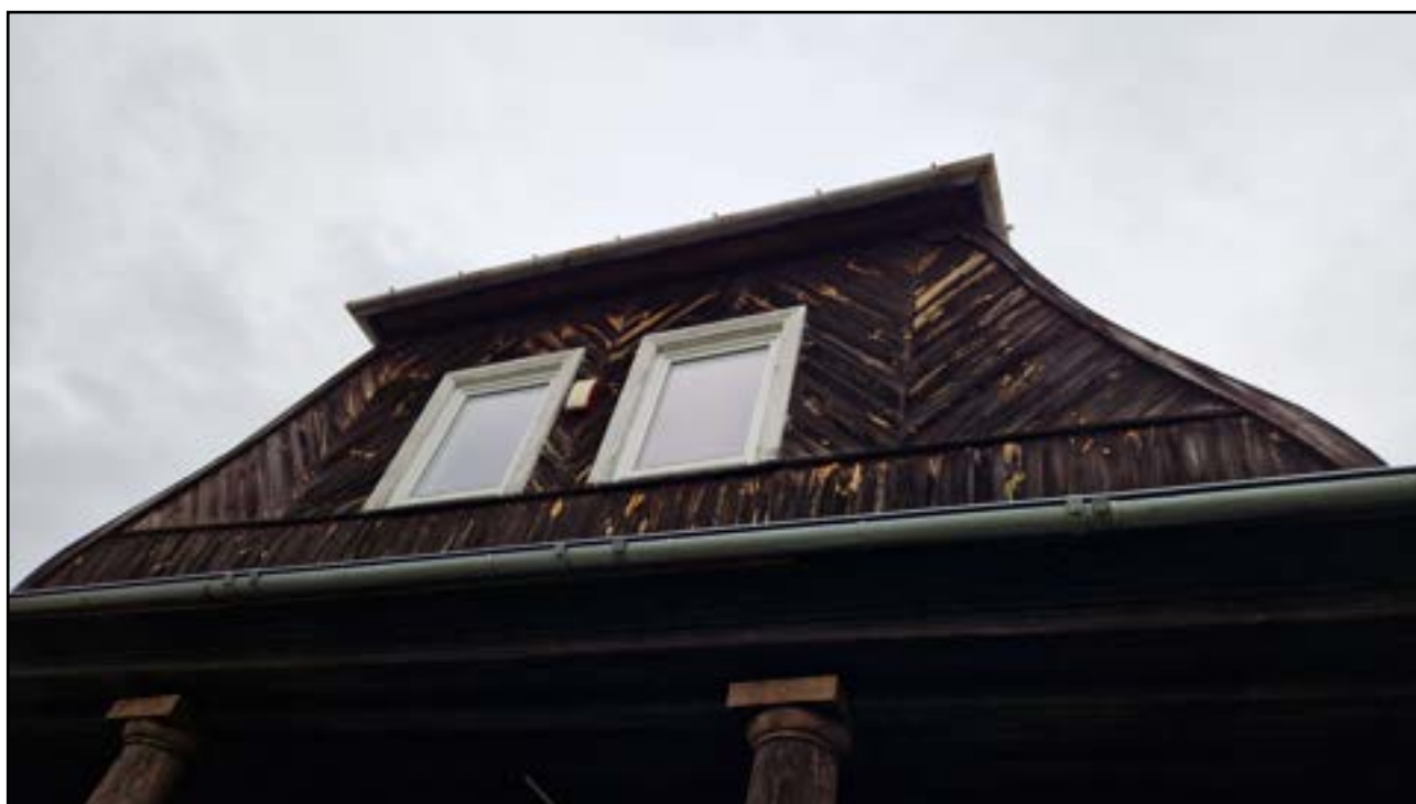
Fot 7: Plebania, Parafia Rzymskokatolicka pw. Św. Jana Apostoła w Nurze; stan obiektu przed konserwacją.
