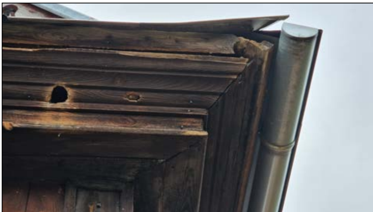
Fot 14: Plebania, Parafia Rzymskokatolicka pw. Św. Jana Apostoła w Nurze; stan obiektu przed konserwacją.
