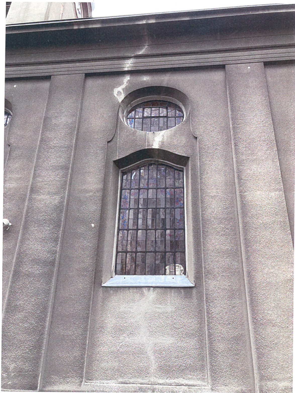
Fot.5. Witraże obserwowane od zewnątrz – brak przeszklenia zabezpieczającego
