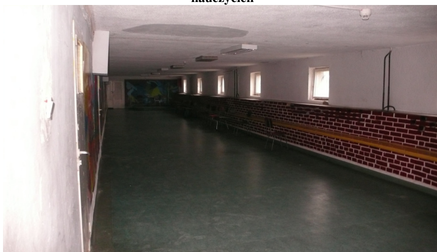
Rys. 21. Pomieszczenie klubowe w podpiwniczeniu budynku 7A. Okna i grzejniki do wymiany – brak wentylacji
