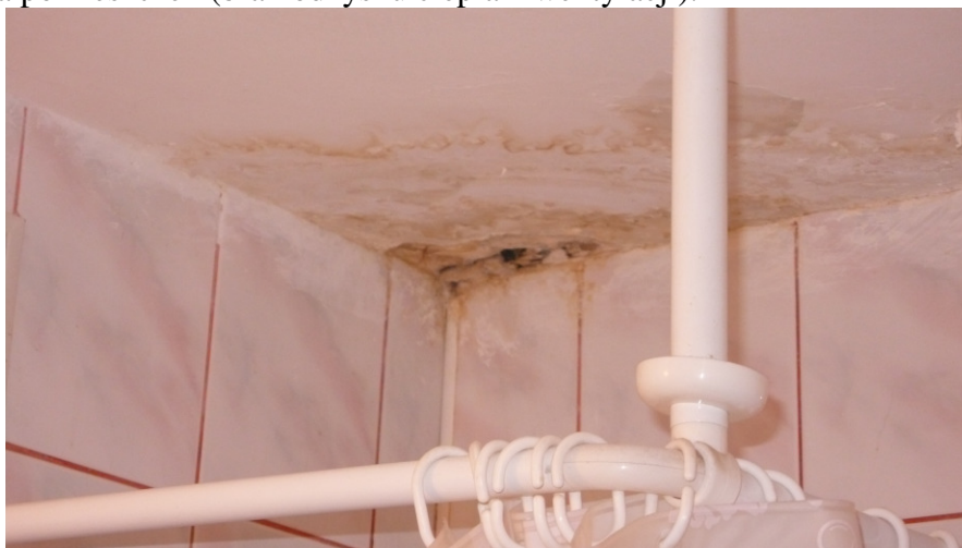
Rys. 27. Widoczny brak właściwej wentylacji (wilgoć i zniszczenie ściany).
