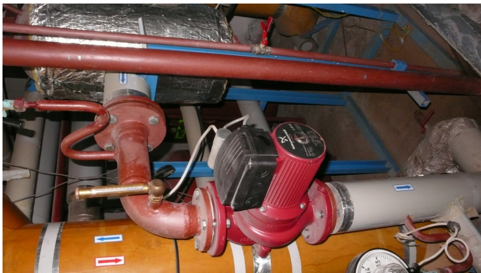
Rys. 25. pompa obiegowa instalacji węzła cieplnego - budynek 7A
