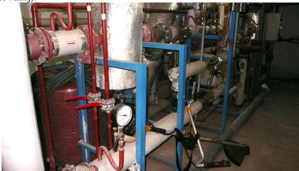
Rys. 24. Węzeł cieplny w budynku 7A
