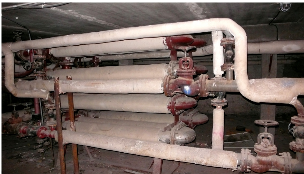
Rys. 22 Widok wymienników w węźle budynku 5A – węzeł do modernizacji
