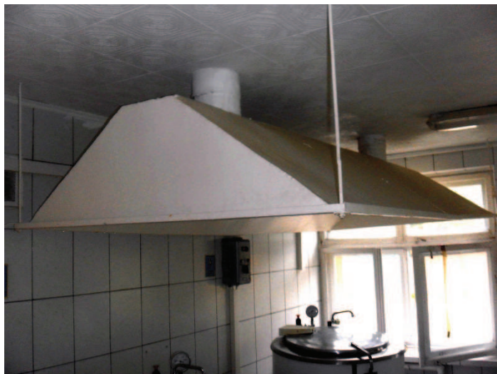
Rys. 5. Widok okapu nad kotłami (wadliwa praca instalacji) – do wymiany na nowy+ okno do zamurowania w czasie prac modernizacyjnych
