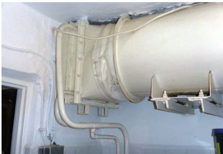
Rys. 7. Instalacja nawiewna: nagrzewnica i wentylator (do usunięcia i zastosowania centrali nawiewno – wywiewnej z rekuperacją)
