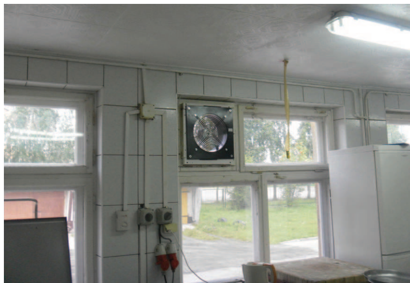
Rys. 4. Okna i wentylator nawiewny okienny w pomieszczeniu kuchni
