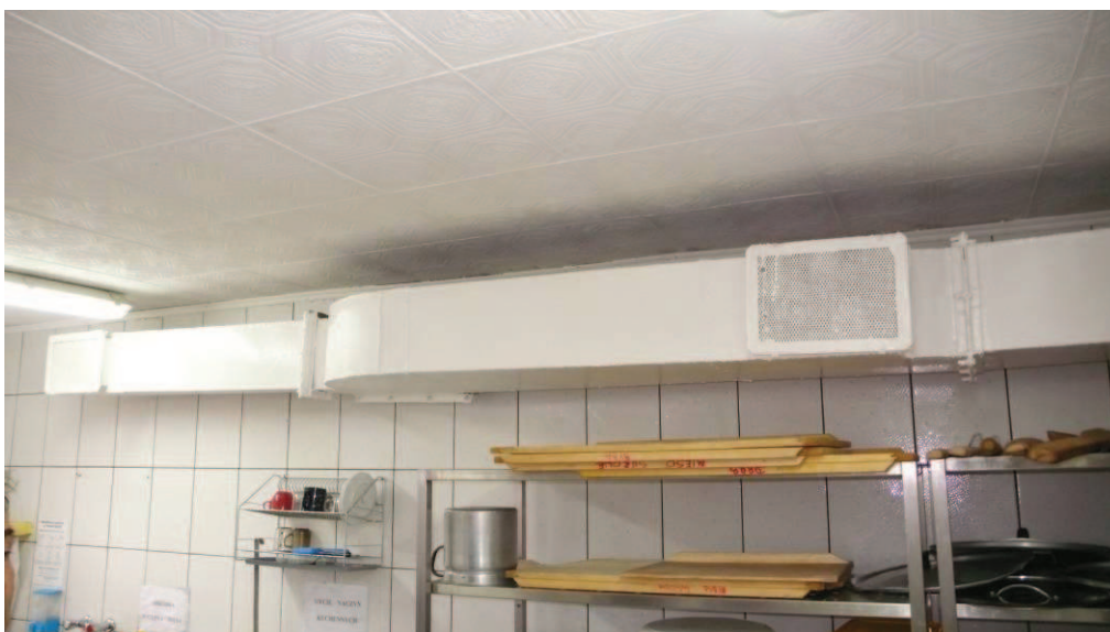
Rys. 6. Widok kanału wentylacji wywiewnej – do wymiany (obecnie pracuje jako nawiewna?)
