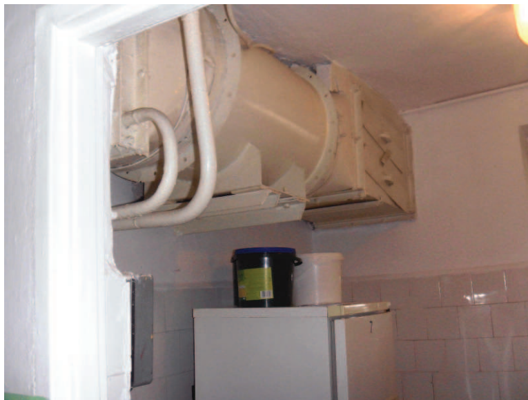
Rys. 8. Instalacja nawiewna - nie działa – do modernizacji
