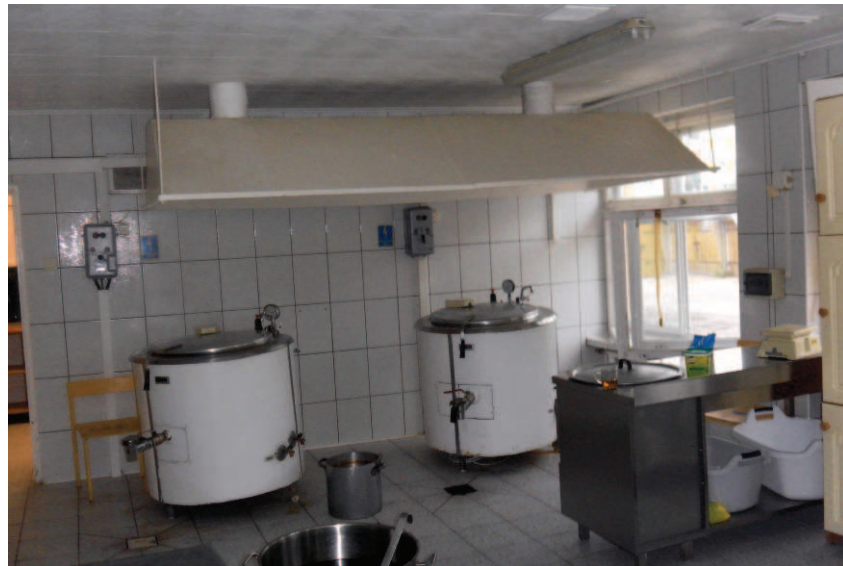
Rys. 3. Widok pomieszczeń kuchni -kotły warzelne i okap
