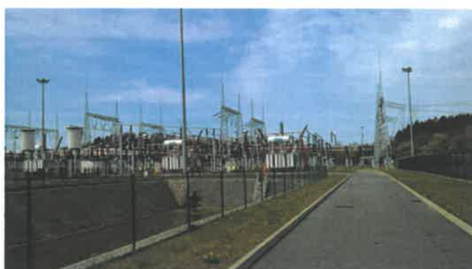
Po prawej stronie ogrodzenie stacji 400/110 kV Elk Bis w sąsiedztwie badanych dławików
