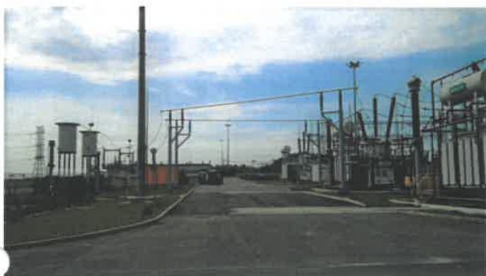
Droga wewnętrzna przy dławikach
