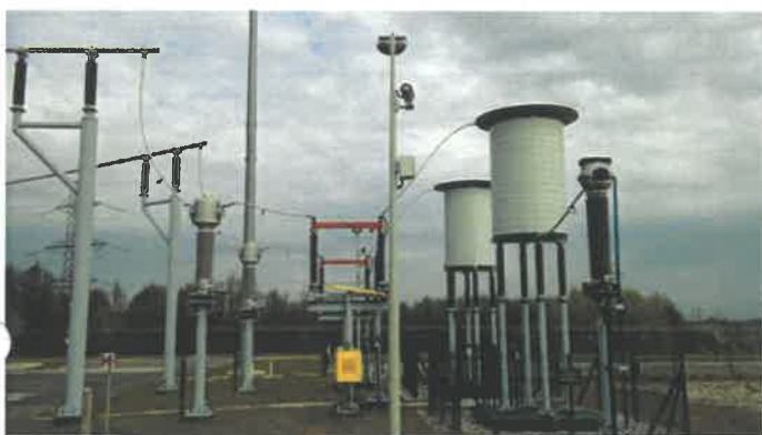
Widok aparatury dławika DLU2 za drogą wewnętrzną
