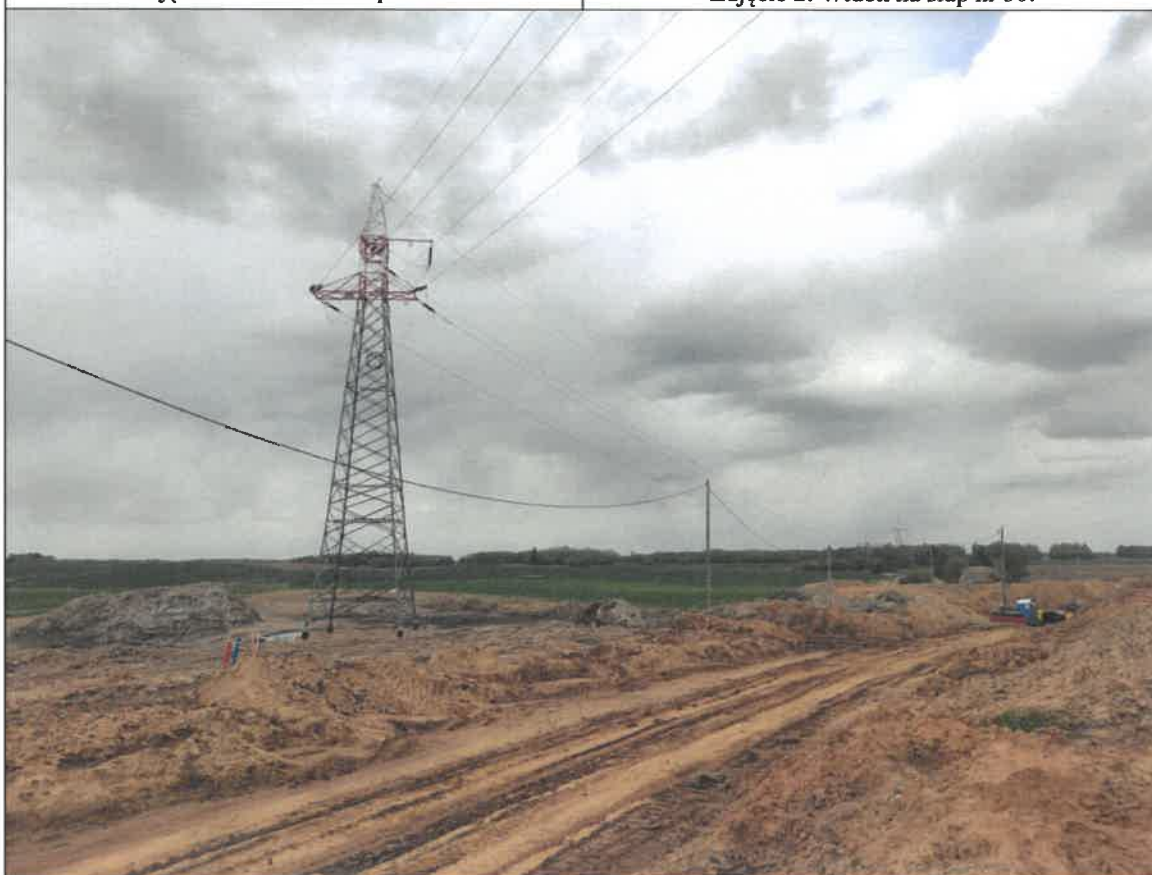
Zdjęcie 3: Widok na słup nr 30B.
