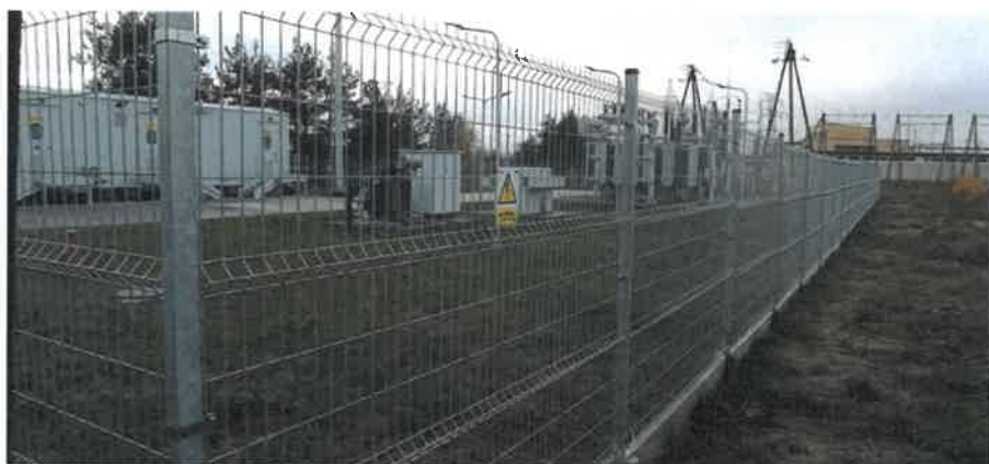
Otoczenie stacji 30/110 kV GPO Krzywińskie
