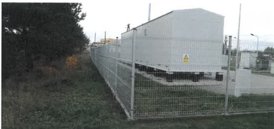
Otoczenie stacji 30/110 kV GPO Krzywińskie
