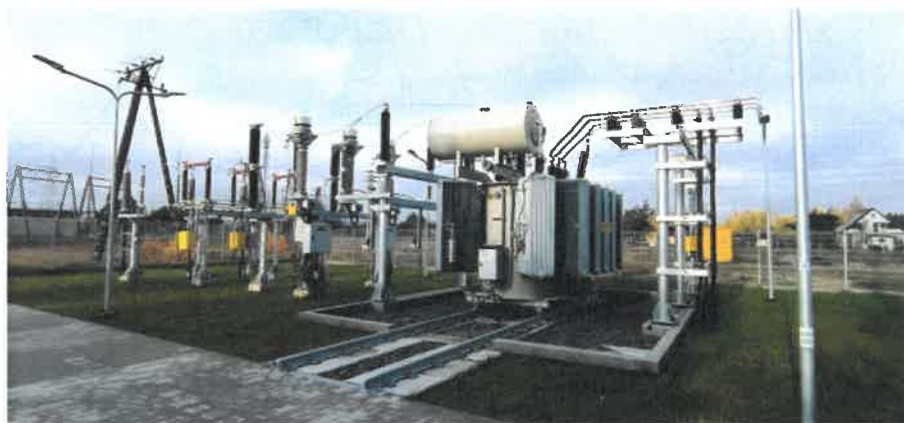
Rozdzielnia 110 kV na terenie GPO Krzywińskie
