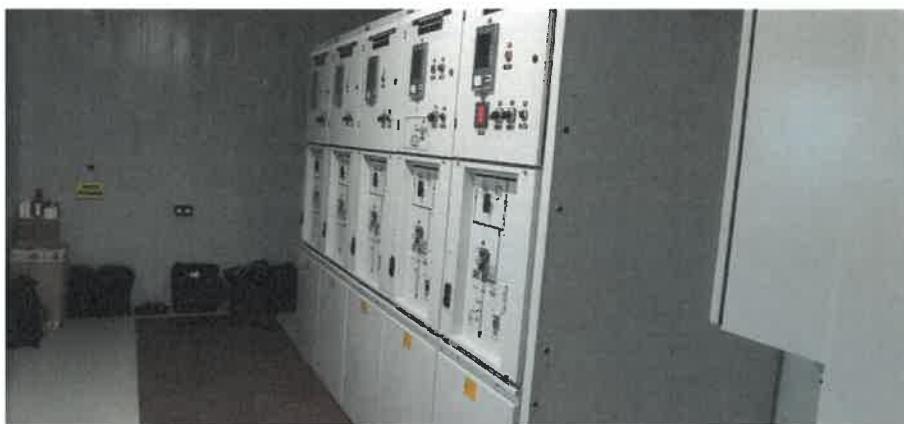
Rozdzielnia 30 kV na terenie GPO Krzywińskie
