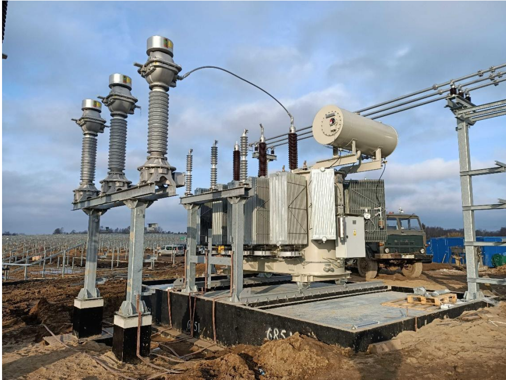
Ryc. nr 12 Przykładowe stanowisko transformatora z misą olejową
