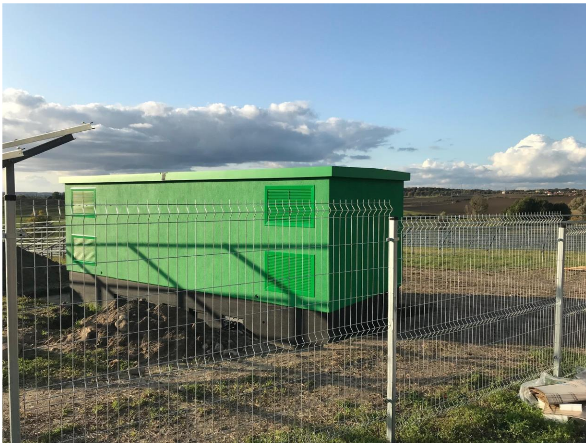
Ryc. nr 9 Przykładowa stacja transformatorowa
