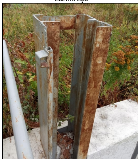
Zdjęcie 6 Jaz Banaszki – przewadnica zamknięć
