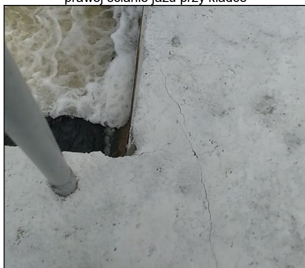
Zdjęcie 5 Jaz Banaszki – spękania betonu na prawej ścianie jazu przy kładce
