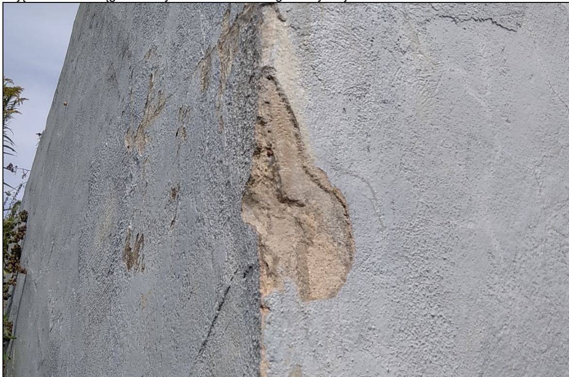
Zdjęcie 23 Jaz Wągniki – ubytki na ścianie lewego skrzydła jazu
