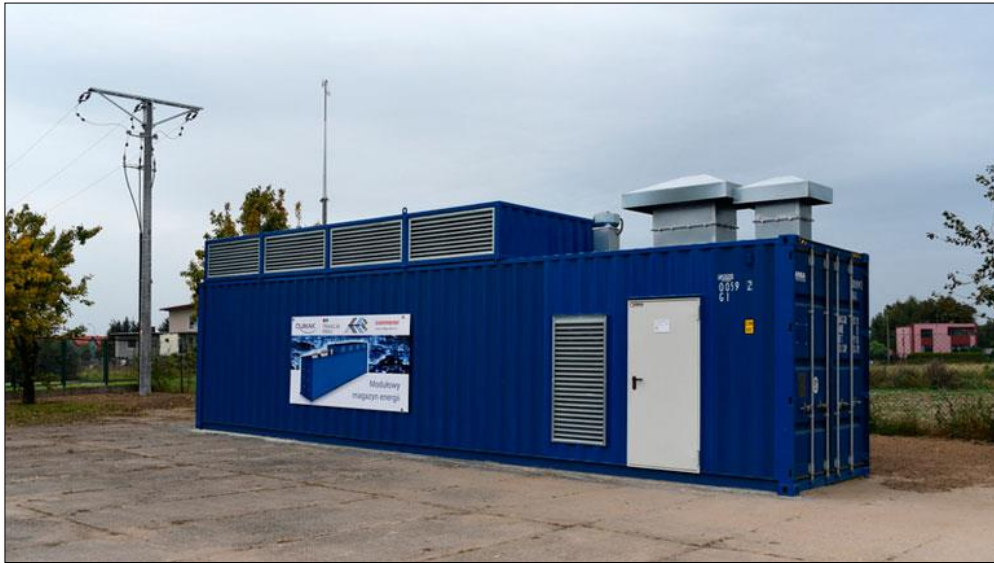
Zdjęcie 6 Przykład magazynu energii
