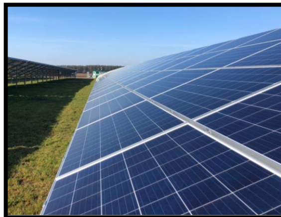
Zdjęcie 2 Polikrystaliczne panele fotowoltaiczne
