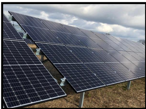
Zdjęcie 1 Monokrystaliczne panele fotowoltaiczne
