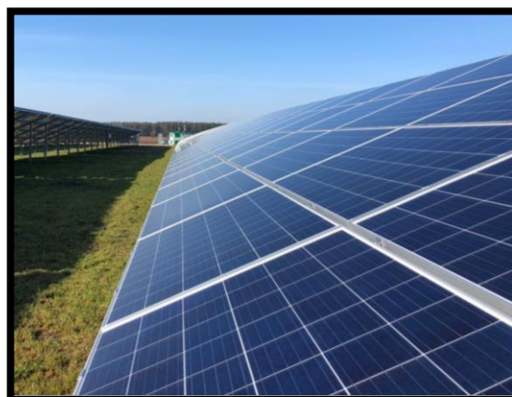
Zdjęcie 2 Polikrystaliczne panele fotowoltaiczne
