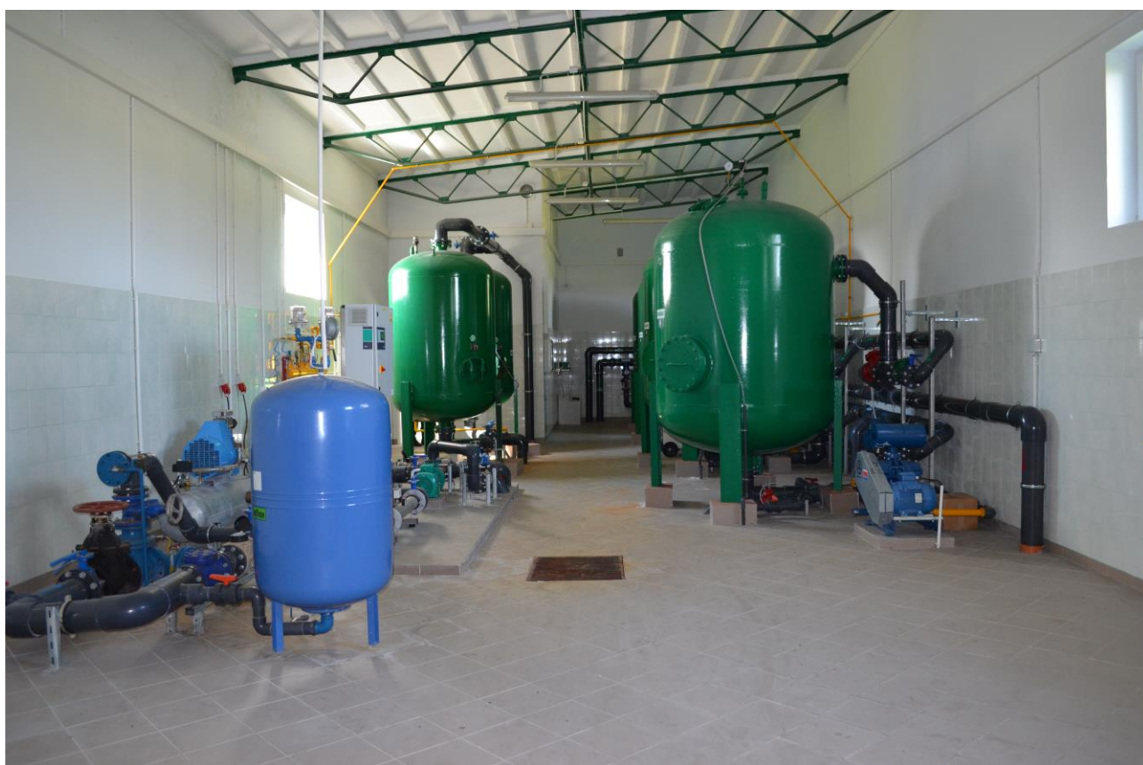
Nowoczesna stacja uzdatniania wody w Bykowie
