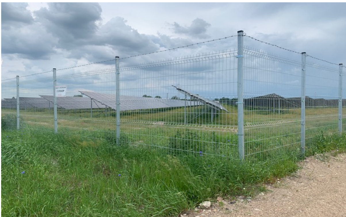
Fot. 9. Farma fotowoltaiczna za ażurowym ogrodzeniem.
