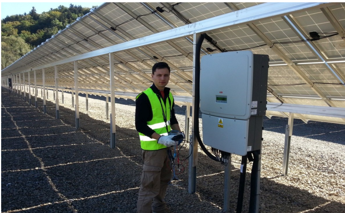
Fot. 7. Instalacja zamontowana pod konstrukcją paneli na jednej z pracujących w Polsce farm fotowoltaicznych w Tymbarku. Zdjęcie www.solgen.pl
