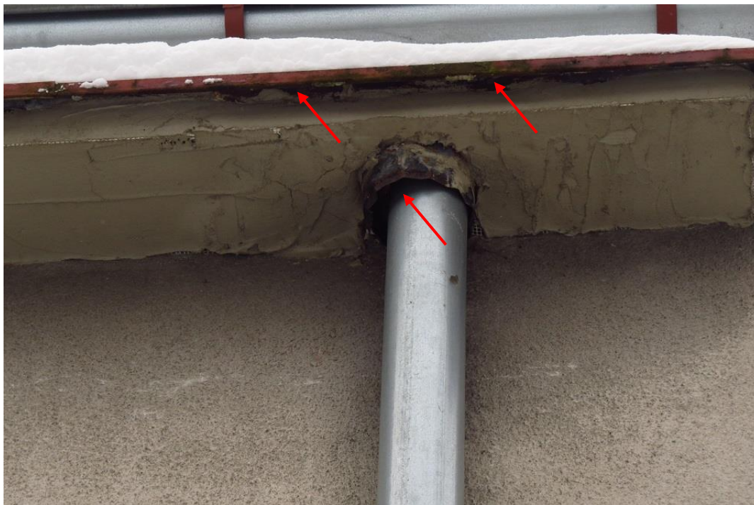
Fot. 4 Potencjalne kryjówki nietoperzy w obrębie dachu.
