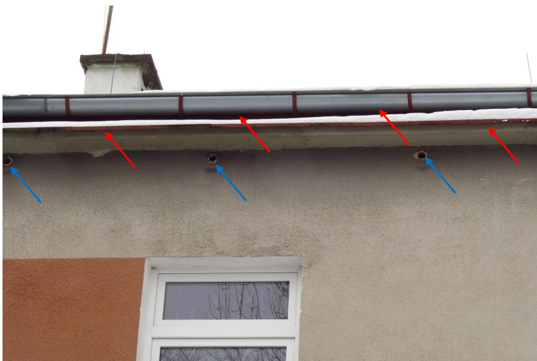
Fot. 3. Ujścia przewodów wentylacyjnych umożliwiające dostanie się nietoperzy do stropodachu (niebieskie strzałki) i inne potencjalne kryjówki nietoperzy w obrębie dachu budynku czerwone strzałki).
