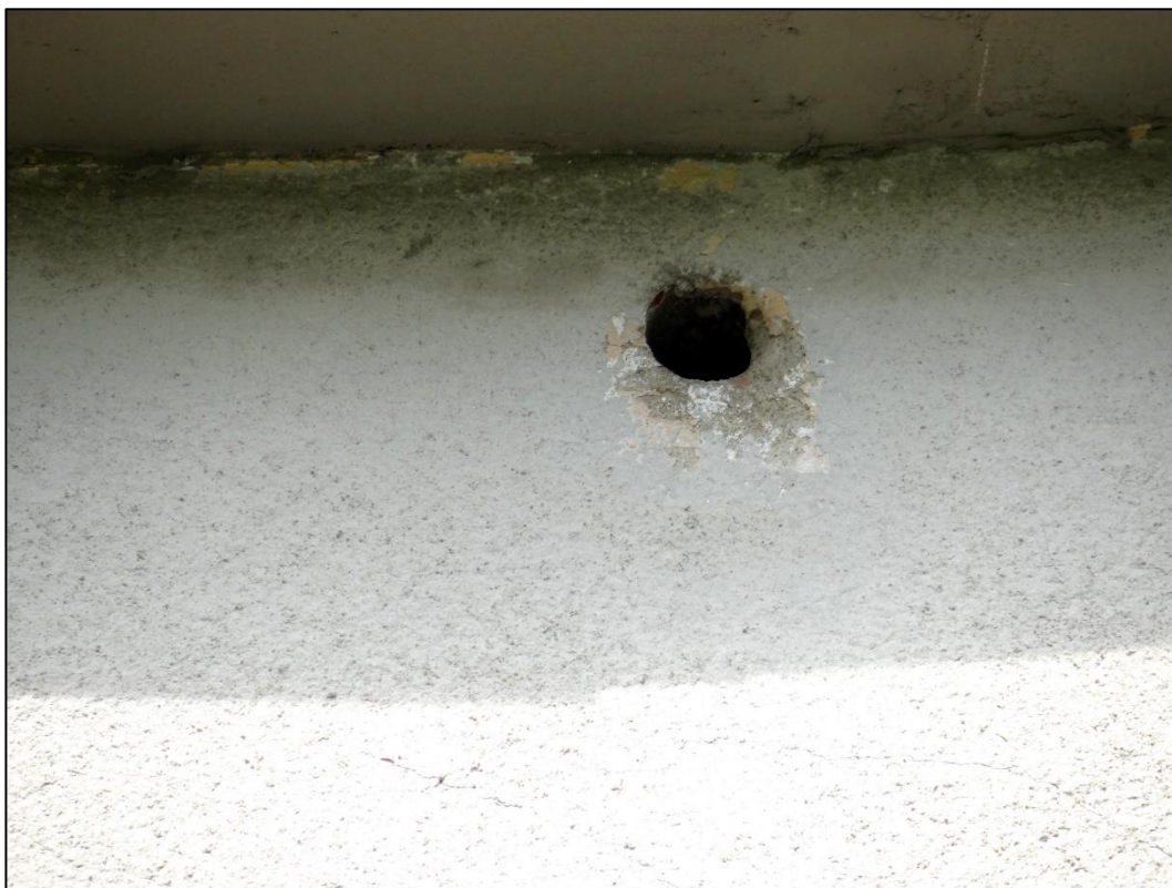
Fot.10. Przedszkole w Korszach – elewacja zachodnia. Wywietrznik od lat wykorzystywany przez jerzyki.
