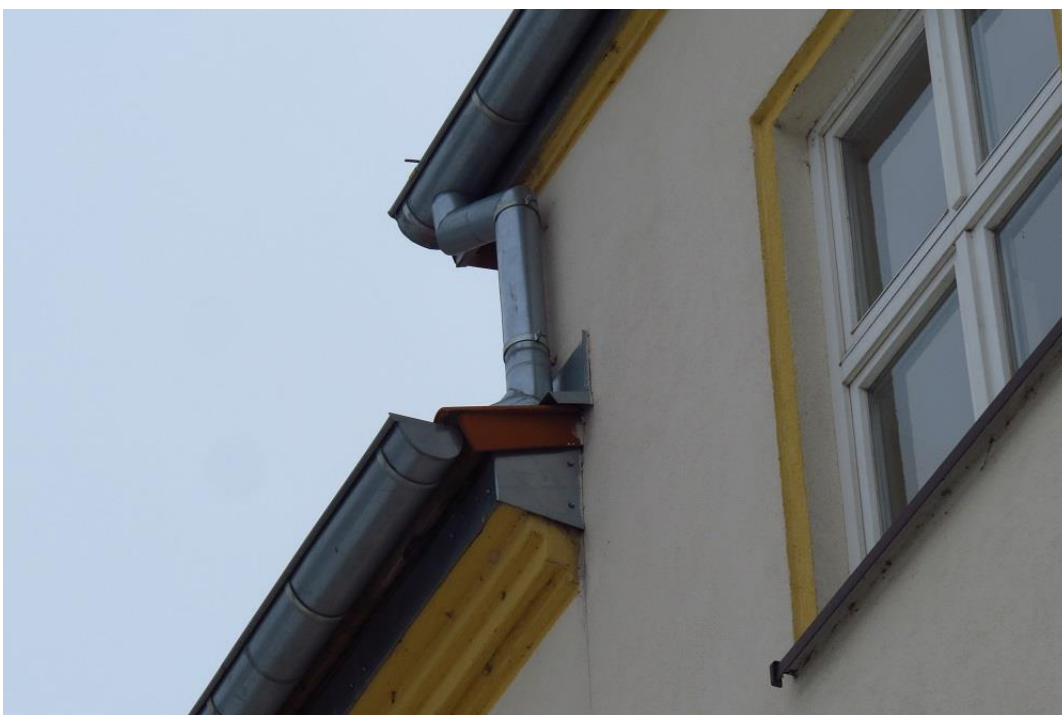
Fot. 4. Potencjalne kryjówki nietoperzy pod obróbką blacharską dachu starej szkoły.
