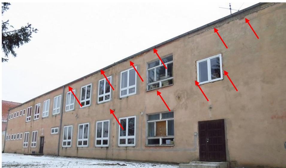
Fot. 7 Elewacja północna. Strzałkami zaznaczono liczne ubytki i szczeliny stanowiące potencjalne kryjówki nietoperzy.
