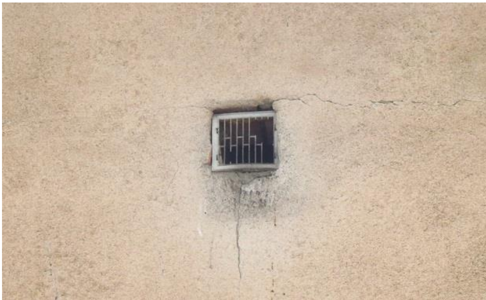
Fot. 3 Uszkodzona krata zabezpieczająca przewód wentylacyjny w elewacji wschodniej.
