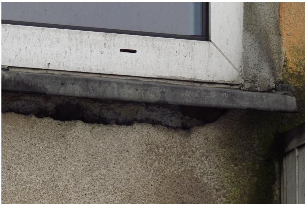
Fot. 5 Szczeliny pod parapetami – potencjalne kryjówki letnie.
