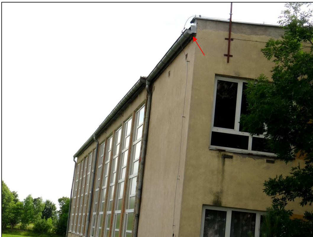
Fot. 23. SP w Garbnie – sala gimnastyczna, elewacja wschodnia. Miejsce łęgowe jerzyka.
