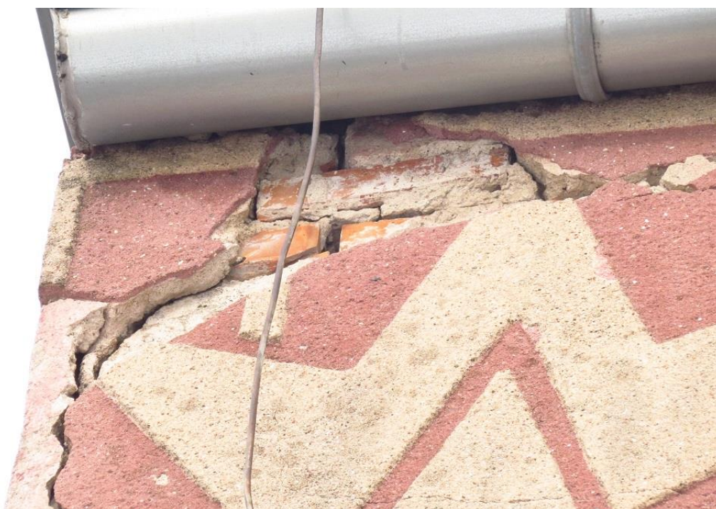
Fot. 10 Południowa elewacja budynku. W górnej części ścian liczne pęknięcia i ubytki, które mogą być wykorzystywane przez nietoperze.
