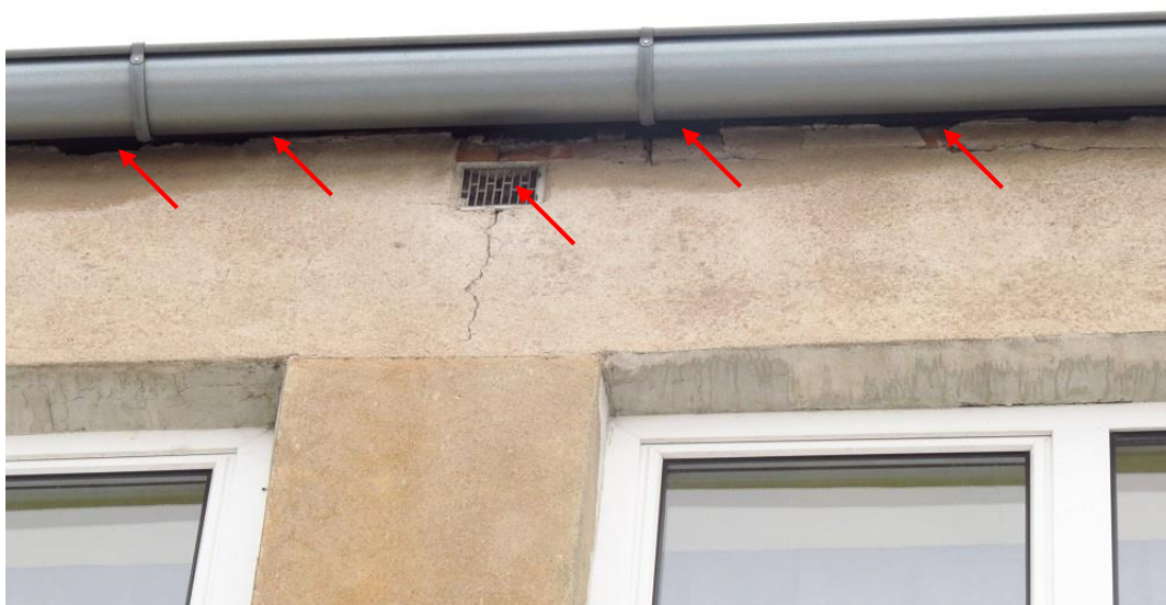
Fot. 2. Kratka zabezpieczająca przewody wentylacyjne ze szczelinami przez które nietoperze mogą przedostać się do stropodachu oraz liczne ubytki w górnej części elewacji i pod rynnami – potencjalne kryjówki
