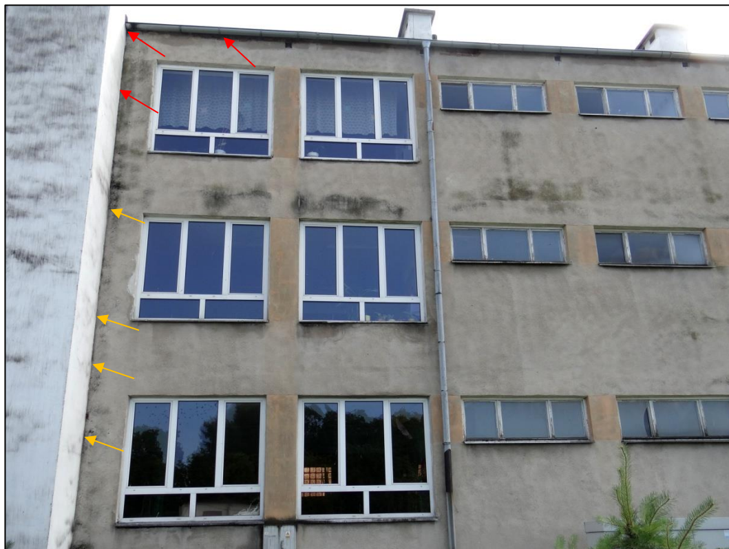
Fot. 19. SP w Garbnie – elewacja północna, cz. C (na prawo od komina). Miejsca gniazdowania jerzyka (strzałki czerwone) i wróbla (strzałki pomarańczowe).
