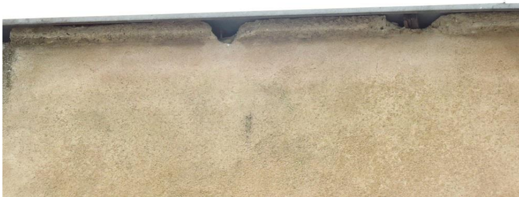
Fot. 6 Ubytki w górnej części elewacji na krawędzi styku ściany z dachem.
