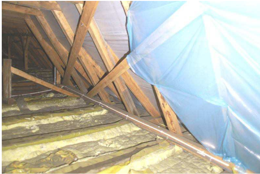
fot.13. Widok krokwi od strony północnej prezbiterium z niepoprawnym, nowoczesnym usztywnieniem podłużnym dachu w postaci wiatrownic. Dodatkowo widoczne tymczasowe zabezpieczenie folią przed przeciekami przez pokrycie
