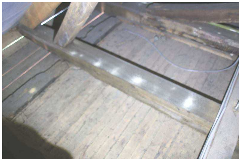
fot.15. Widok śladów czynnego żerowania owadów w belkach stropowych nawy – strona południowa
