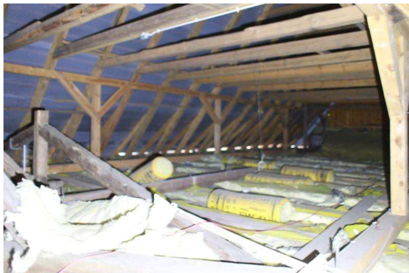
fot.11. Widok wiązarów jętkowych w dachu nad nawą (boczne ramy stolcowe na przeważającej długości niepoprawne zamontowane – podpierają krokwie poniżej węzłów z jętkami). Widoczne niepoprawne owinięcie folią paroszczelną drewnianych belek stropowych
