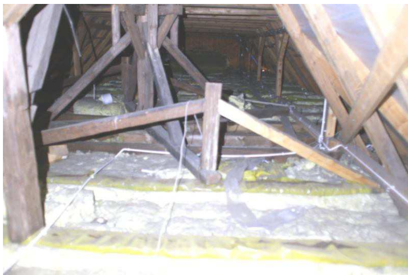
fot.18. Widok jednowieszakowego wiażara wieszarowego podpierającego podwalinę wieżyczki w dachu nad prezbiterium – ze względu na rozluźnienia wiażar przewidziany do rozbiórki
