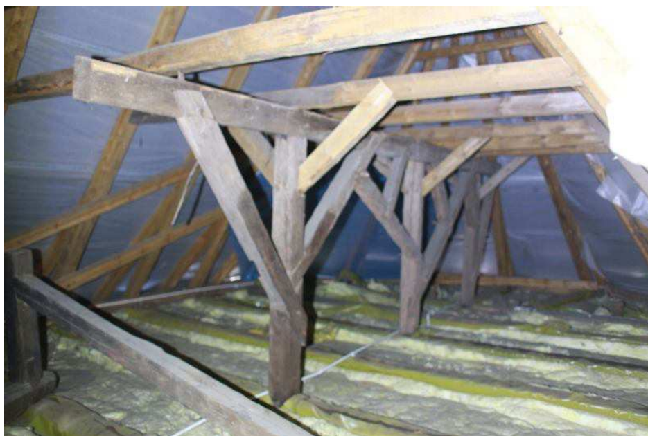
fot.10. Widok wiązarów jętkowych w dachu nad prezbiterium (środkowa rama nie stanowi poprawnego podparcia – uległa rozluźnieniu i opuszczeniu, bądź została niepoprawnie wtórnie zmontowana). Widoczne niepoprawne owinięcie folią paroszczelną drewnianych belek stropowych
