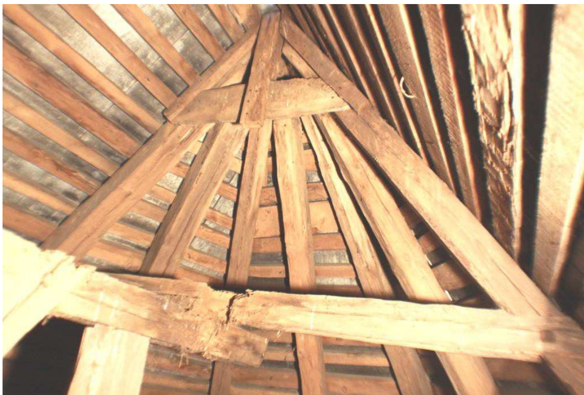
fot.9. Widok brakującego podparcia krokwi w dachu nad trójbocznym zamknięciem prezbiterium
