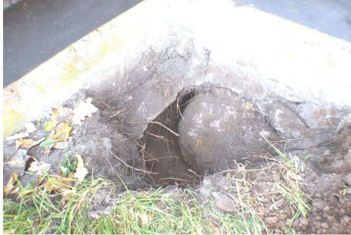
fot.17. Widok posadowienia z betonowym (żelbetowym) minowaniem w narożniku pomiędzy nawą i zakrystią
