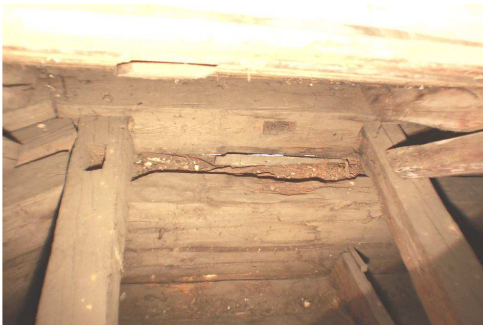
fot.14. Widok zniszczeń murłaty nad prezbiterium
