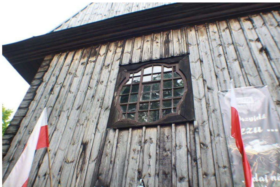
fot.19. Widok uszkodzeń szalunku zewnętrznego – elewacja zachodnia
