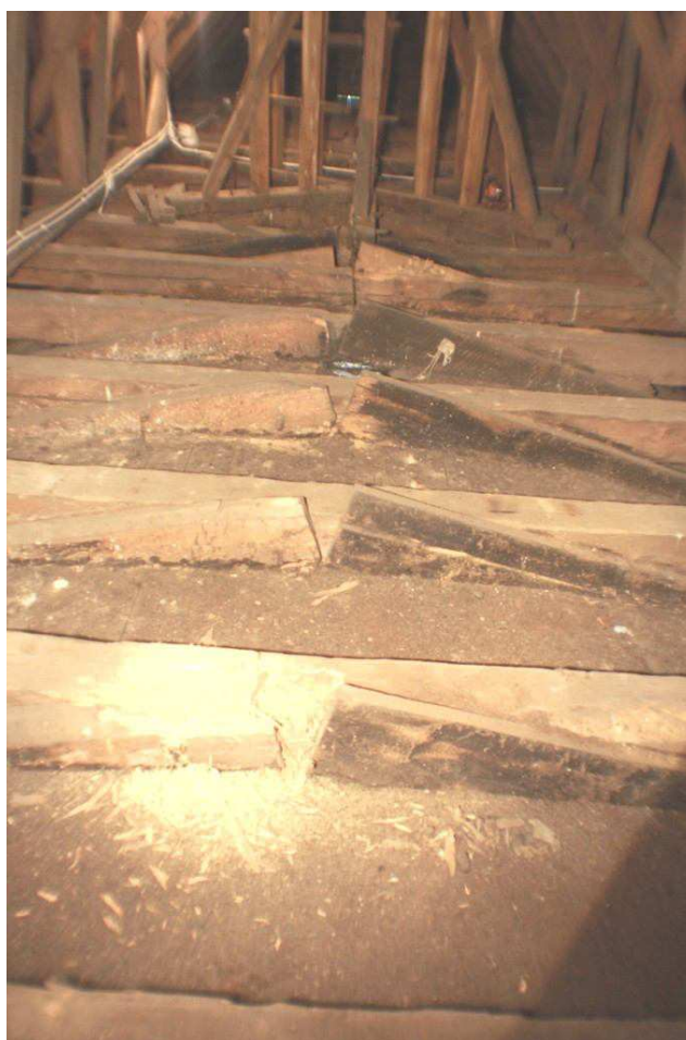
fot.6. Widok korozyjnych zniszczeń belek głównych oraz krążyn łukowego sklepienia nad nawą
