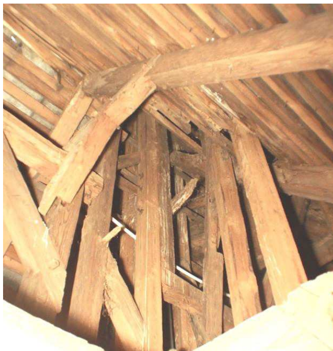
fot.8. Widok korozyjnych uszkodzeń słupów wieżyczki w strefie przejścia przez połąć dachową
