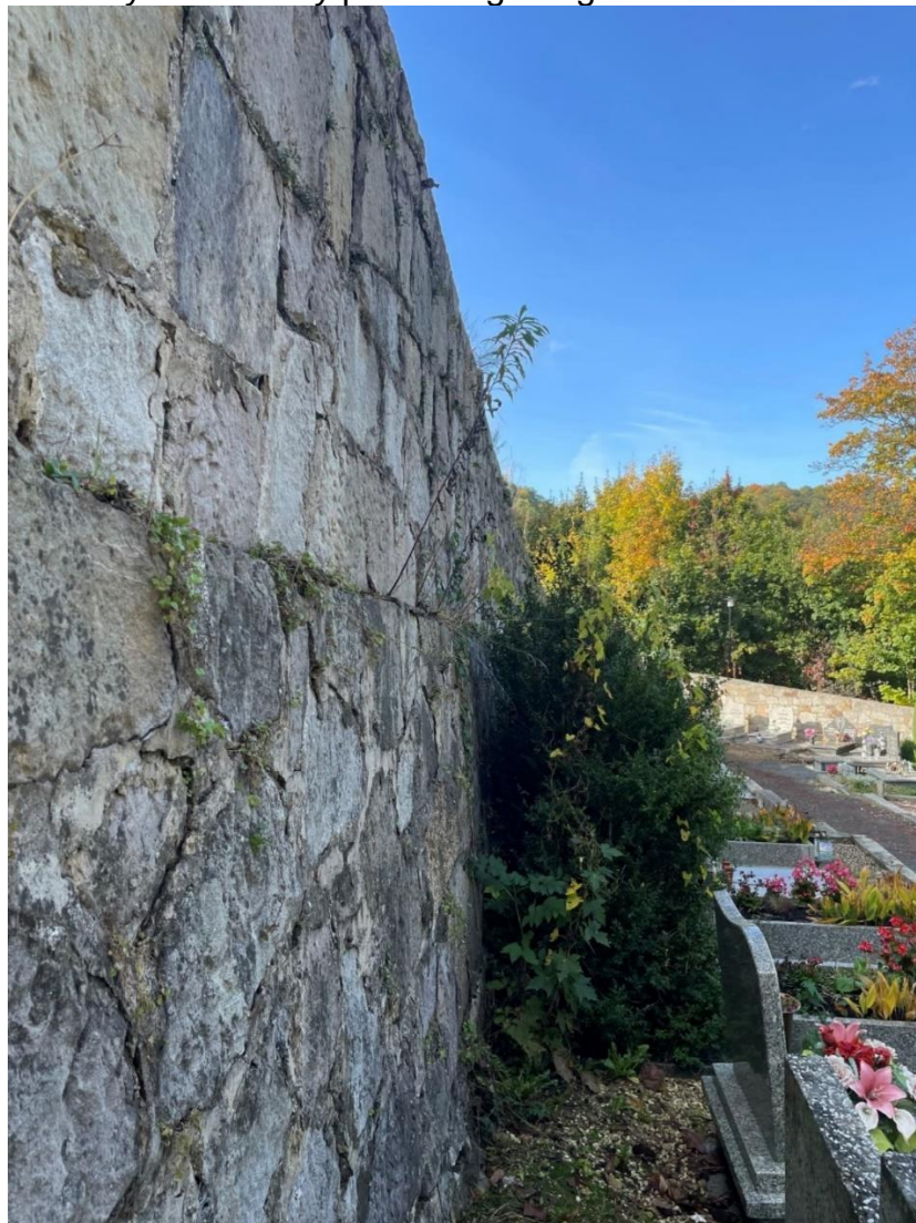
Ubytki/szczeliny północnego fragmentu
