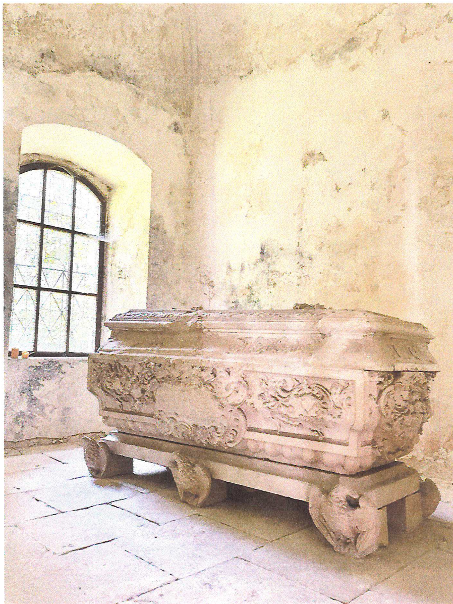
fragment kaplicy grobowej: widoczne zdegradowane tynki - zmurzałe, z rozległymi ubytkami, wykwitami soli i pleśni
