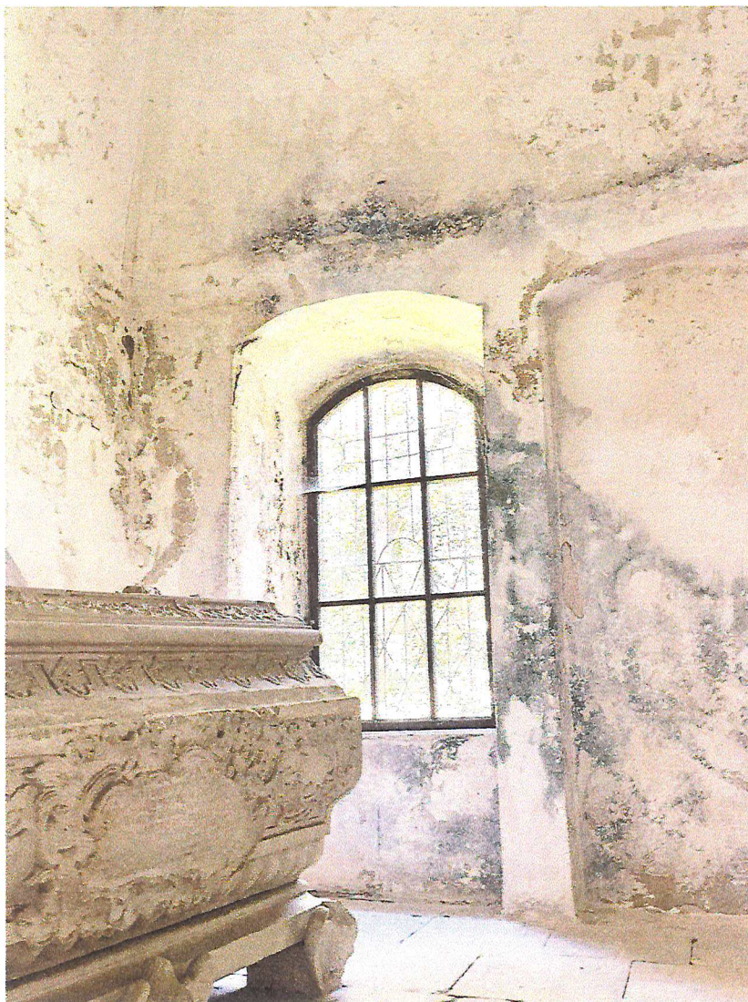
fragment kaplicy grobowej: widoczne zdegradowane tynki - zmurszałe, z rozległymi ubytkami, wykwitami soli i pleśni
