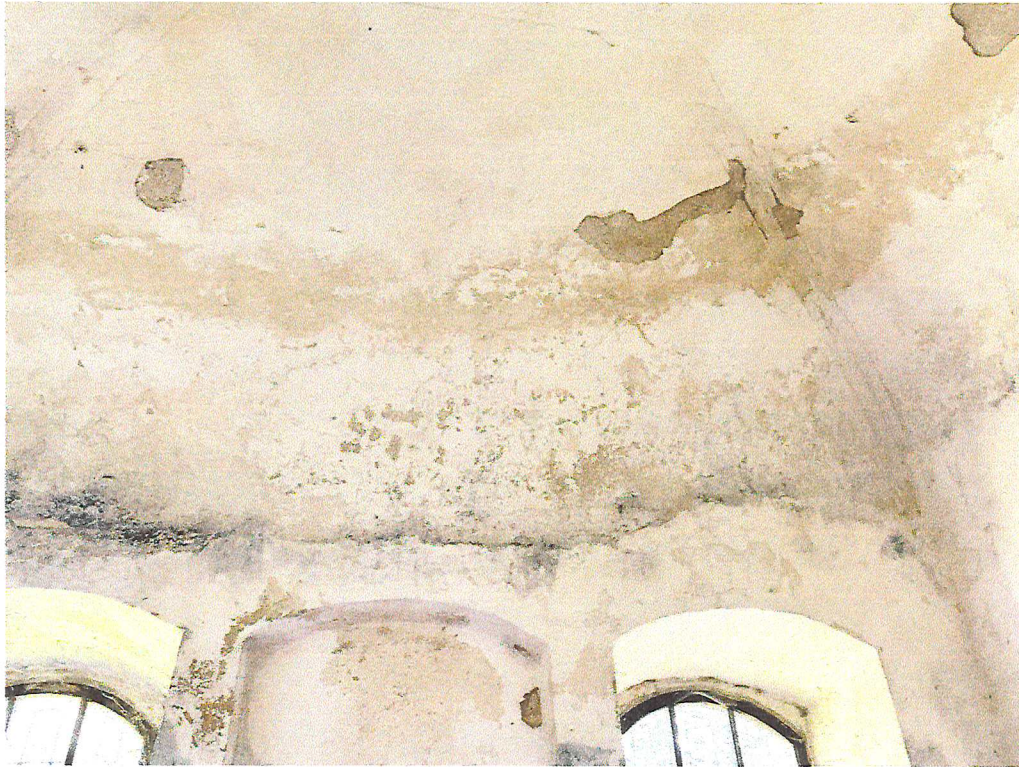
fragment sklepienia kaplicy grobowej: widoczne zdegradowane tynki - zmurszałe, z rozległymi ubytkami, wykwitami soli i pleśni
