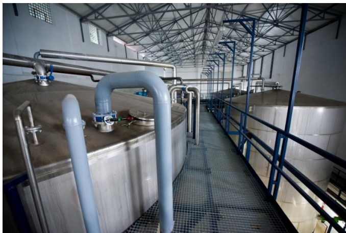
Zbiorniki fermentacyjne w hali fermentacji
