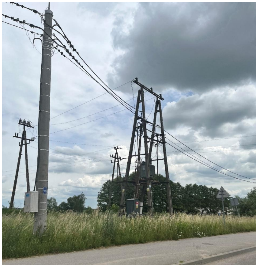
Fotografia 10. Linia elektroenergetyczna średniego napięcia przebiegająca przez analizowany teren. Zdjęcia własne wykonane w trakcie wizji terenowej.
