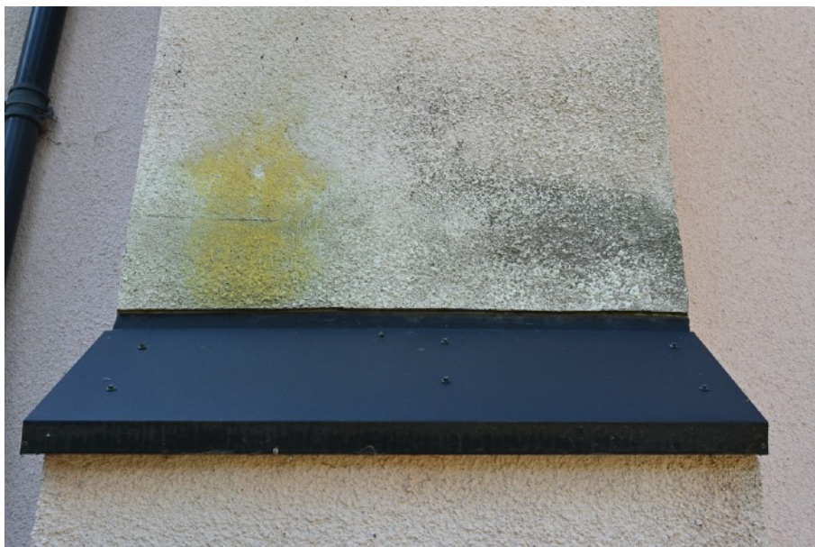
Fot. 6 Nakrywa przypory na elewacji południowej. Obróbki zostały wymienione kilkanaście lat temu. Widoczny jest brak prawidłowego wcięcia pionowego elementu obróbki w mur, przez co dochodzi do zamakania muru i rozwoju mikroorganizmów.
