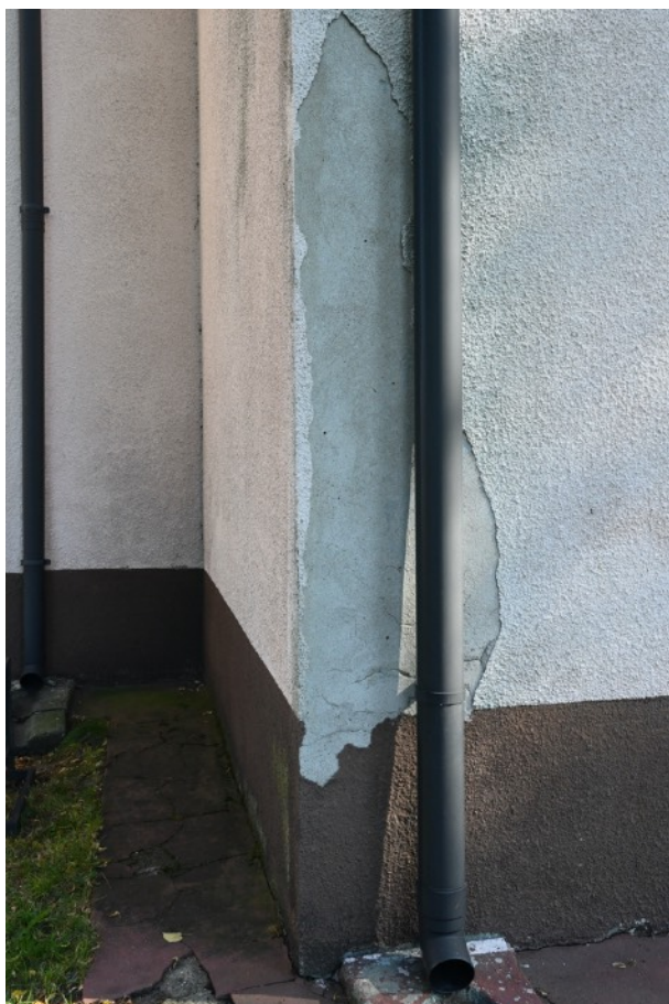
Fot. 8 Ubocznym skutkiem zawilgoce- nia muru jest odparzenie wierzchniej warstwy tynku- w tym przypadku nakrop (baranek) jest warstwą wtórną pokrywającą wcześniejszy tynk wapienno- piaskowy.
