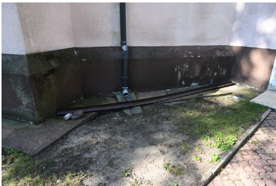
Fot. 2 Wschodni odcinek muru prezbiterium od strony północnej na styku z zakrystią. Zawilgocenie, rozwój mikroorganizmów, a także naprawy wykonywane przy użyciu mocnej zaprawy cementowej są najpoważniejszymi problemami dotyczącymi ścian kościoła.
