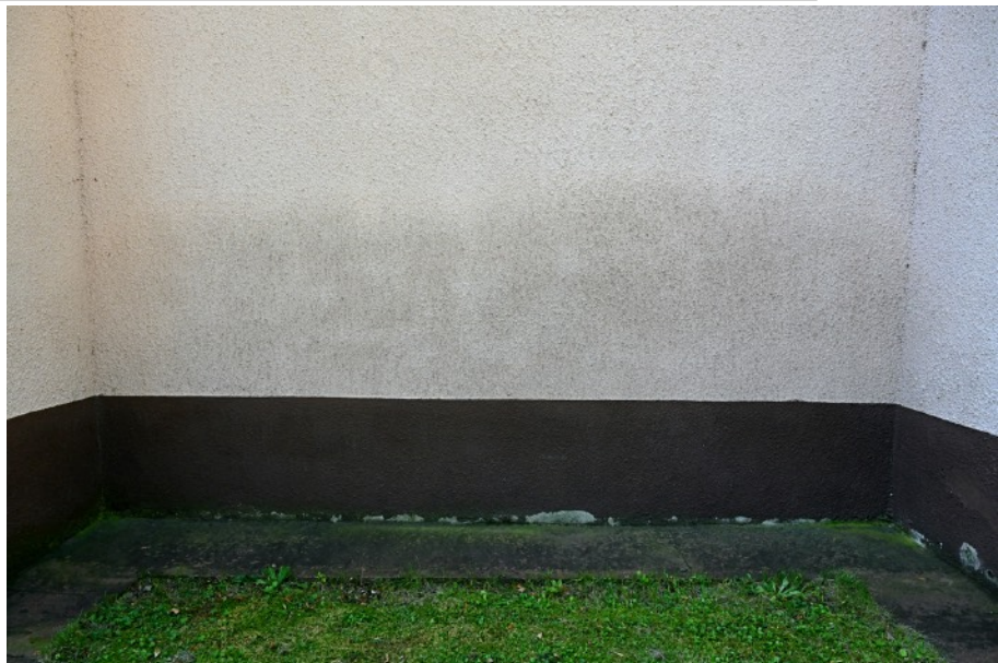
Fot. 3 Odcinek muru między skrajną przyporą nawy a kruchtą na elewacji południowej. Widoczne dość znaczne zawilgocenie ściany sięgające lokalnie do wysokości przekraczającej metr ponad poziom terenu.
