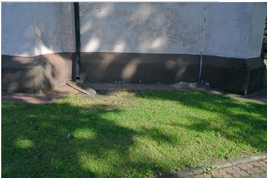
Fot. 1 Odcinek muru między skrajną przyporą nawy a pierwszą przyporą prezbiterium elewacji południowej. Widoczne zagłębienie terenowe będące źródłem zastoiska wody i związanego z tym zawilgocenia oraz porostami glonami dolnych fragmentów ściany.
