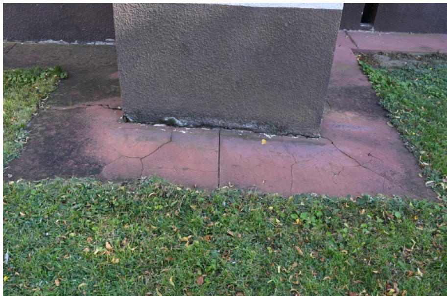
Fot. 7 Zastosowanie wtórnej, szczelnej betonowej opaski wokół kościoła powoduje, iż woda rozbryzgowa przyczynia się do dodatkowego zawilgoce- nia murów kościoła.
