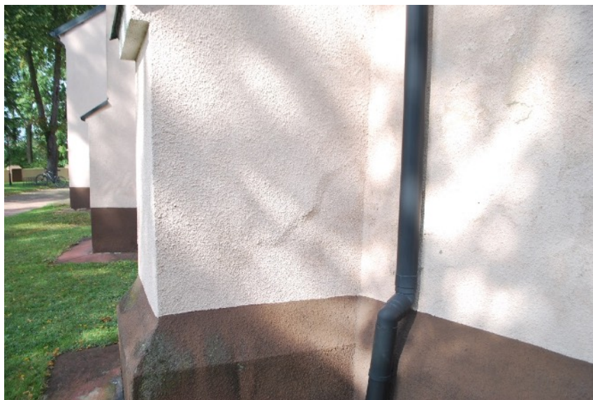
Fot. 6 Odspojona wierzchnia warstwa tynku
