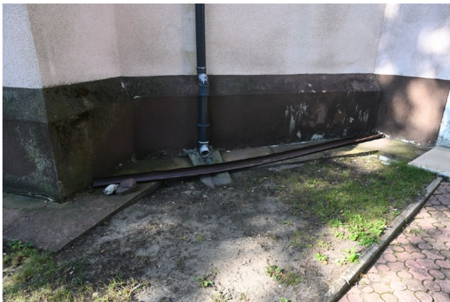
Fot. 2 Wschodni odcinek muru prezbiterium od strony północnej na styku z zakrystią. Zagłębienie terenowe powodujące okresowe zastoiska wody wiąże się z zawilgoceniem oraz porostania glonami dolnych fragmentów ściany.
