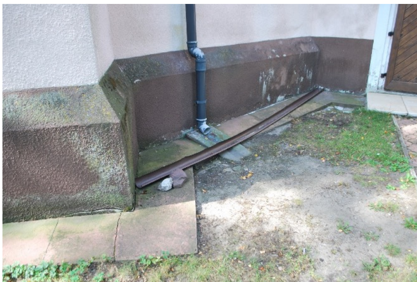
Fot. 10 Nieskuteczne odprowadzenie wody deszczowej i wyraźne oznaki zawilgocenia
