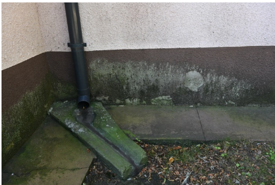
Fot. 4 Narożnik między nawą a prezbiterium od strony południowej. Odprowadzenie wody opadowej z dachu kościoła w narożnik między kruchtą a nawą spowodowało obniżenie gruntu i zaleganie wody przez długi okres czasu, co wpływa niekorzystnie na zawilgocenie muru.
