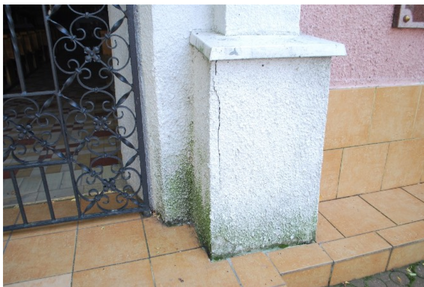
Fot. 8 Fragment elewacji frontowej - spękania i glony
