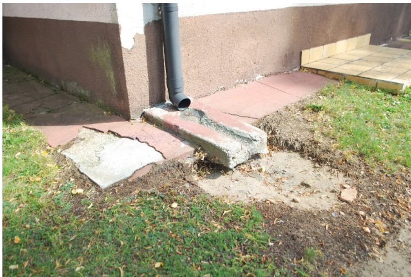
Fot. 9 Nieskuteczne odprowadzenie wody deszczowej
