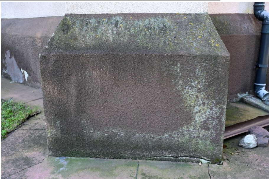
Fot. 5 Skrajna przypora północna przy prezbiterium. Utrzymujący się długotrwałe stan zawilgocenia powoduje szybki rozrost mikroorganizmów (głonów).
