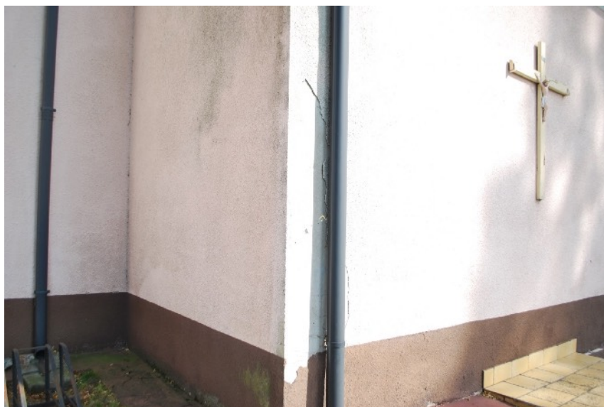
Fot. 7 Brak wierzchniej warstwy tynku w pobliżu rury spustowej
