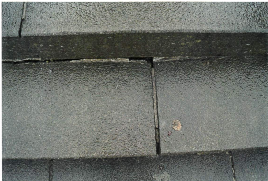
Fot. nr 15. Mauzoleum Legionistów w Brzustowie – Fragment schodów z wypłukanymi spoinami
