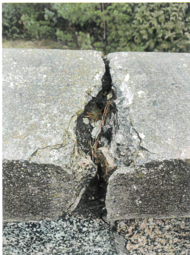
Fot. nr 10. Mauzoleum Legionistów w Brzustowie – fragment muru ogrodzenia. Widoczne jedno z wielu uszkodzeń i pęknięć nakrywy betonowej
