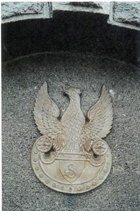
Fot. nr 17. Mauzoleum Legionistów w Brzustowie - Jeden z czterech legionowych orłów we wnętrzu pomnika. Widoczna korozja biologiczna.
