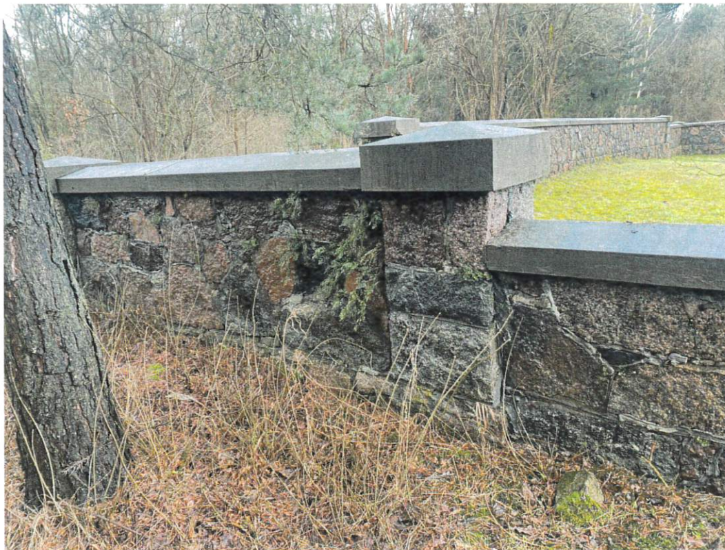
Fot. nr 9. Mauzoleum Legionistów w Brzustowie – fragment muru ogrodzenia. Widoczna korozja biologiczna
