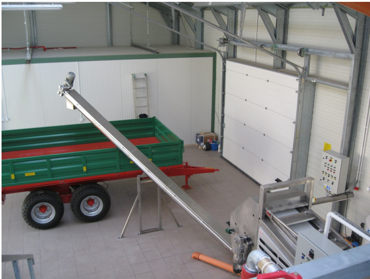
Hala odwadniania osadu
