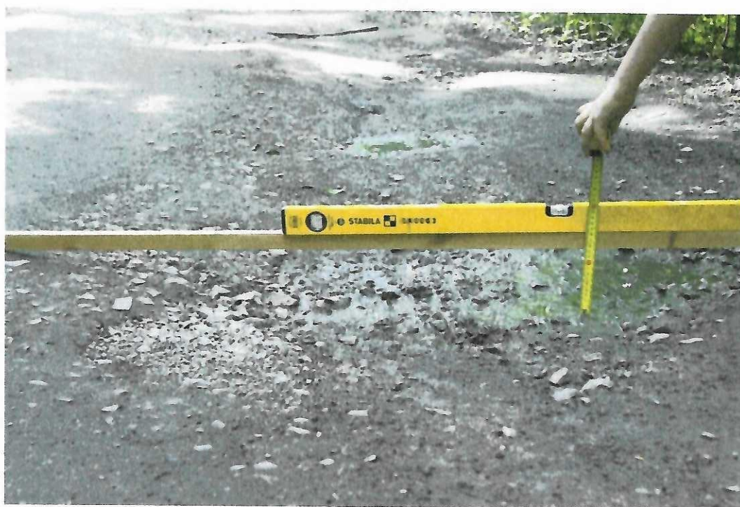
Fot. 4 i 5 Pomierzone dziury i doły mają już głębokość 14-15 cm
