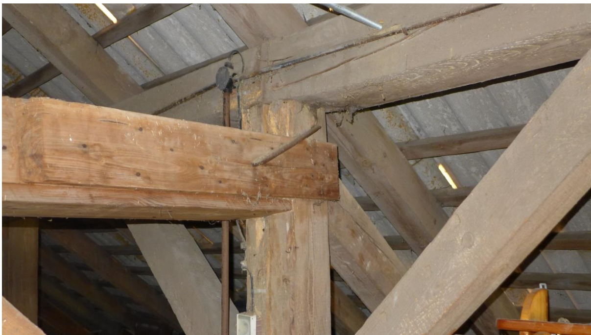
Fot. 5. Uszkodzony w górnej części przez owady słup C/9.
