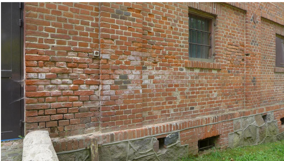
Fot. 22. Wysolenia w środkowej części ściany północnej obiektu.
