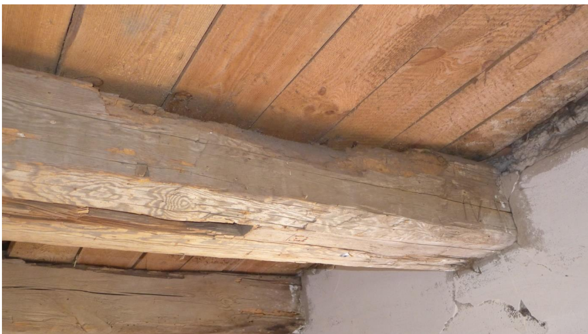
Fot. 16. Znaczne uszkodzenie belki stropowej 7/C-D stropu nad I-szym piętrem.
