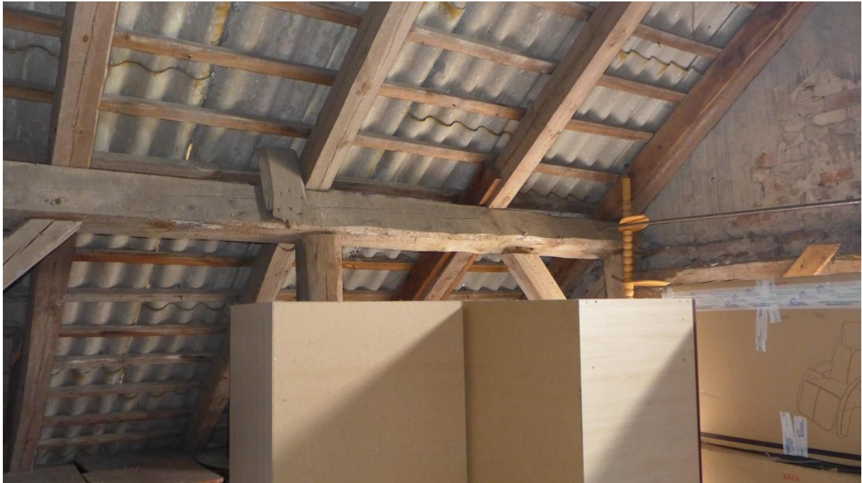
Fot. 9. Silnie przekoszona płatew B/21-25.
