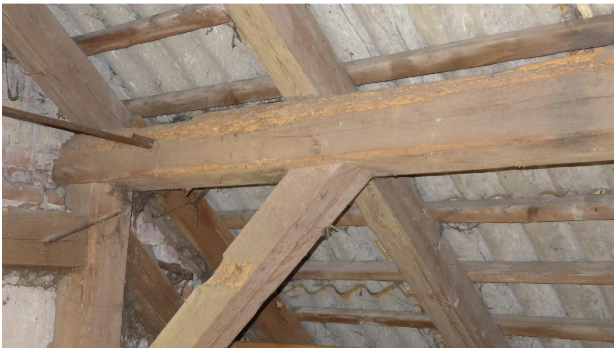
Fot. 3. Przekoszona i uszkodzona przez owady płatew B/1-5. Ubytki korozyjne w mieczu około 20%.
