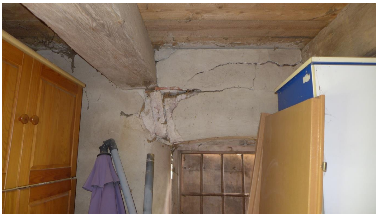
Fot. 20. Silne uszkodzenie nadproża okiennego na parterze w części zachodniej obiektu.
