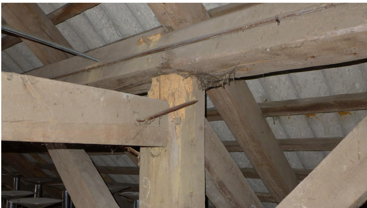
Fot. 6. Uszkodzony w górnej części przez owady (50%) słup C/17.
