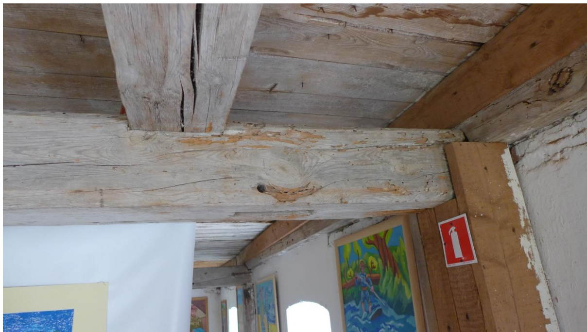
Fot. 19. Przykład uszkodzenia przez owady elementów konstrukcji nośnej stropu nad I-szym piętrem od strony wschodniej.
