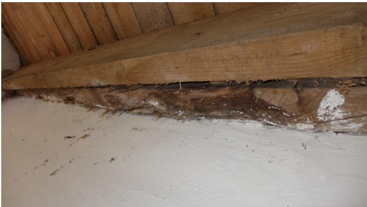
Fot. 15. Silnie zawilgocona i porażona przez grzyb domowy biały skrajna od strony zachodniej belka stropu nad I-szym piętrem.
