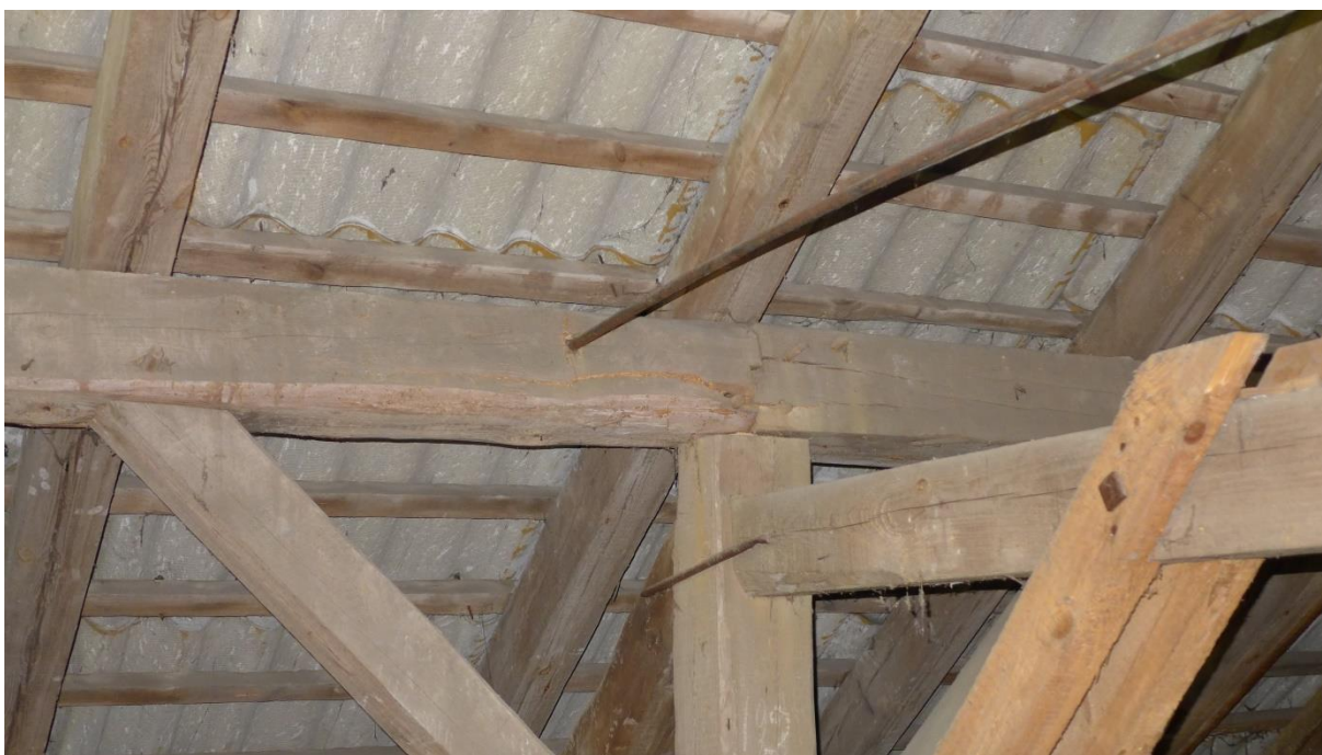
Fot. 4. Niebezpieczne pęknięcie płatwi B/5-9 w pobliżu słupa B/9.
