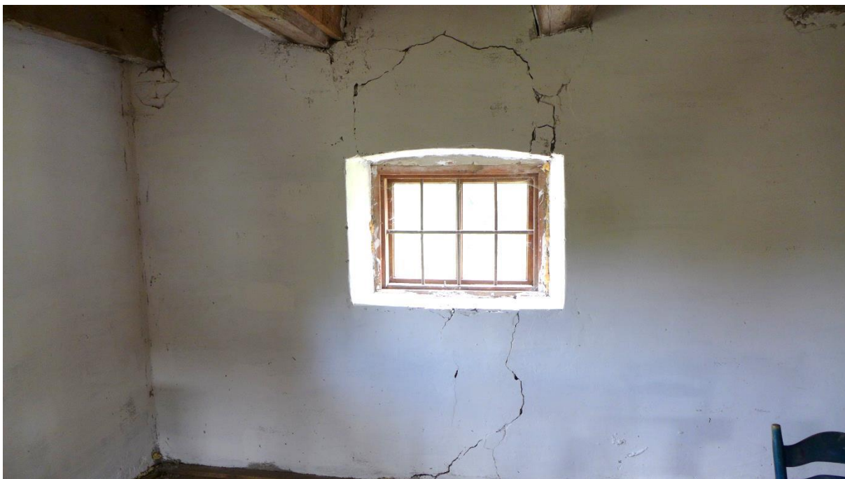
Fot. 13. Silne pęknięcie nadproża okiennego i części podokiennej w narożniku północno – zachodnim na I-szym piętrze.
