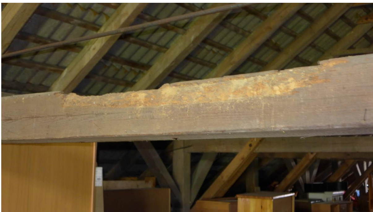
Fot. 2. Uszkodzony przez owady (50%) element rozpory w osi 5.
