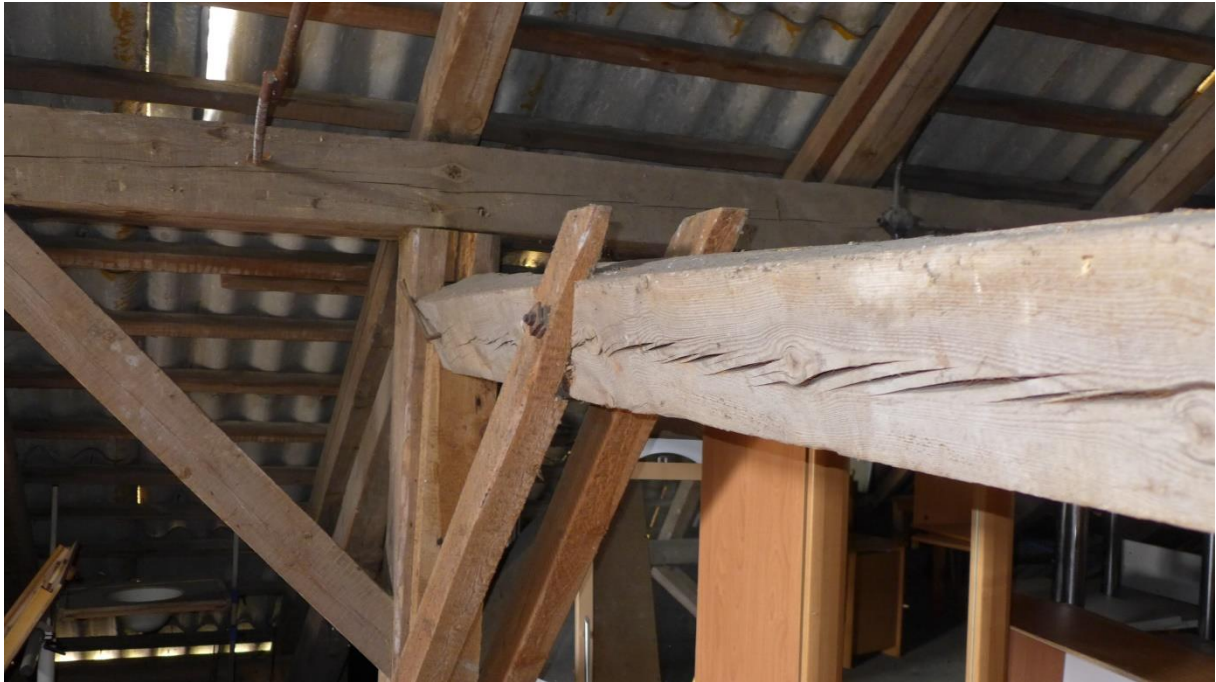
Fot. 7. Silnie skrzywiona rozpora dźwigara w osi 15.
