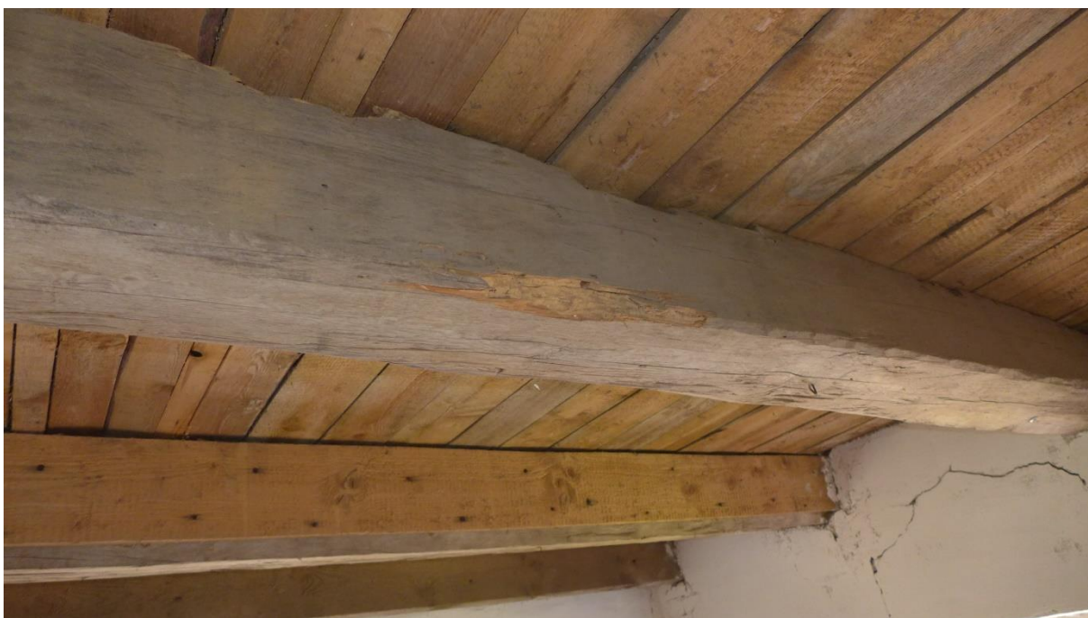
Fot. 14. Przykładowe uszkodzenie przez owady belki w osi 3 w pobliżu narożnika północno – zachodniego.
