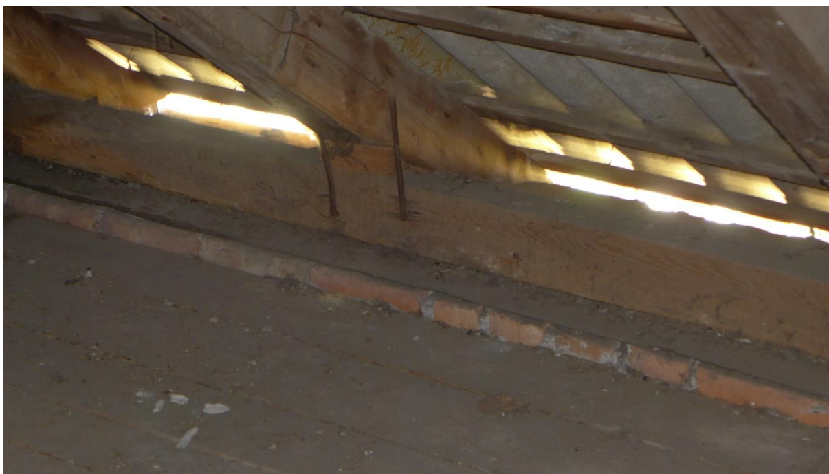
Fot. 12. Oparcie krokwi 16/B-D na murlacie – brak śrub kotwiących murlatę do ściany.
