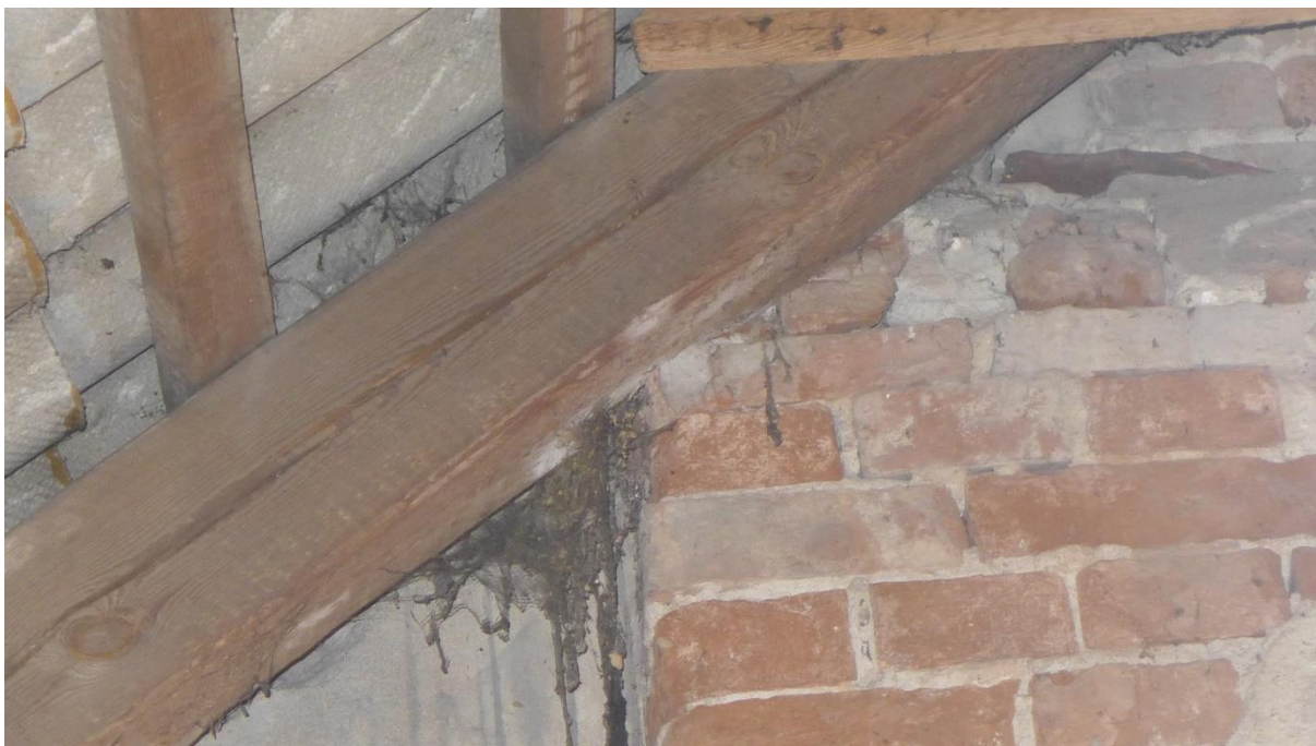
Fot. 11. Oparcie krokwi w osi 25 na występie ściany szczytowej od strony wschodniej, powstałe na skutek niewłaściwego zakotwienia murlat.
