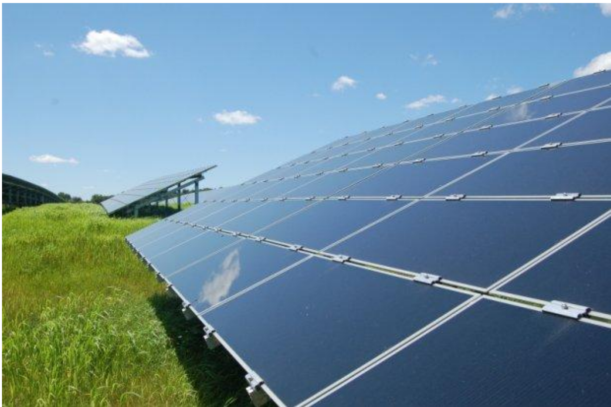
Rys. Przykład zainstalowanej instalacji fotowoltaicznej na gruncie który jest nadal użytkowany rolniczo.
