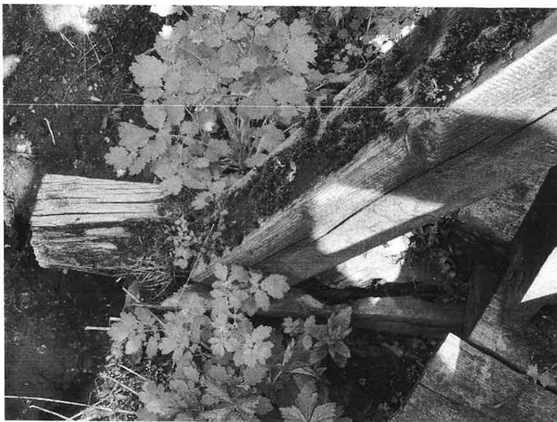
Fot. 11. Spękany, z ubytkami, pokryty roślinnością wspornik balustrady
