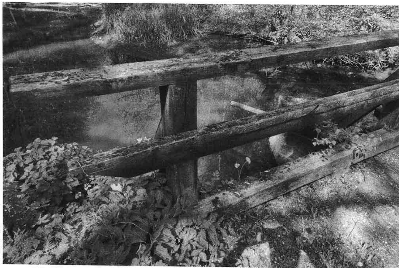
Fot. 8. Zanieczyszczone i skorodowane balustrady na pomoście
