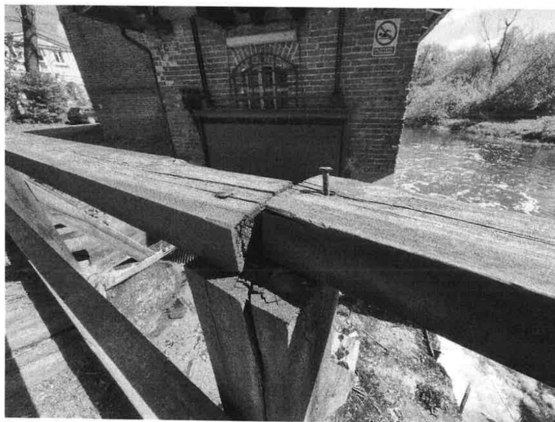
Fot. 16. Obluzowany łącznik poręczy ze słupkiem balustrady
