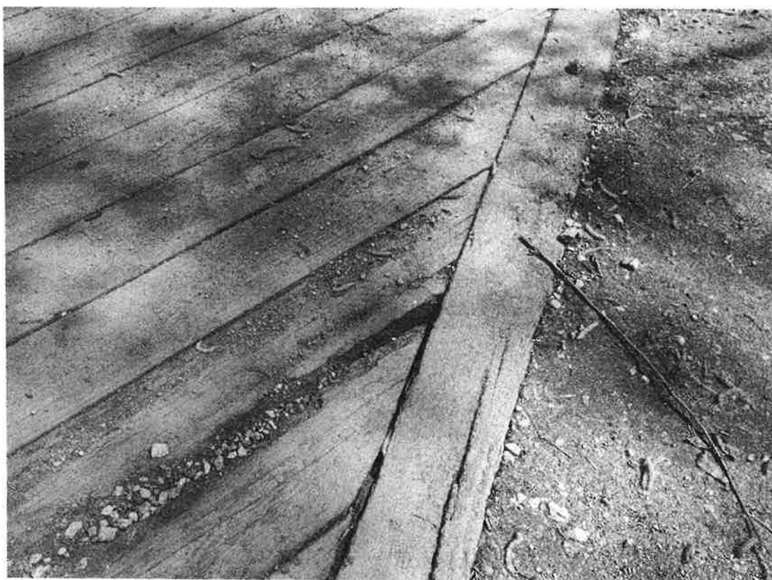
Fot. 6. Ubytek nawierzchni na dojeździe od strony drogi powiatowej nr 3726W
