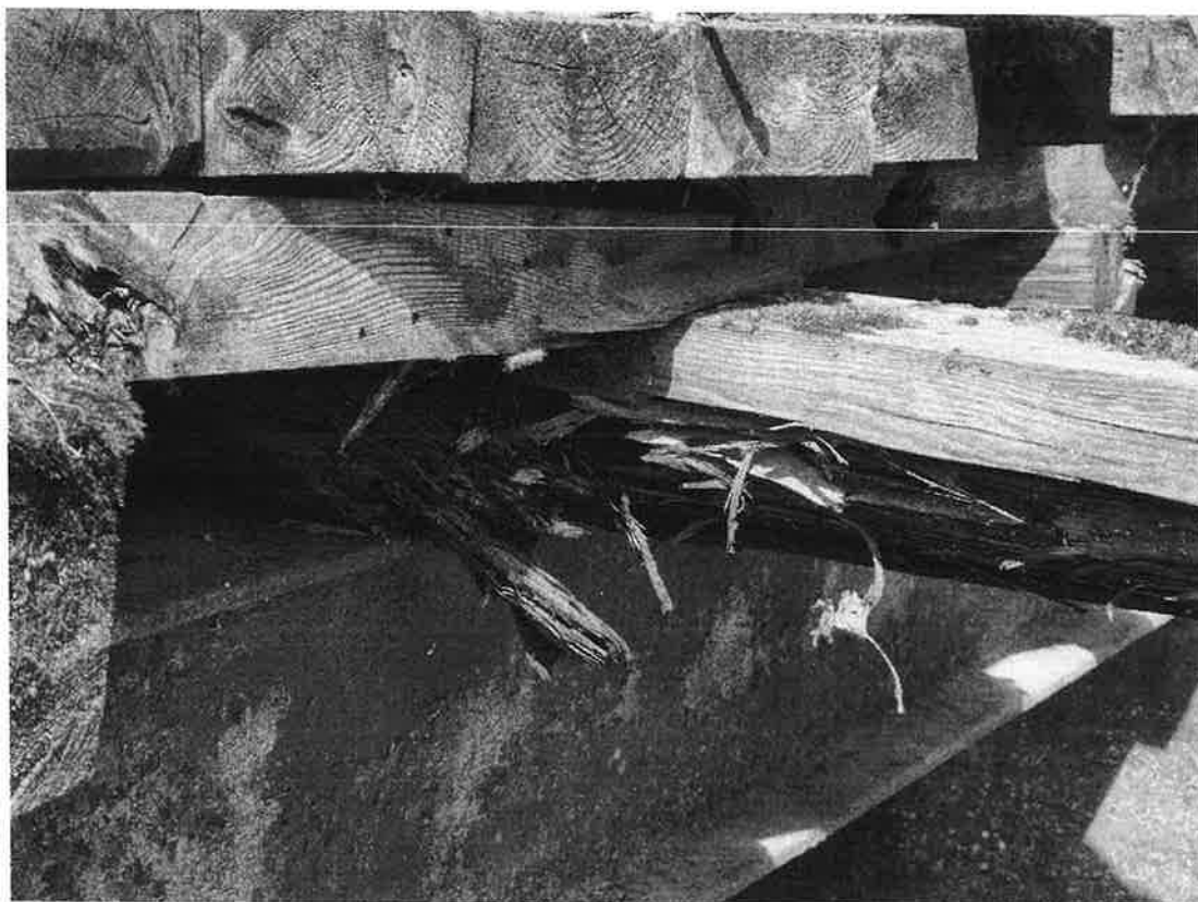
Fot. 35. Zgniłe poprzecznice drewniane
