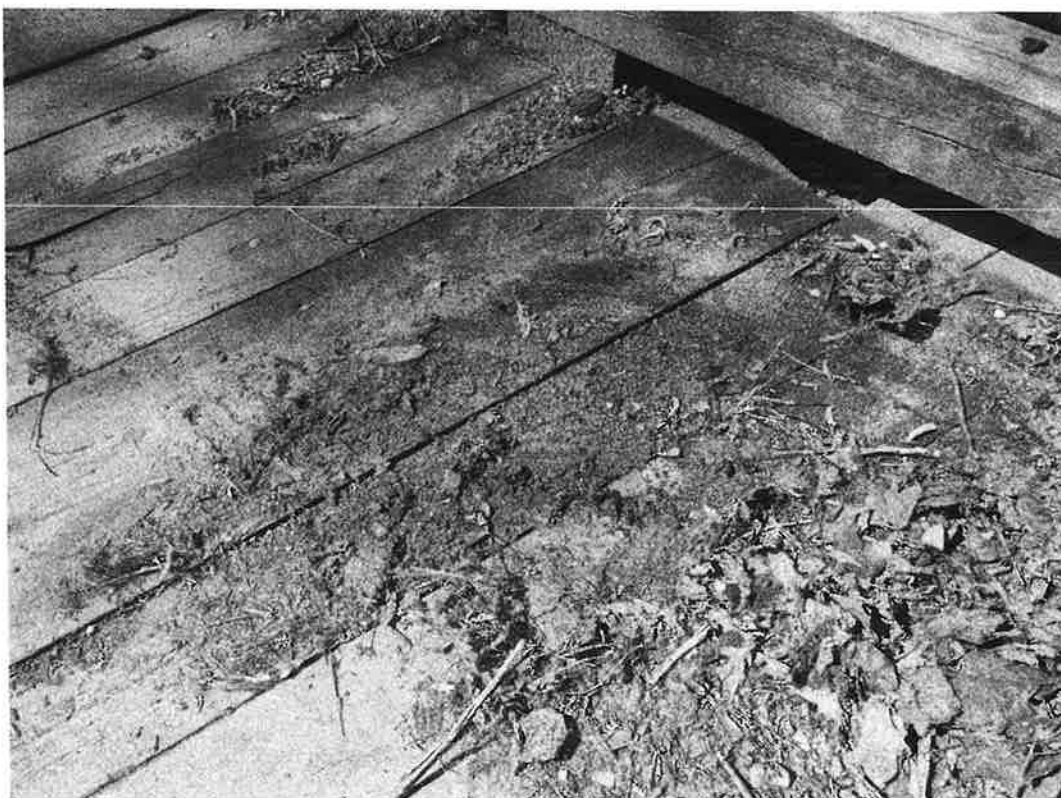
Fot. 5. Zanieczyszczenia organiczne pomostu utrudniające szybkie odprowadzenie wody z nawierzchni jezdni
