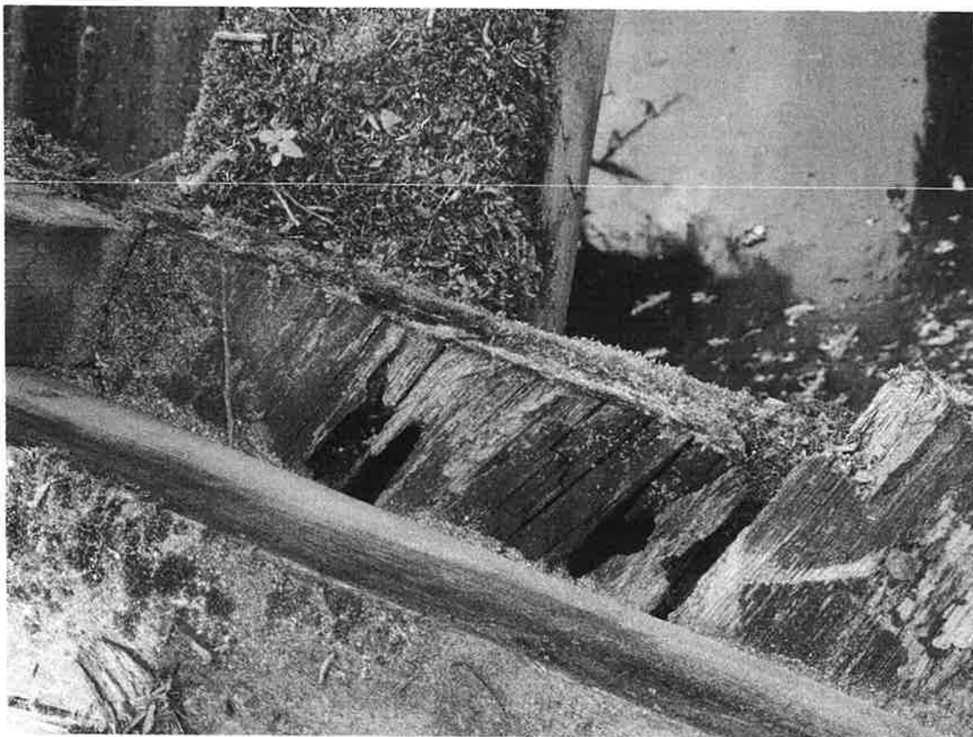
Fot. 13. Skorodowane drewniane deski pomostu spowodowane starzeniem się materiału i brakiem zabezpieczeń antykorozyjnych
