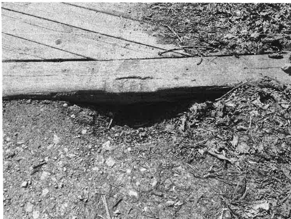
Fot. 1. Ubytek nawierzchni na dojeździe o wymiarze ponad 15 cm, na styku z pomostem od strony elektrowni, spowodowany wypłukaniem kruszywa i gruntu
