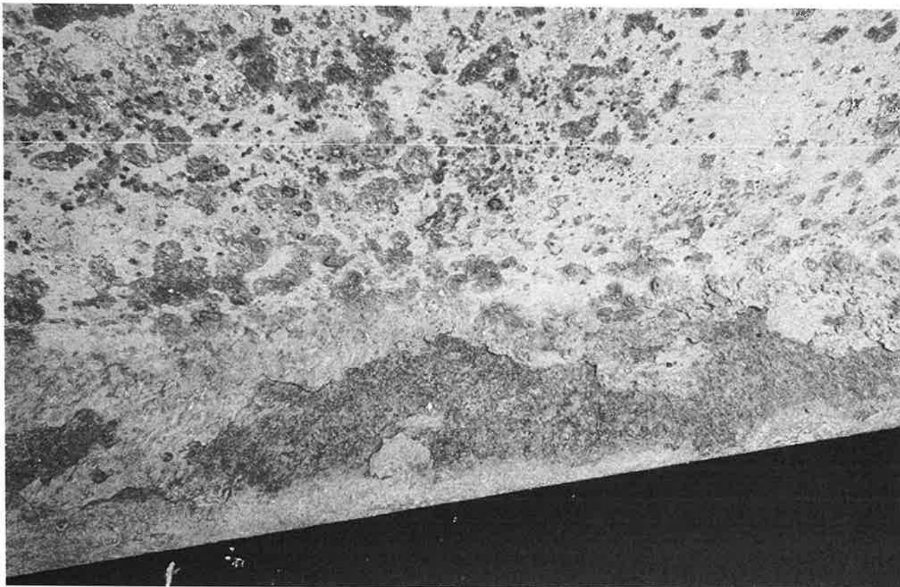
Fot. 27. Powierzchniowy brak powłoki antykorozyjnej i rozległe ubytki materiałowe
