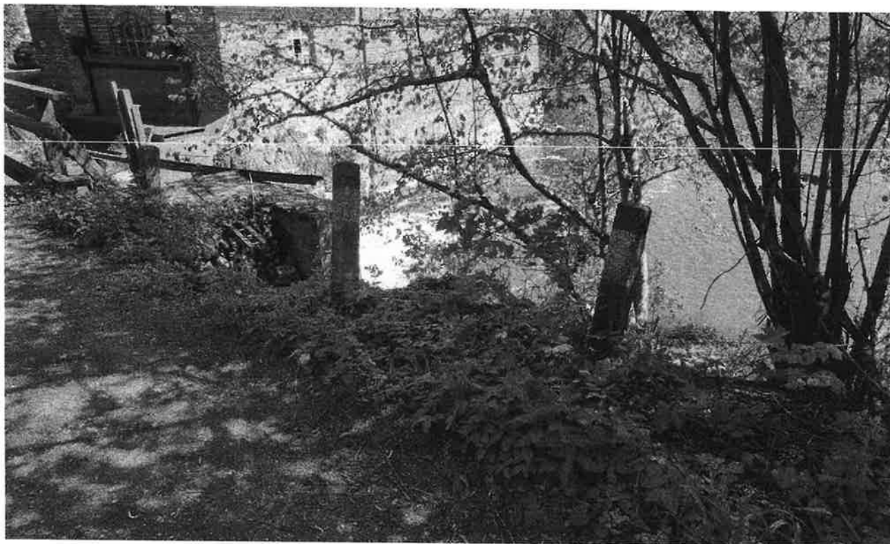
Fot. 7. Zniszczone bariery na dojeździe od strony DP nr 3726W
