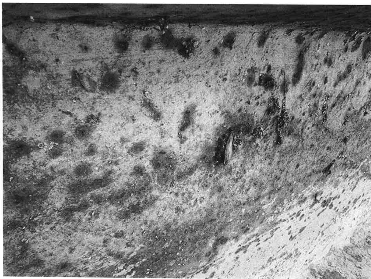
Fot. 26. Zaawansowane ubytki materiału dźwigara
