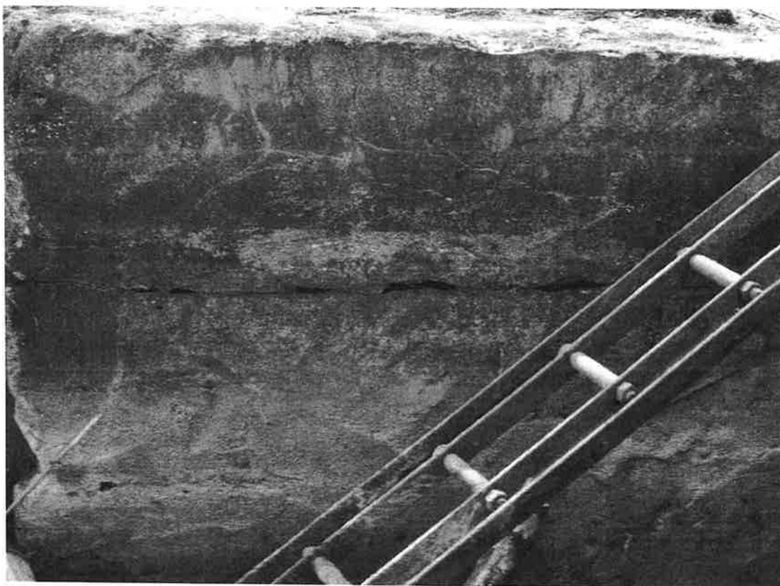
Fot. 38. Spękania, rysy przyczółka od strony drogi powiatowej
