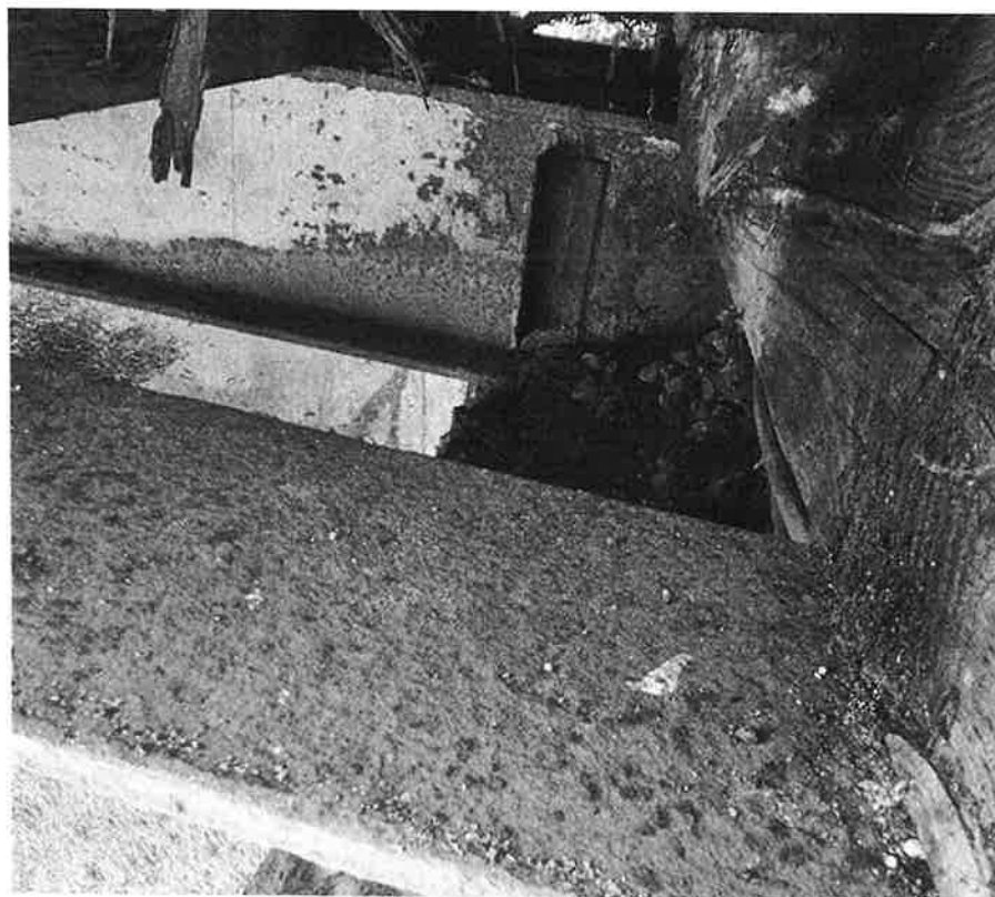
Fot. 32. Zanieczyszczona nisza podłożyskowa przyczółka od strony elektrowni
