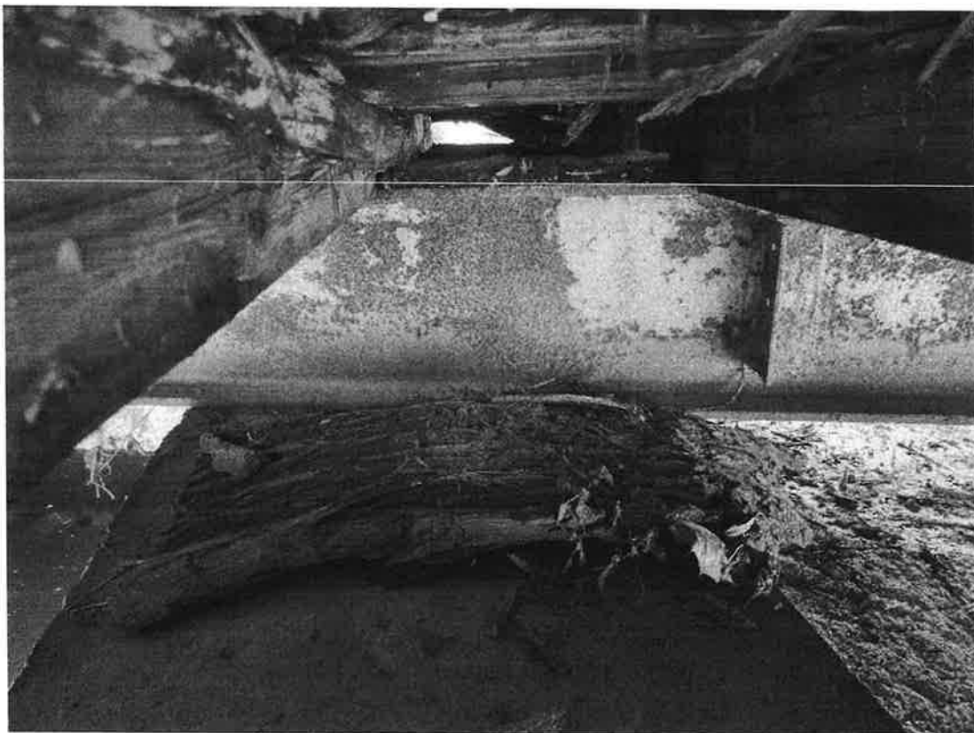
Fot. 37. Zanieczyszczona przestrzeń podłożyskowa filara nurtowego
