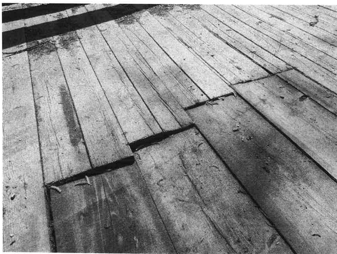
Fot. 4. Zapadanie się drewnianych desek nawierzchni pomostu spowodowane usterką łączeń
