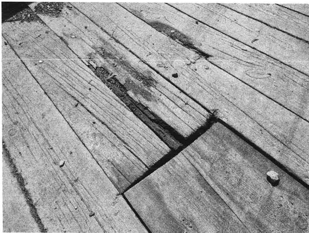
Fot. 3. Zapadanie się nawierzchni pomostu, pęknięcia i ubytki spowodowane starzeniem się materiału i eksploatacją obiektu
