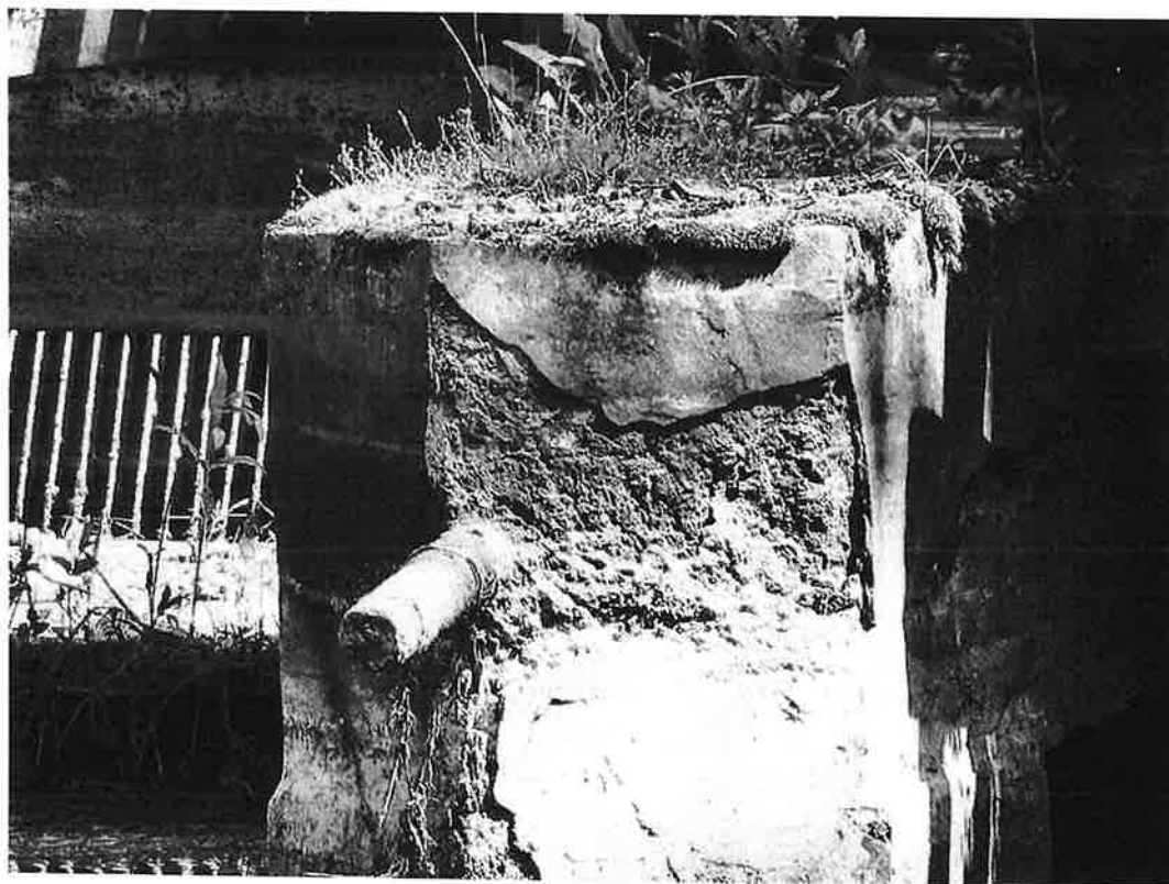
Fot. 20. Ubytki betonu filara
