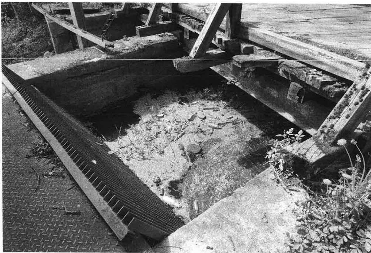
Fot. 29. Zanieczyszczona przestrzeń pod mostem na wpływie do kraty elektrowni wodnej
