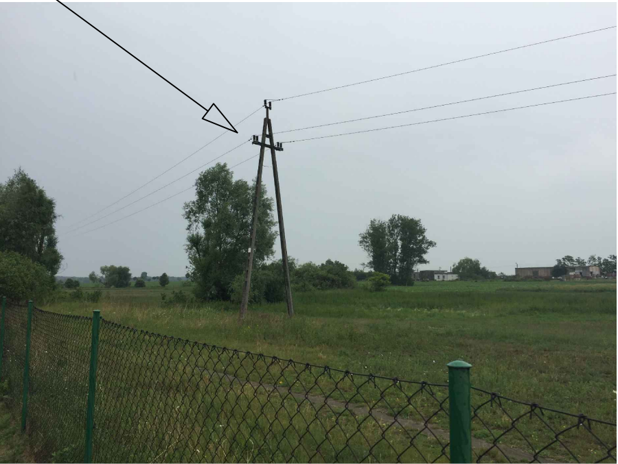
WIDOK NA ISTNIEJĄCĄ, NAPOWIETRZNĄ SIEĆ ELEKTROENERGET. 15kV
