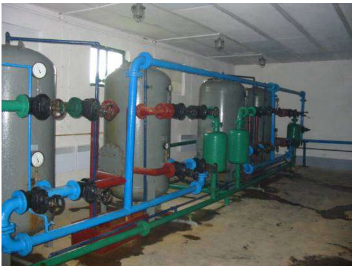
Fot. 6 Instalacja do ujmowania i uzdatniania wody pitnej w ujęciu w Kościeszkach
