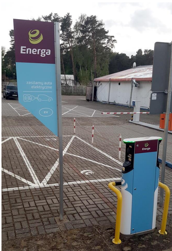
Fot. Ładowarka do pojazdów firmy Energa
