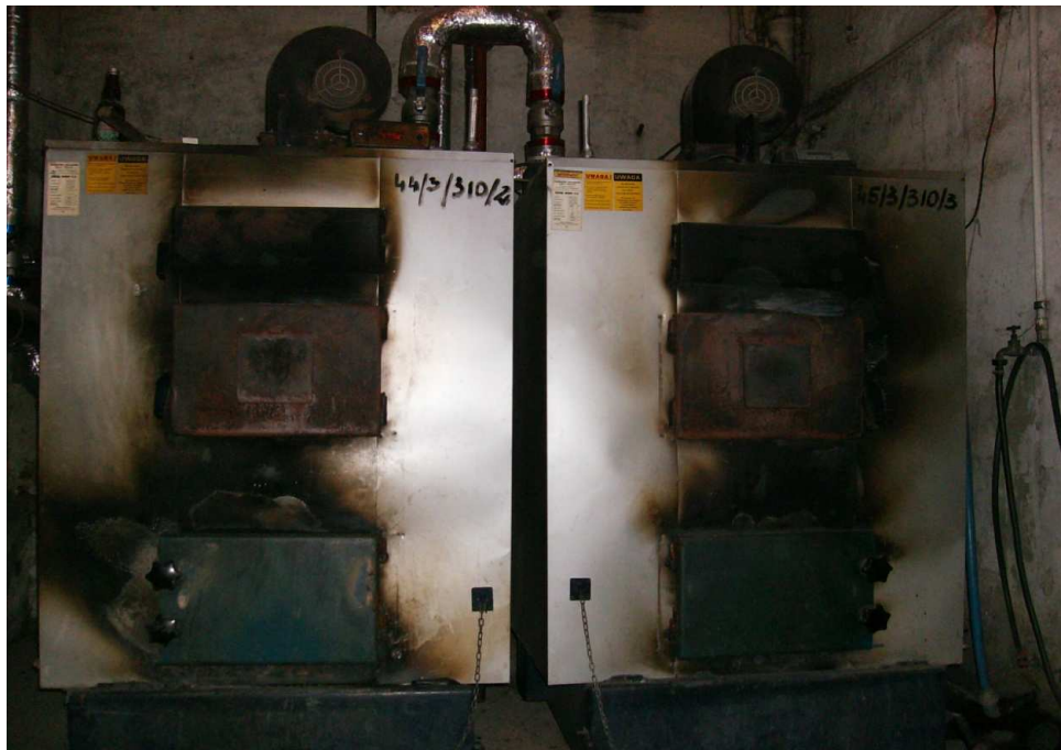
Kotłownia węglowa o mocy 160 kW w budynku Liceum Ogólnokształcącego 2 kotły węglowe UKS-N o mocy 60 kW każdy ( z 2009 roku ). Stan dobry.
