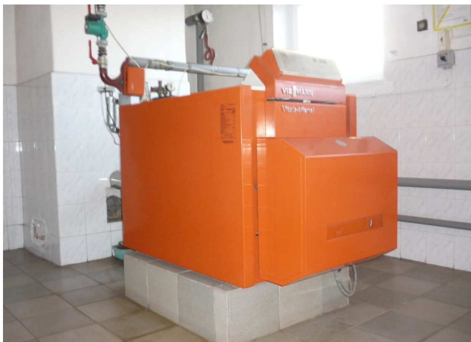
Kotłownia o mocy 50 kW opłana olejem opałowym lekkim w budynku Nadleśnictwa Żłoczew
