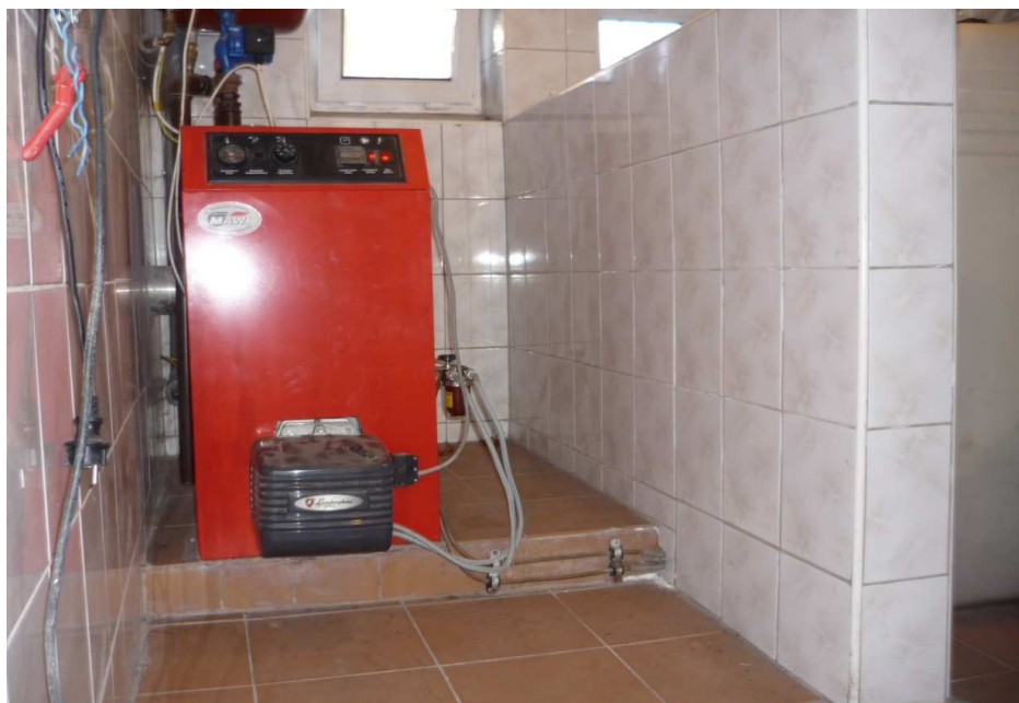
Kotłownia o mocy 30 kW opłana olejem opałowym lekkim w budynku Policji. Stan bardzo dobry.
