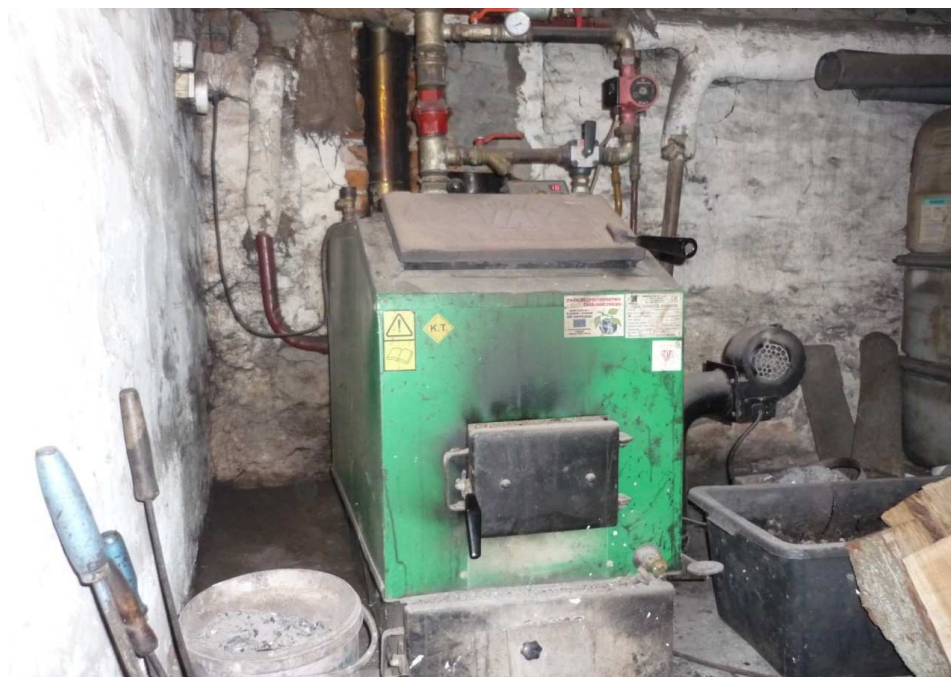
Kotłownia węglowa w budynku przy ulicy Parkowej 16. W budynku zamontowano 2 identyczne kotłownie o mocy 20 kW każda. Stan średni.
