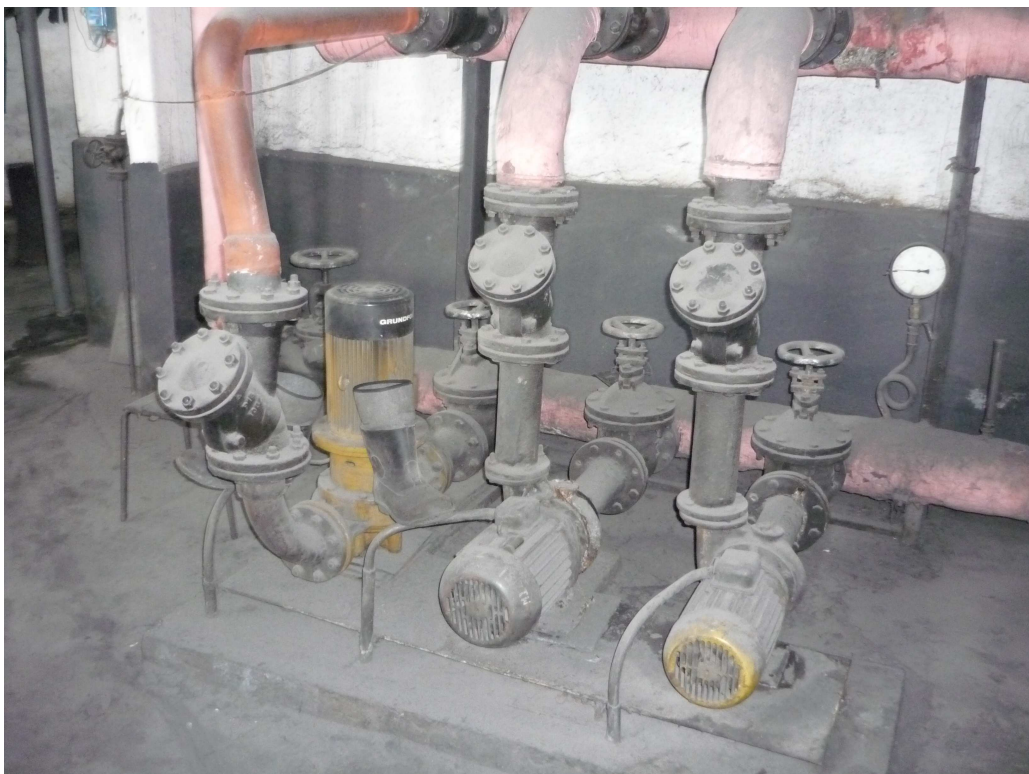
Pompy obiegowe co
