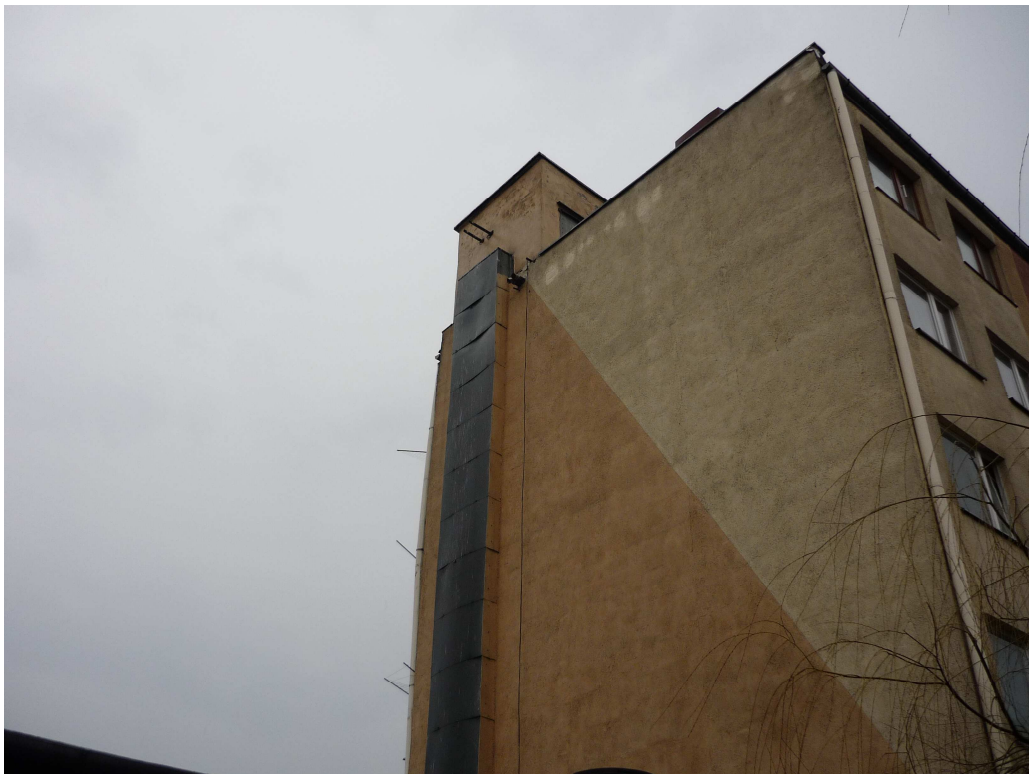
Otwarte naczynie wzbiornicze nad dachem sąsiedniego budynku
