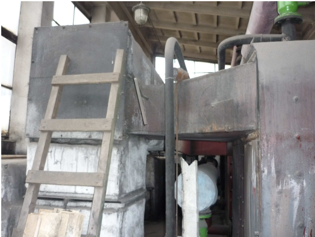
Czopuch kotła i kolektor odprowadzający spaliny
