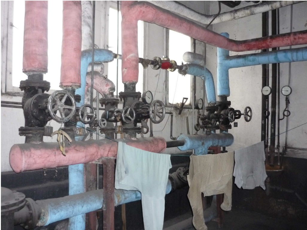
Obiegi grzewcze i armatura
