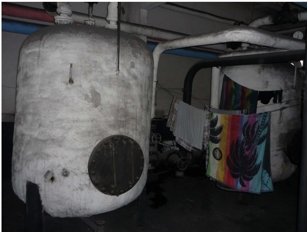
Zasobniki ciepłej wody użytkowej
