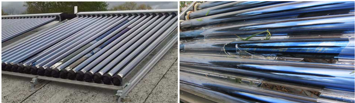
Fot.5: Gradobicie – kolektor rurowo próżniowy
