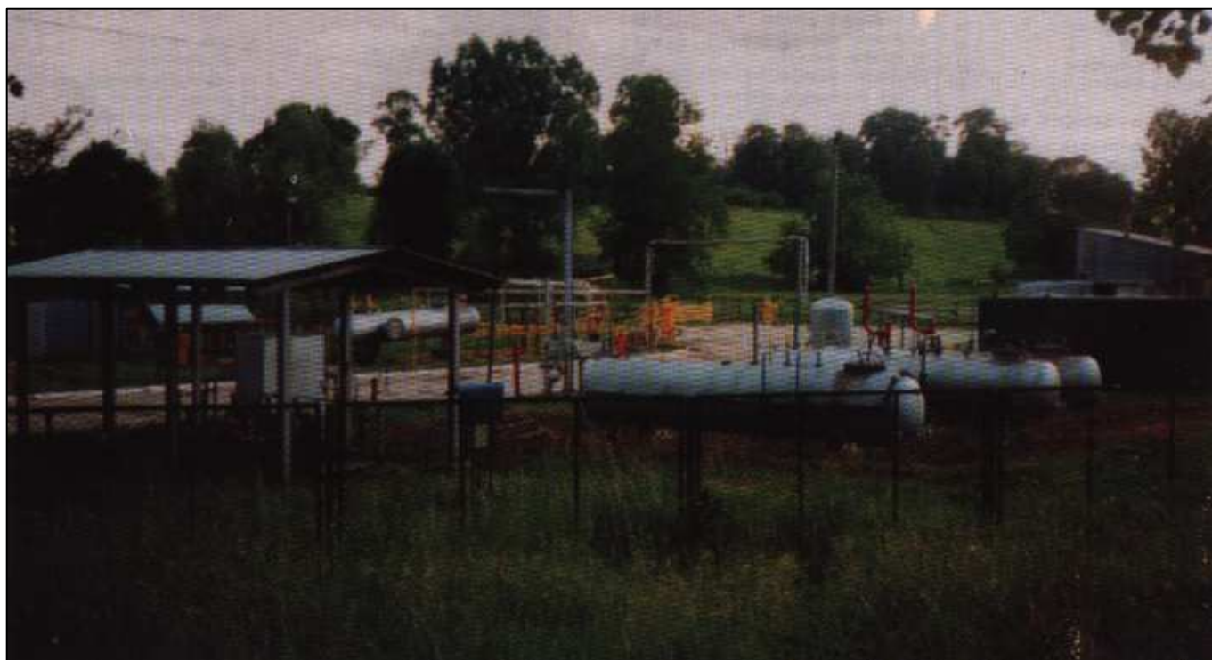
Stacja gazowa w Rudniku
