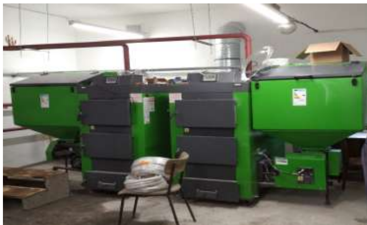
Kotłownia - Dwa piece na pellet firmy SAS o łącznej mocy 144 kW.
