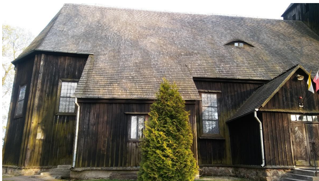
Fot.2. Korpus świątyni wraz z dachem krytym gontem – widoczne zniszczenia w postaci korozji mikrobiologicznej (mchy, glony) oraz zawilgoceń
