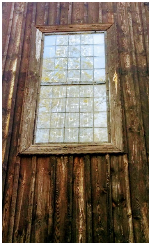
Fot.6. Widok na niewielkie spękania i przetarcia
