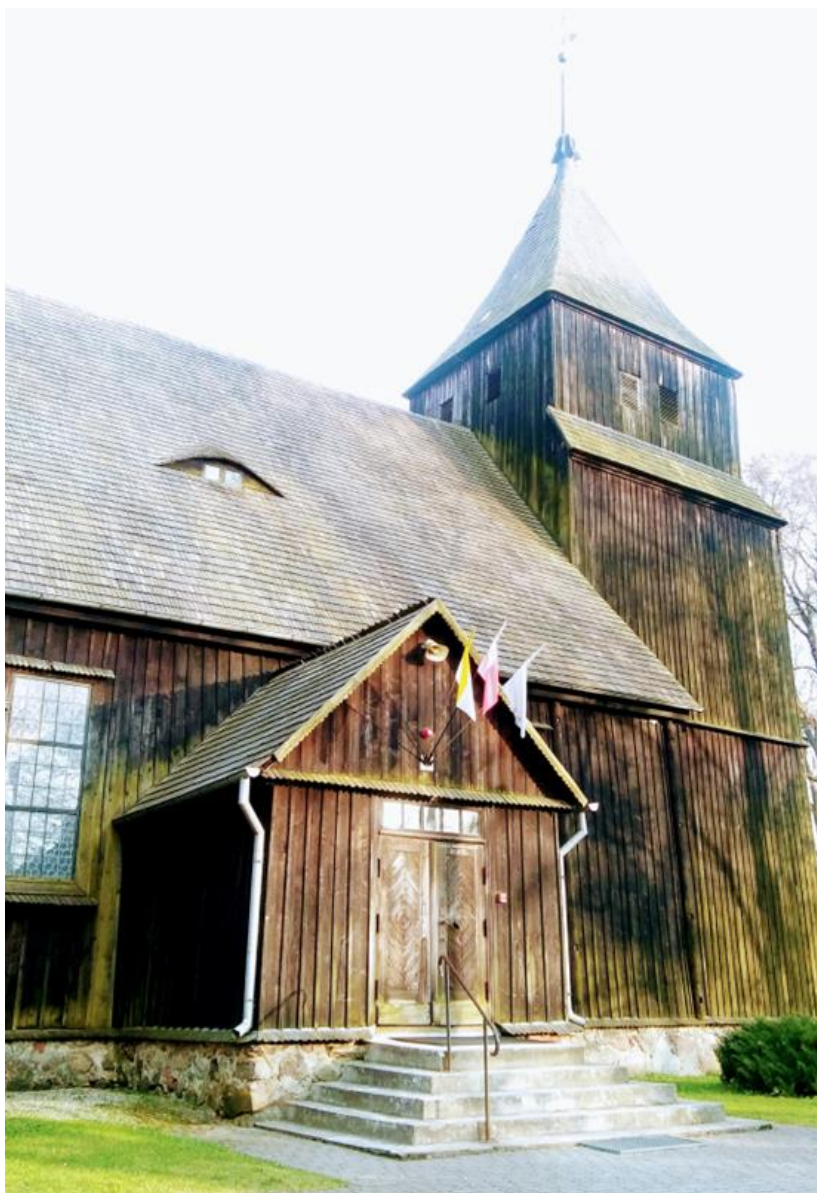
Fot.3. Widoczne zniszczenia obiektu – zawilgocenia oraz korozja mikrobiologiczna
