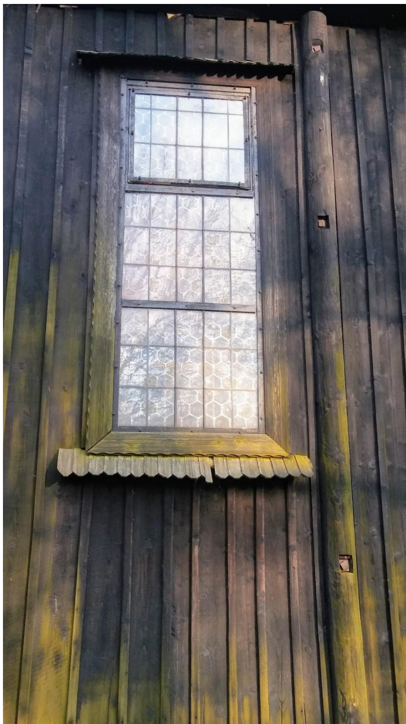
Fot.5. Widoczne zawilgocenia, korozja mikrobiologiczna, spękania i niewielkie ubytki.
