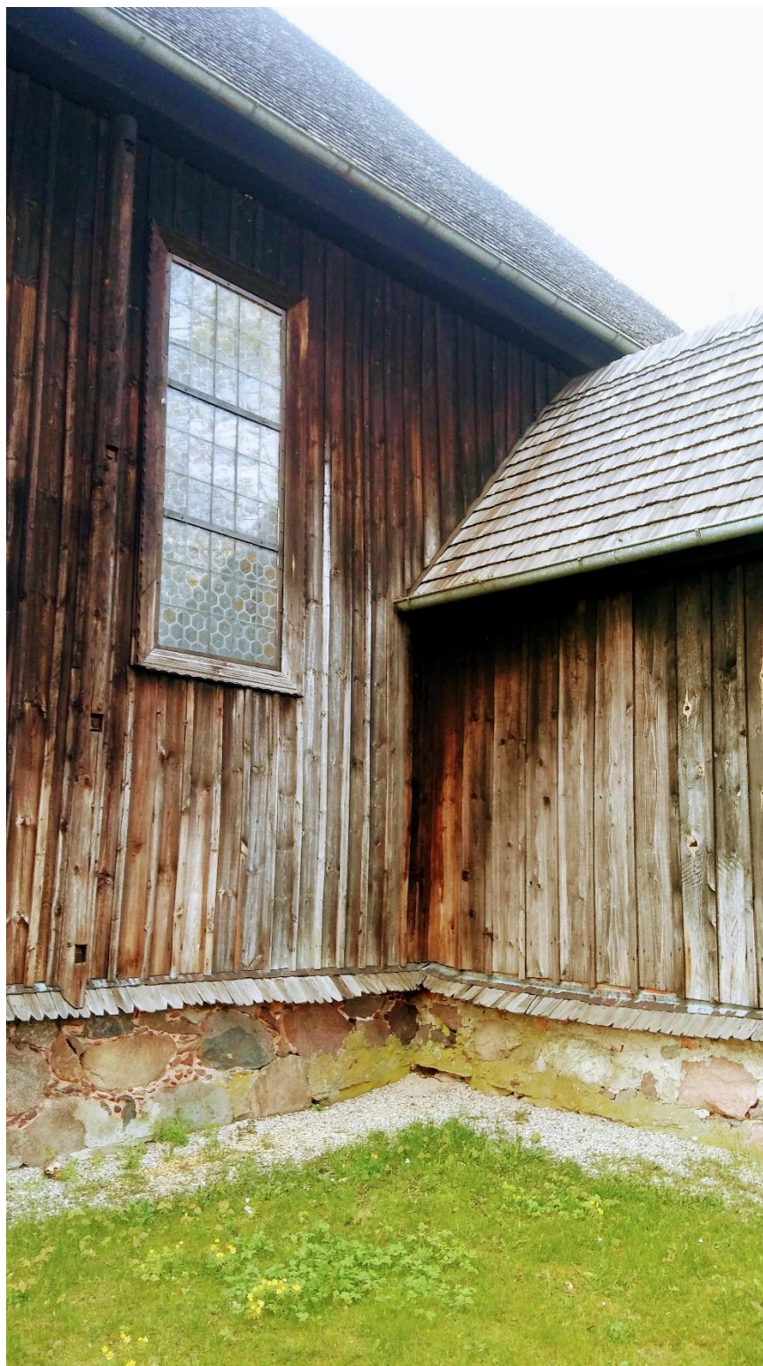
Fot.4. Widoczne mocne zawilgocenia na drewnianej elewacji, a także spękania zawilgocenia oraz korozja mikrobiologiczna na cokole świątyni
