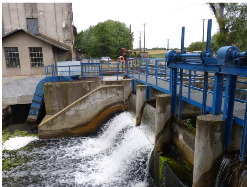
Fot. 6 Elektrownia wodna na rzece Ledze w Starostach
