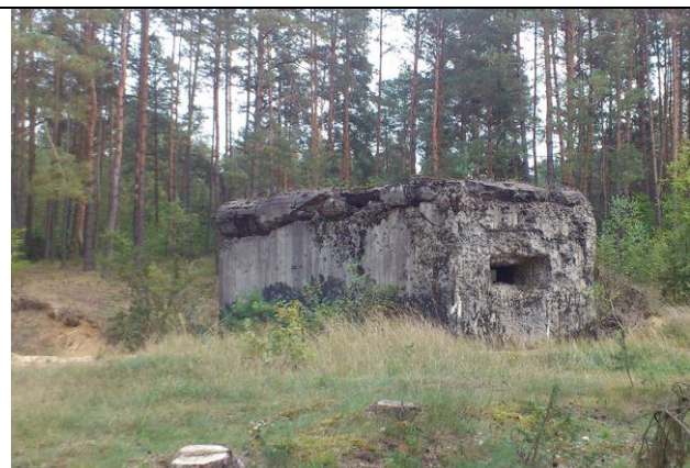
Nr 11 - Zniszczony schron do ognia bocznego
